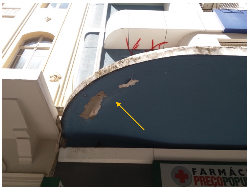
Figura 32. Marquise com deterioração de pintura (AUTORES, 2018)
