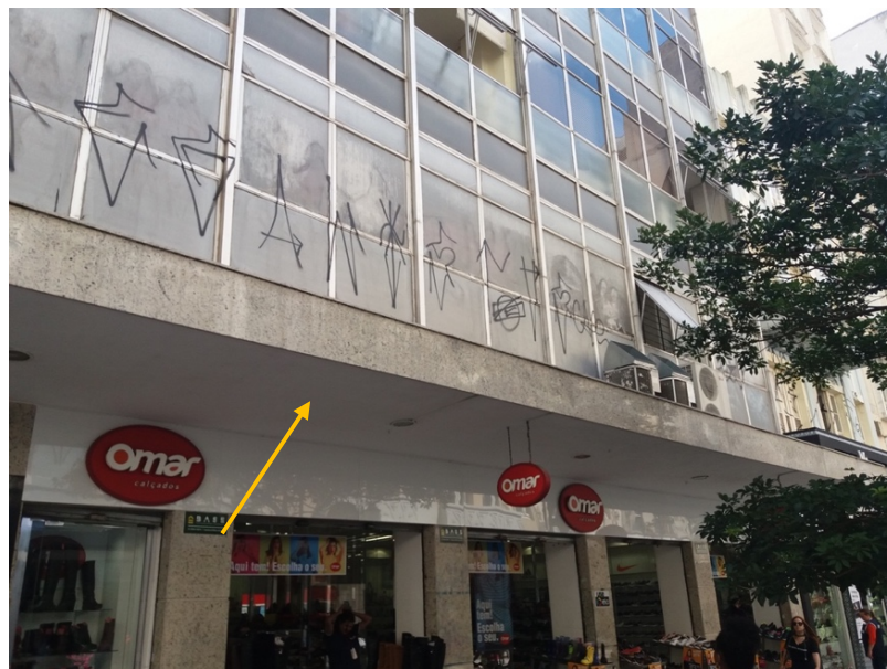
Figura 42. Marquises revestidas com mármore (AUTORES, 2018)
