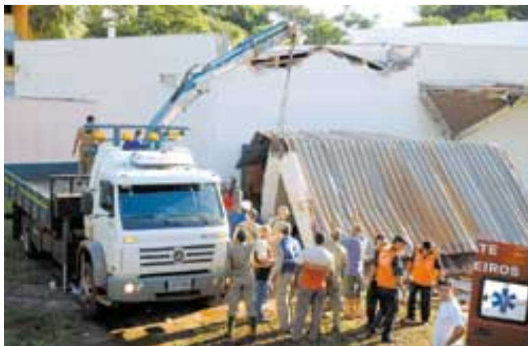
Figura 17. Marquise desabou em Londrina (GAZETA DO POVO, 2006)
