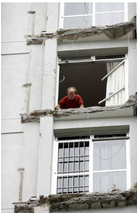
Figura 18. Marquise desabou em Maringá (GAZETA DO POVO, 2008)
