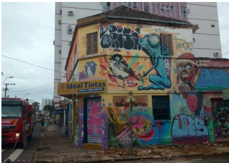
Figura 19. Marquise desabou em São Leopoldo (JORNAL NH, 2016)
