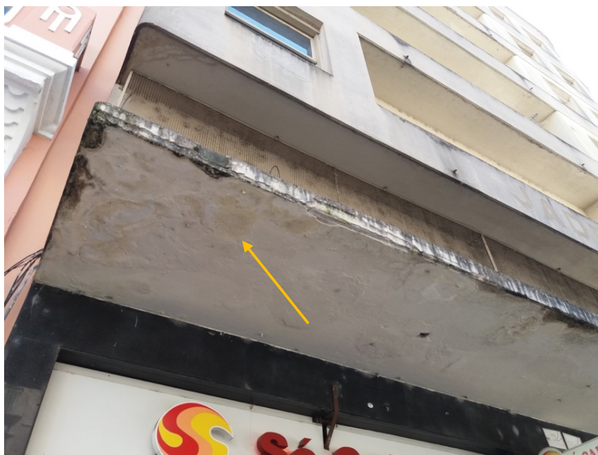
Figura 30. Marquise com presença de infiltrações (AUTORES, 2018)
