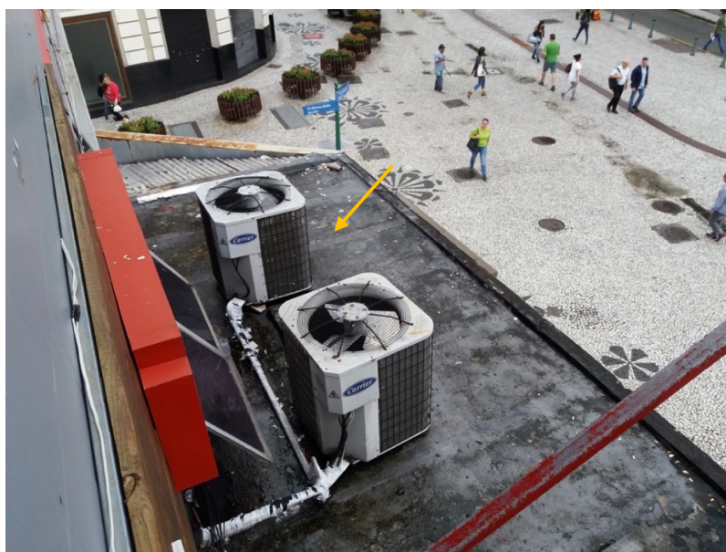
Figura 37. Condensadores de ar apoiados na marquise (AUTORES, 2018)
