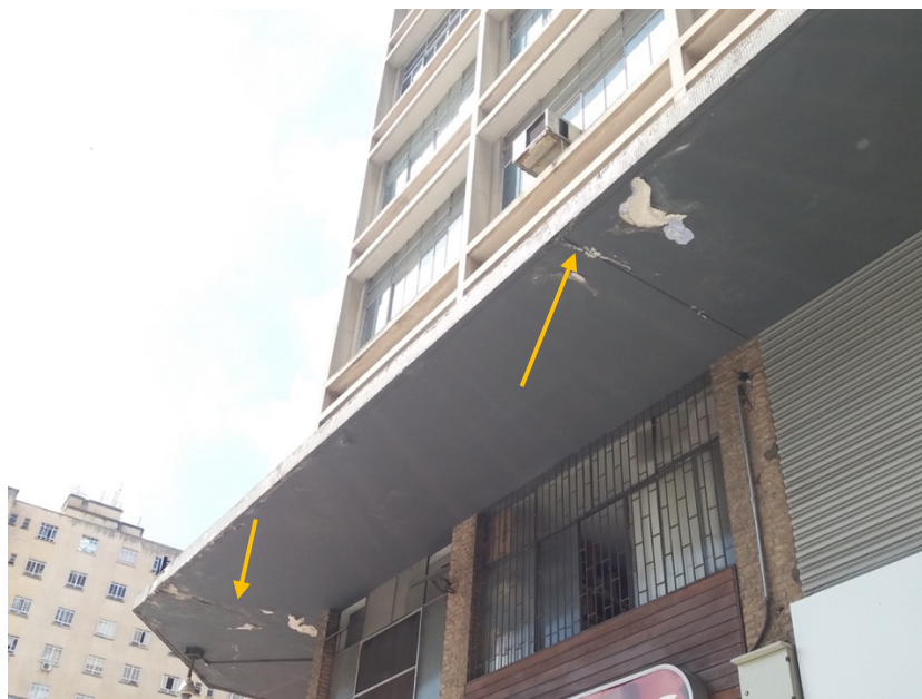
Figura 31. Marquise com deterioração de pintura (Autores, 2018)
