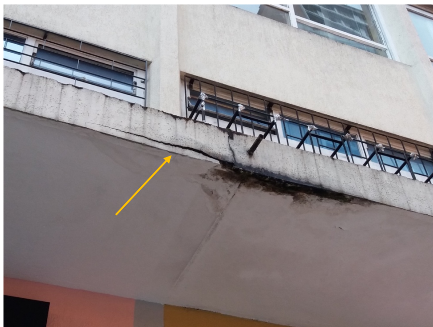
Figura 35. Marquise com deslocamento (AUTORES, 2018)
