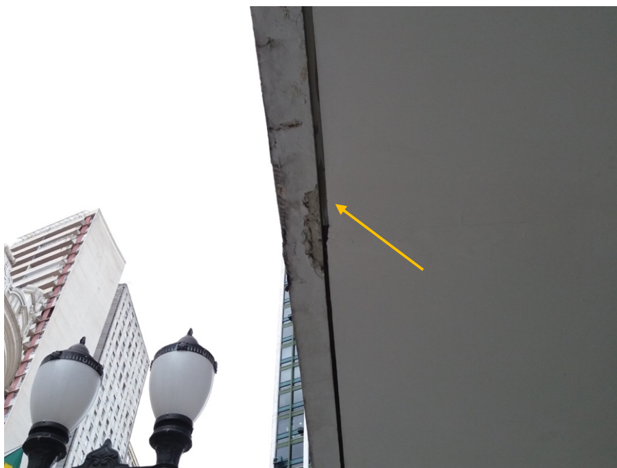
Figura 34. Marquise com deslocamento (AUTORES, 2018)
