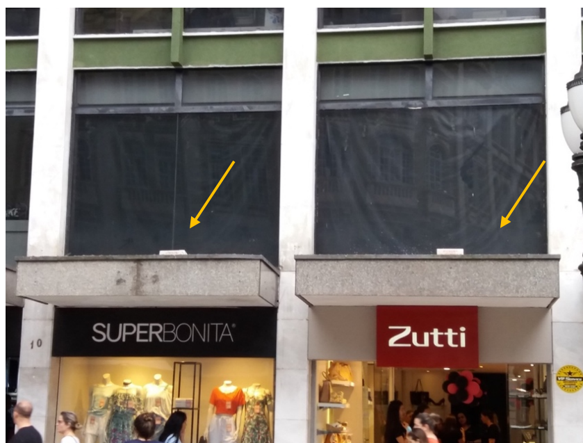
Figura 41. Marquises revestidas com mármore (AUTORES, 2018)
