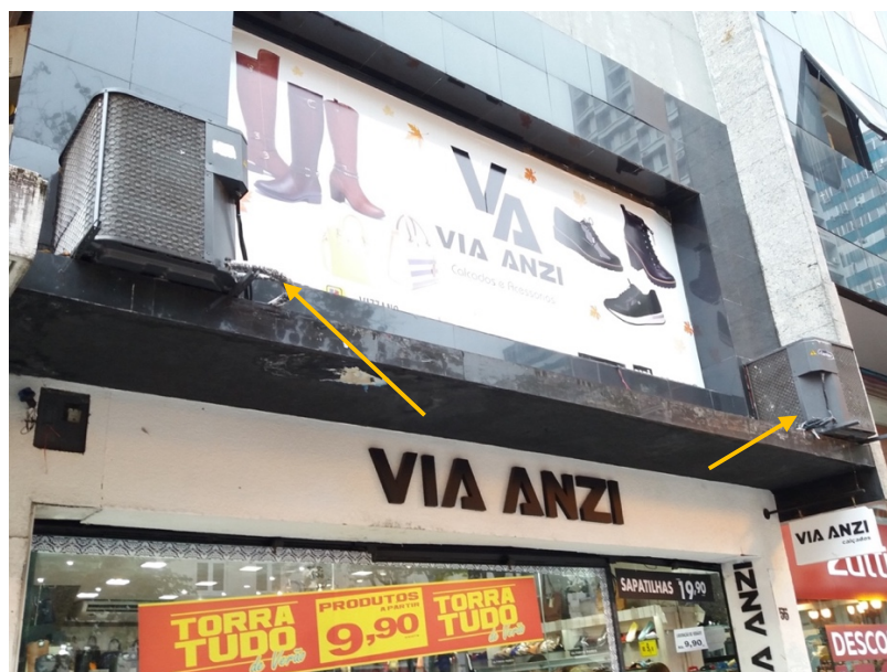
Figura 36. Condensadores de ar apoiados na marquise (AUTORES, 2018)
