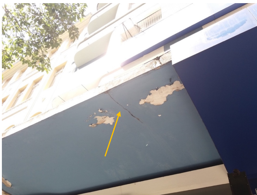
Figura 33. Marquise com presença de fissura (AUTORES, 2018)
