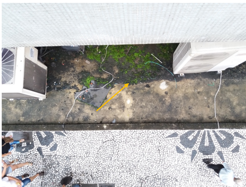
Figura 28. Marquise com presença de fungo e bolor (AUTORES, 2018)
