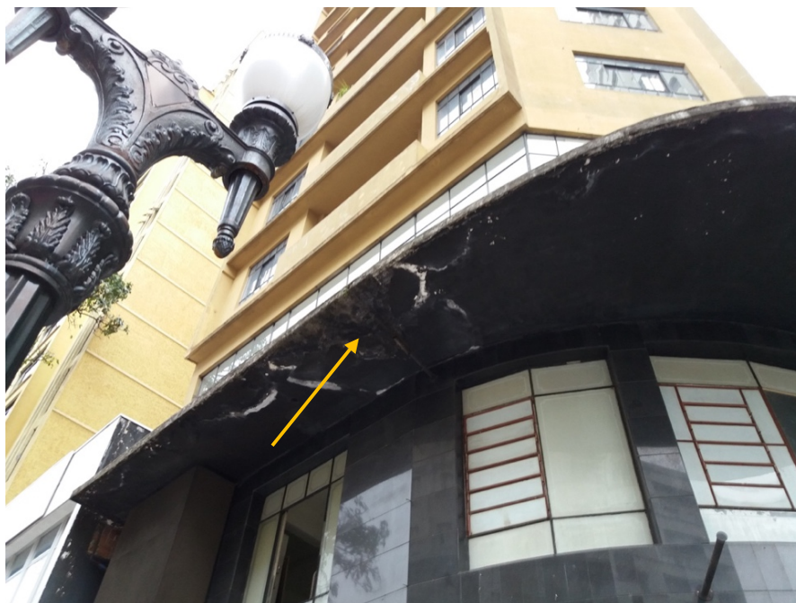
Figura 29. Marquise com presença de eflorescência (AUTORES, 2018)
