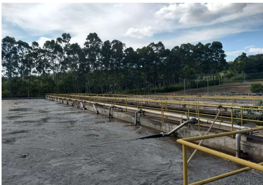
Figura 15 – Estruturas de aeração
