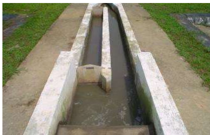
Figura 3 – Detalhe da caixa de areia de uma ETE
