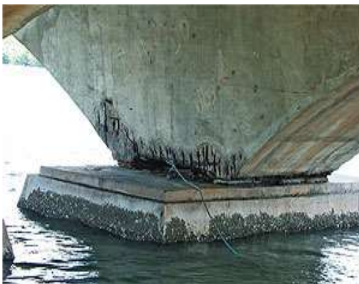
Figura 10 – Estrutura de concreto armado deteriorada
