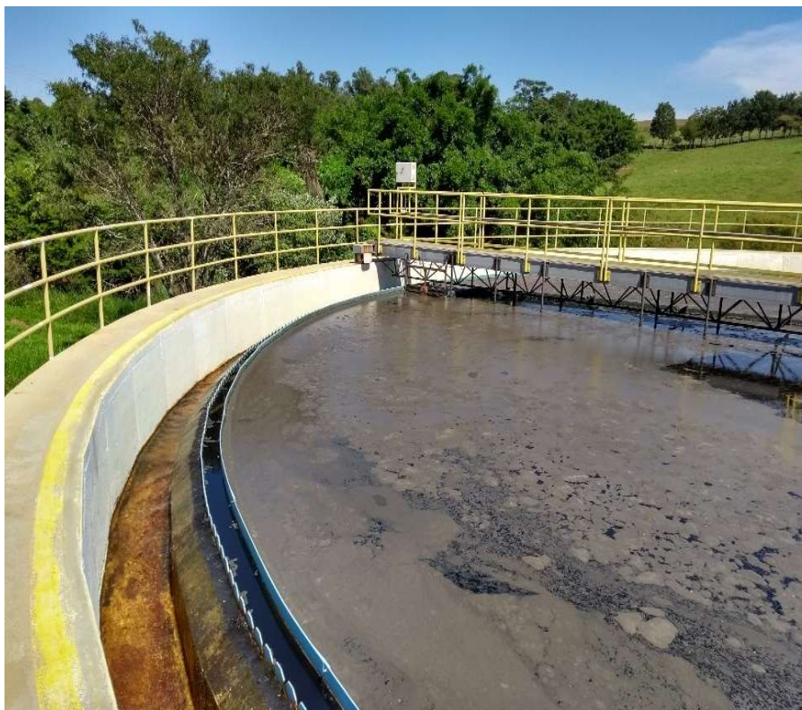
Figura 5 – Tanque de decantação na ETE de Cerquillo -SP Fonte: SAEEC – http://www.saaec.com.br/cerquillo-300/ (2013)
