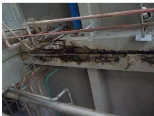
Figura 27: Desagregação do concreto e exposição do aço com corrosão em viga
