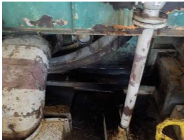
Imagem 34: Equipamento da área de produção com vazamento
