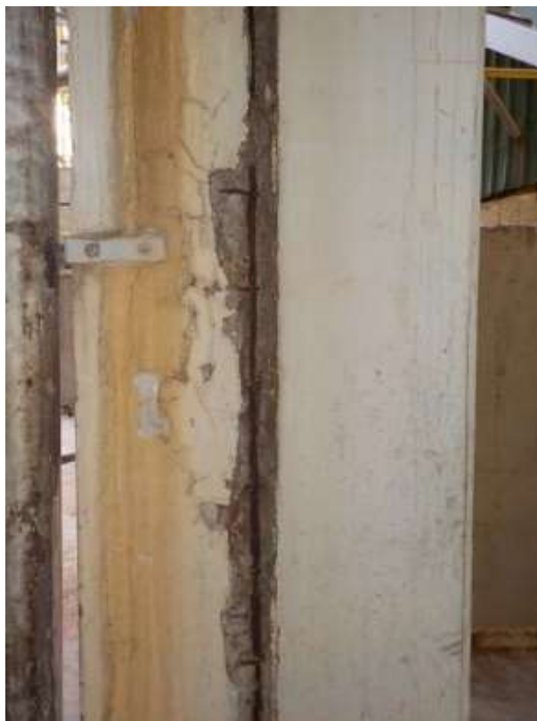
Imagem 22: Junta entre os pilares no pavimento térreo e exposição de armação.
