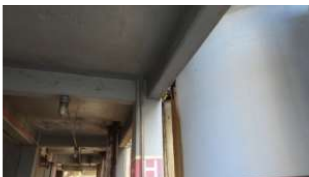
Imagem 63: Fissura em viga e infiltração em laje.
