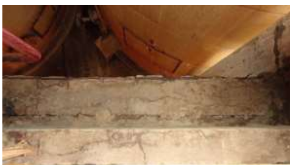
Imagem 71: Fissura e exposição de armação em viga
