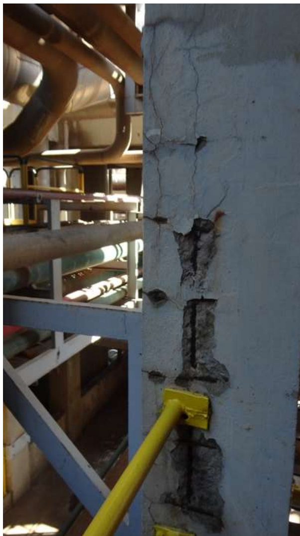
Imagem 46: Corrosão no aço em pilar no primeiro piso.
