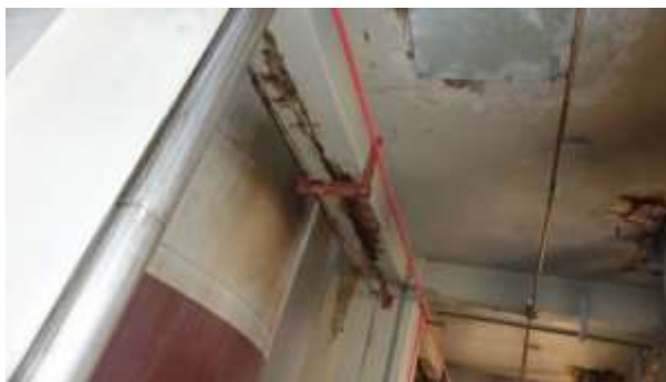
Imagem 64: Mancha em viga.
