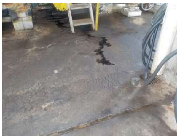
Imagem 33: Vazamento indo em direção a junta no terceiro pavimento.
