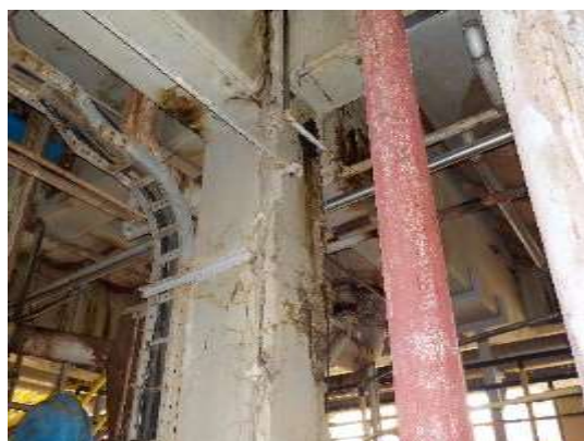
Figura 25: Desagregação do concreto da viga do 1º pavimento.
