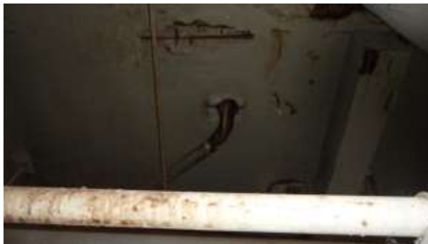
Imagem 7: Laje do 3º pavimento com desagregação, exposição da armação e corrosão no aço.
