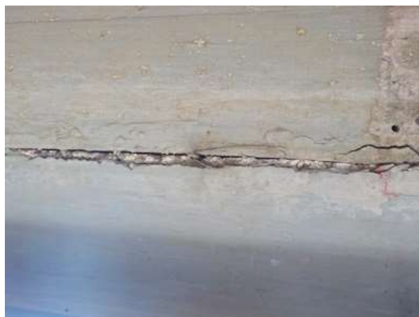
Imagem 23: Fissura em pilar 3º pavimento.
