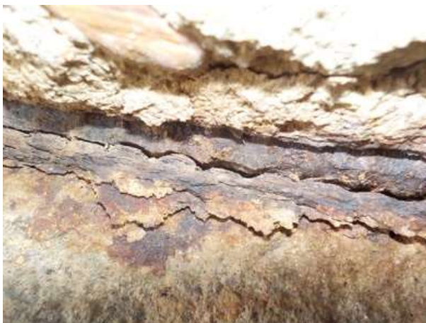
Imagem 13: Corrosão e fissura acentuada na barra de aço.
