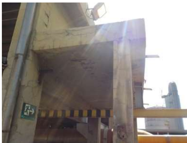
Imagem 25: Desagregação na laje no mezanino.
