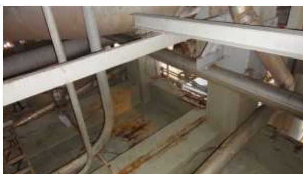
Imagem 51: Corrosão no aço, desagregação e exposição de armação
