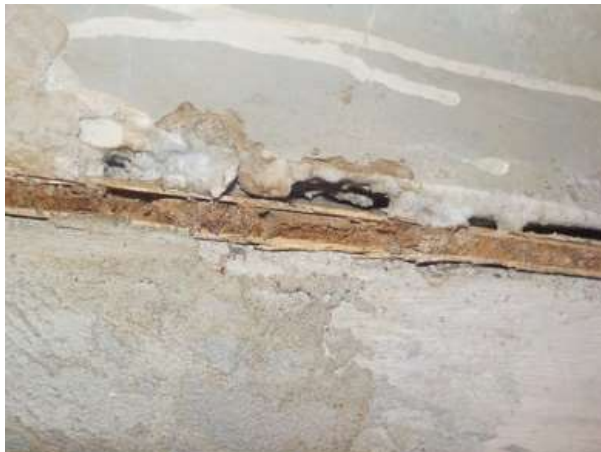
Imagem 29: Falha em junta.
