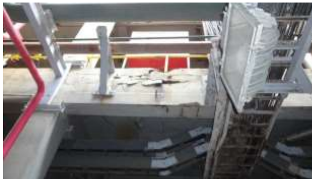
Imagem 10: Lateral sul viga com desagregação do concreto
