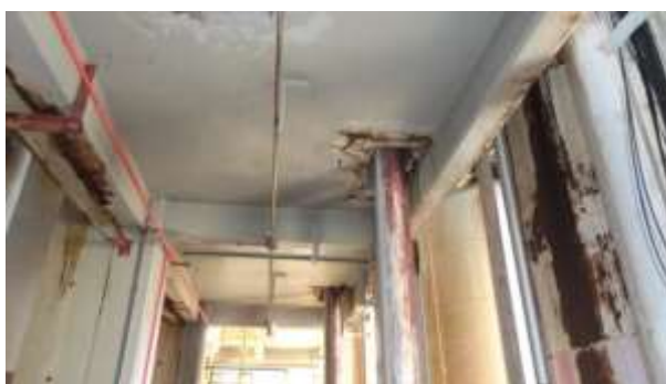
Imagem 65: Falha em junta e vazamento em laje.
