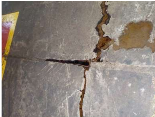
Imagem 37: Vazamento sobre a junta.
