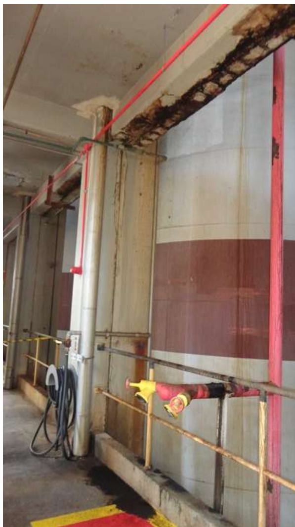
Imagem 69: Desagregação em vigas de concreto
