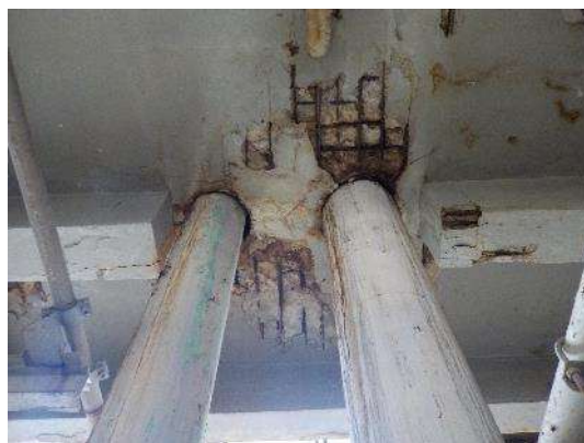
Figura 24: Contato com produtos químicos
