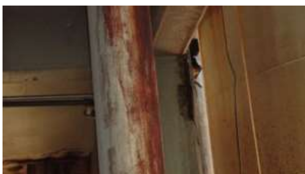
Imagem 66: Corrosão no aço.
