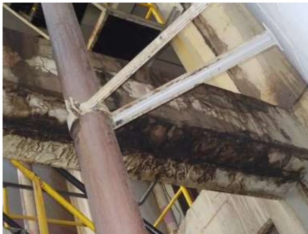
Imagem 19: Falha na junta das vigas e manchas de vazamento
