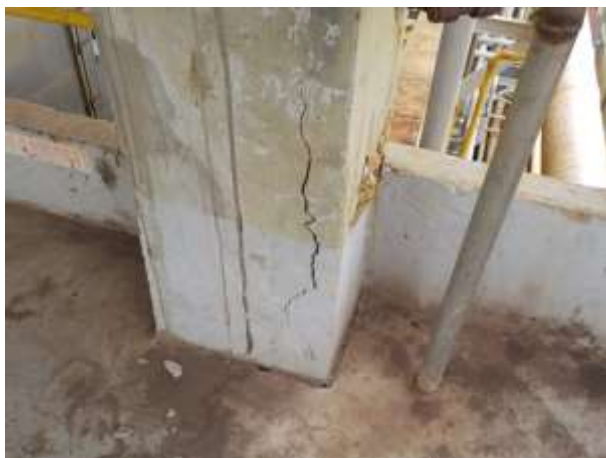
Imagem 8: Pilar segundo pavimento com fissura
