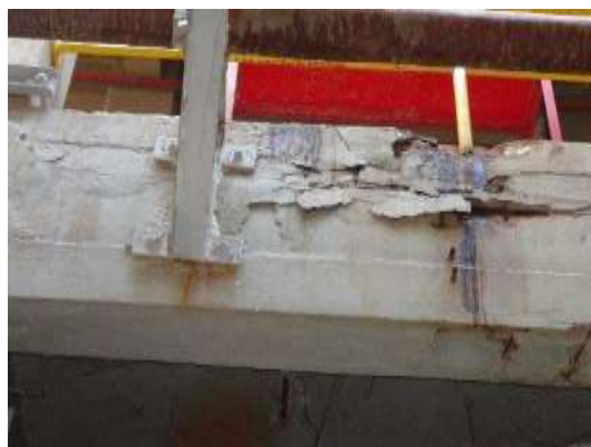
Figura 22: Contato com produtos químicos na viga da 1ª laje
