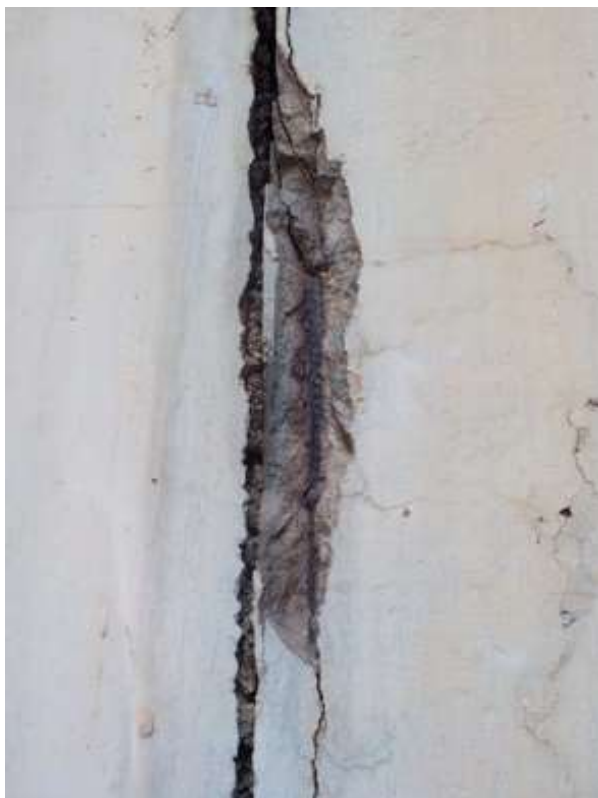
Imagem 73: Corrosão no aço em pilar
