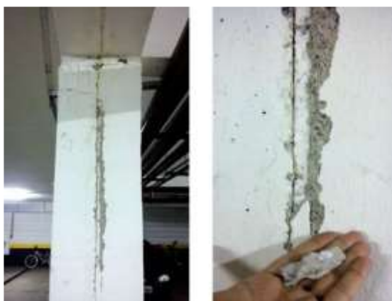
Figura 12: Falha em junta de dilatação
