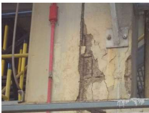
Imagem 12: Desagregação no segundo piso.
