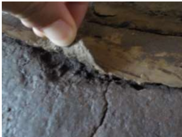
Imagem 4: Falha no selante da junta laje do 3º pavimento
