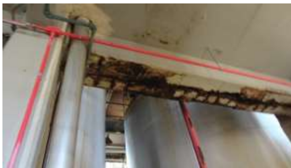
Imagem 67: Vazamento de produto nas vigas
