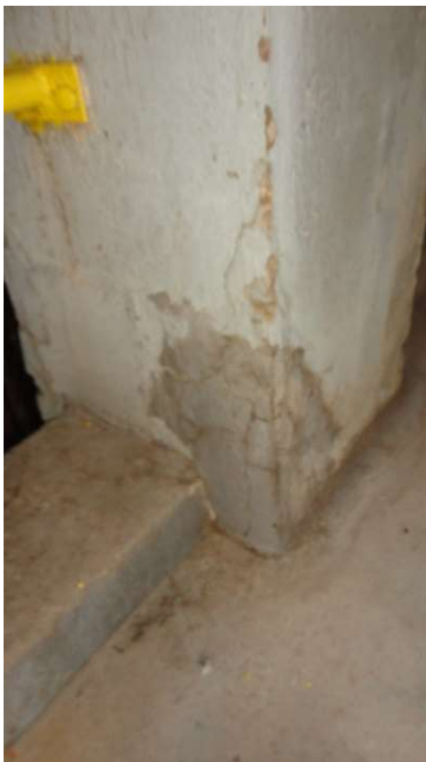
Imagem 48: Fissura em pilar.
