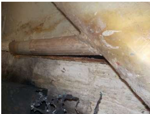
Imagem 27: Falha em junta no 2º piso.
