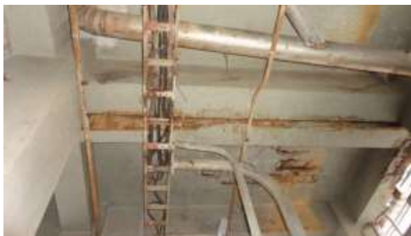
Imagem 52: Falha em junta
