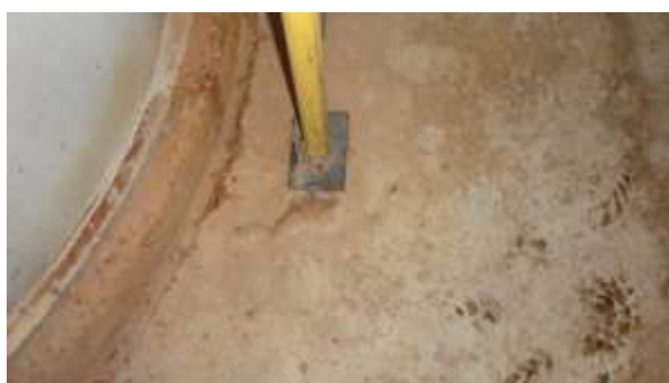
Imagem 60: Falha em junta.
