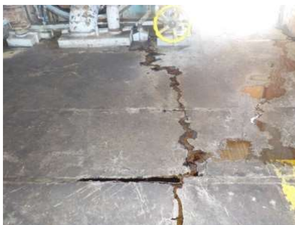
Imagem 38: Vazamento sobre a junta.
