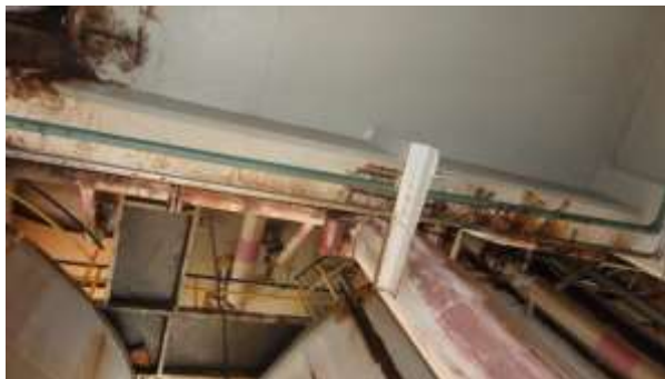
Imagem 72: Desagregação do concreto.
