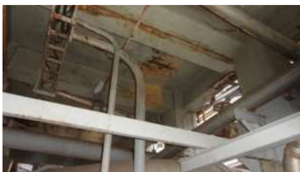
Imagem 49: Desagregação em laje e vigas.
