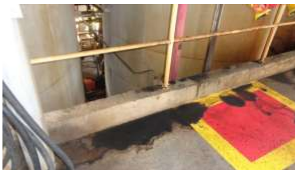
Imagem 68: Vazamento de produto químico
