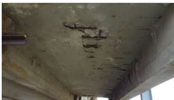
Imagem 11: Desagregação e falta de recobrimento no mezanino
