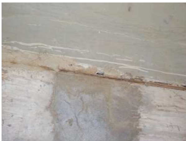
Imagem 28: Falha em junta e fissuras.
