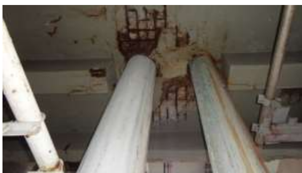
Imagem 57: Exposição de armação em laje.
