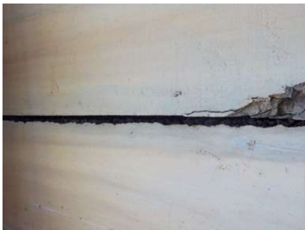
Imagem 14: Falha em junta de dilatação
