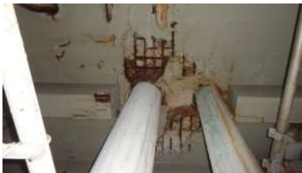
Imagem 55: Exposição de armação em laje.
