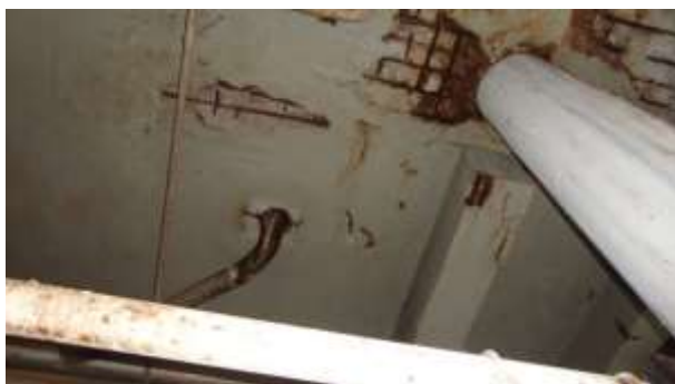
Imagem 56: Exposição de armação em laje.
