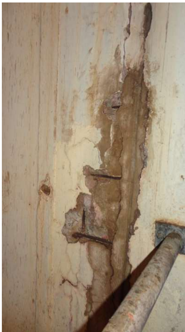
Imagem 70: Desagregação de concreto.
