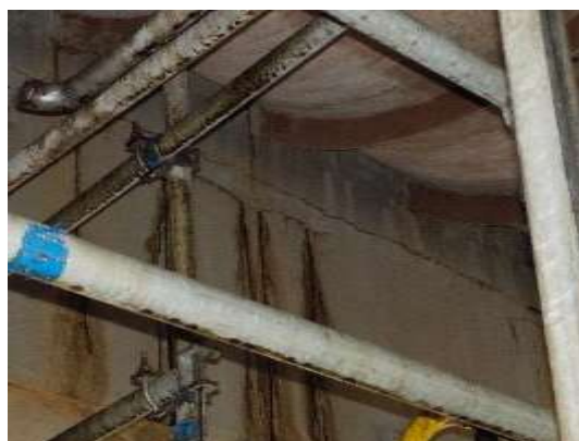
Figura 26: Contato com produtos químicos na viga da 1ª laje
