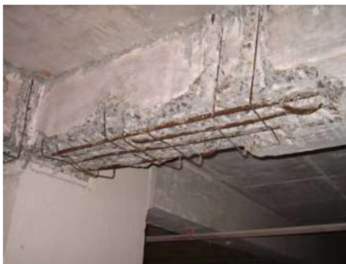
Figura 11: Desagregação do concreto em viga
