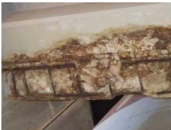
Imagem 1: Viga em processo de desagregação no pavimento térreo.
