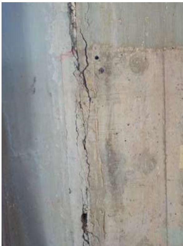
Imagem 24: Fissuras em pilar 3º pavimento
