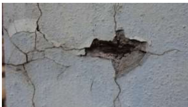
Imagem 45: Desagregação e corrosão do aço.
