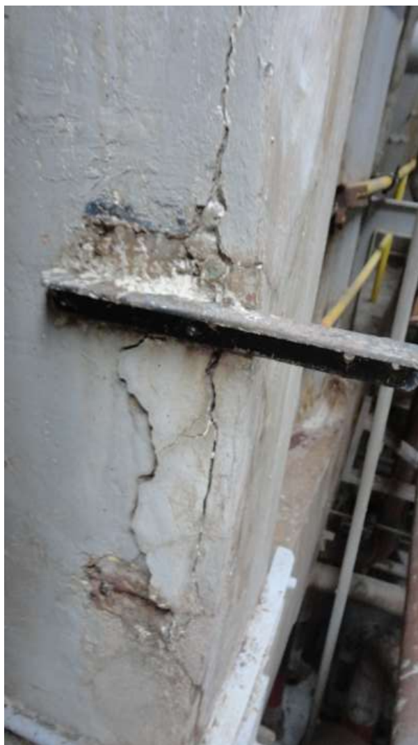
Imagem 50: Desagregação do concreto.
