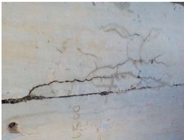
Imagem 15: Fissura e desagregação.
