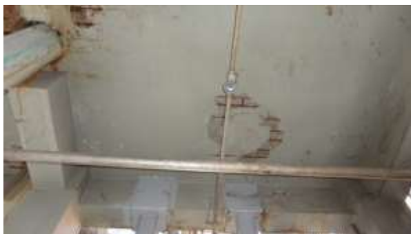
Imagem 54: Exposição de armação em laje.
