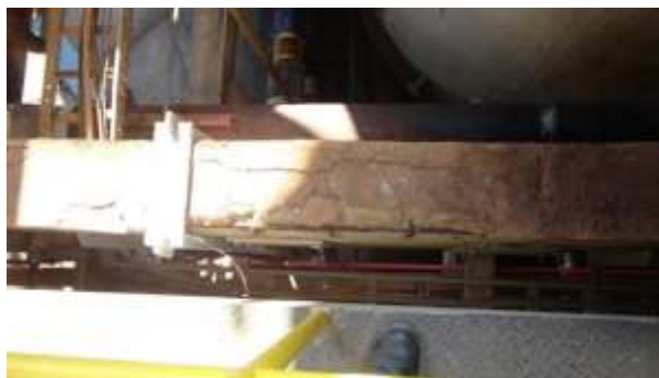
Imagem 40: Exposição de armadura e corrosão no aço.
