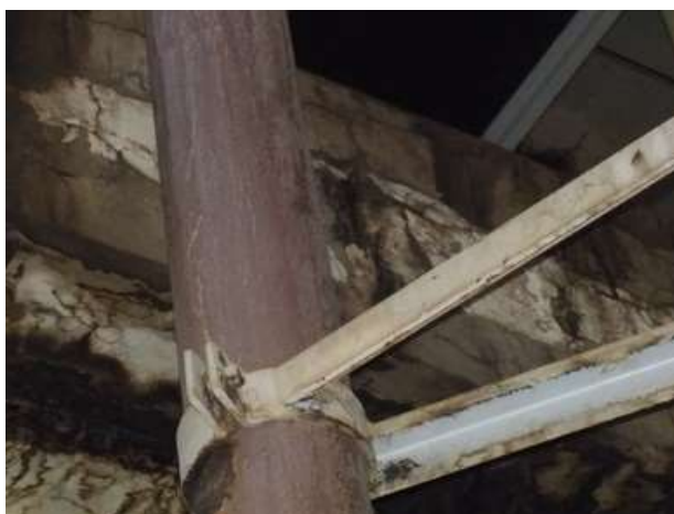
Imagem 20: Desagregação em viga
