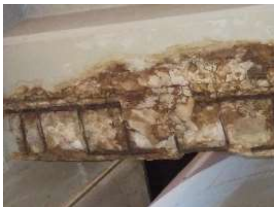
Figura 21: Desagregação do concreto da viga do 1º pavimento
