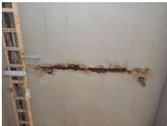
Figura 23: Desagregação do concreto e exposição do aço com corrosão em viga
