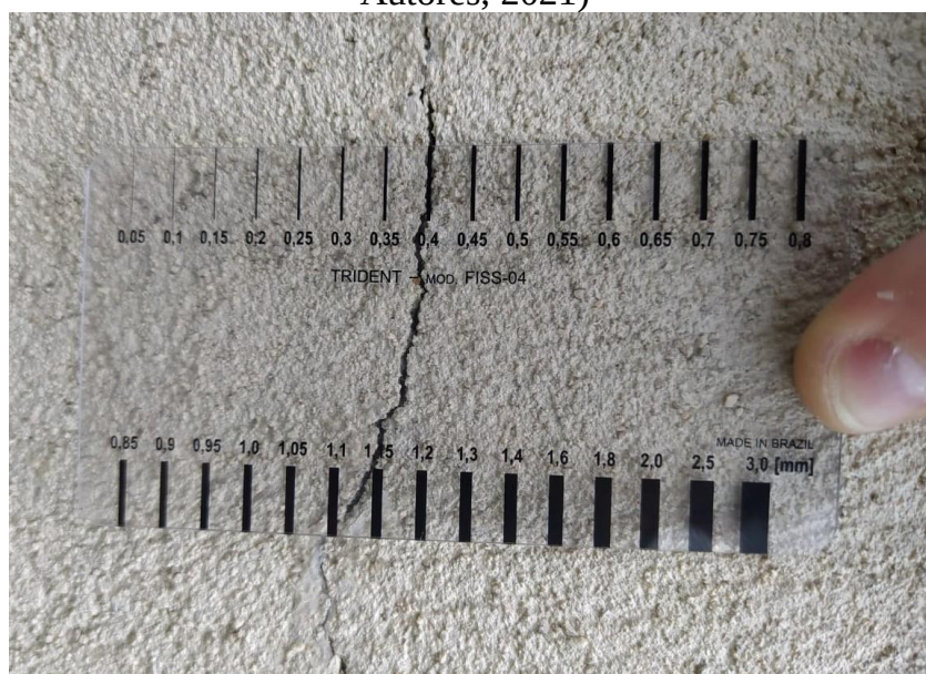
Figura 17. Medição da espessura de cada uma das fissuras dos painéis protótipos (Os Autores, 2021)
