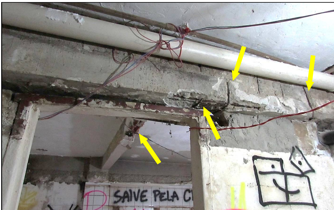
Figura 2 – Corrosão na armadura e deslocamento do concreto
