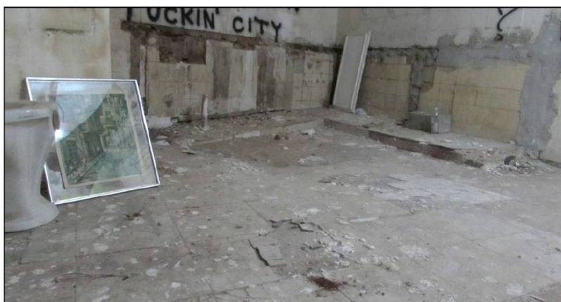
Figura 4 – Recalque no piso e som cavo - subsolo
