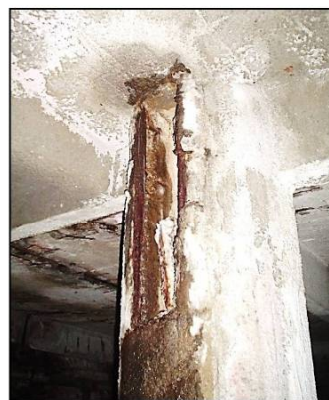
Figura 8 – Infiltração de água e corrosão no topo do pilar
