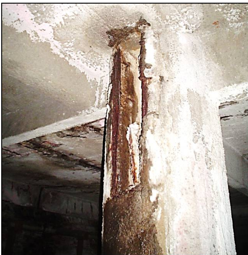
Figura 8 - Infiltração de água e corrosão no topo do pilar
