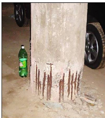
Figura 7 – Deslocamento do concreto e corrosão na base do pilar
