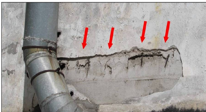
Figura 6 - Armadura aparente e desprendimento de reboco da fachada
