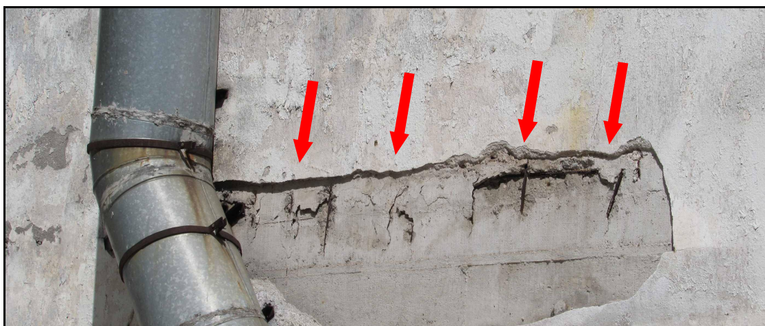
Figura 6 - Armadura aparente e desprendimento de reboco
