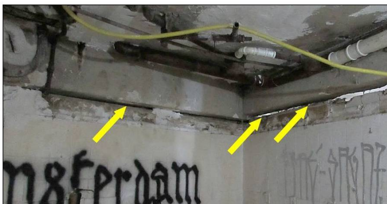
Figura 3 – Fendas entre vigas e alvenaria
