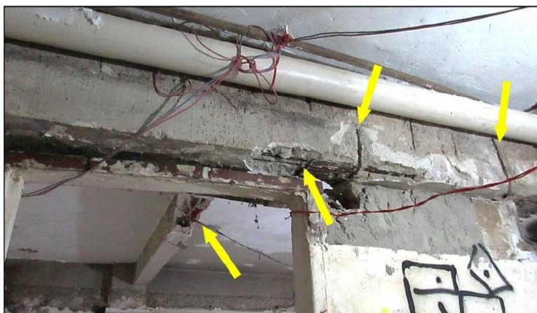
Figura 2 – Corrosão na armadura e deslocamento do concreto em vigas
