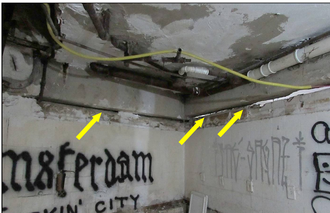
Figura 3 – Fendas entre vigas e alvenaria, gesso no teto
