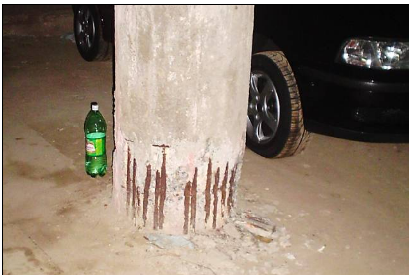
Figura 7 - Deslocamento do concreto e corrosão na base do pilar
