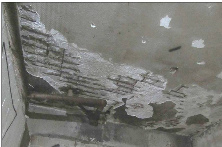
Figura 1 - Corrosão na armadura e deslocamento do concreto em lajes
