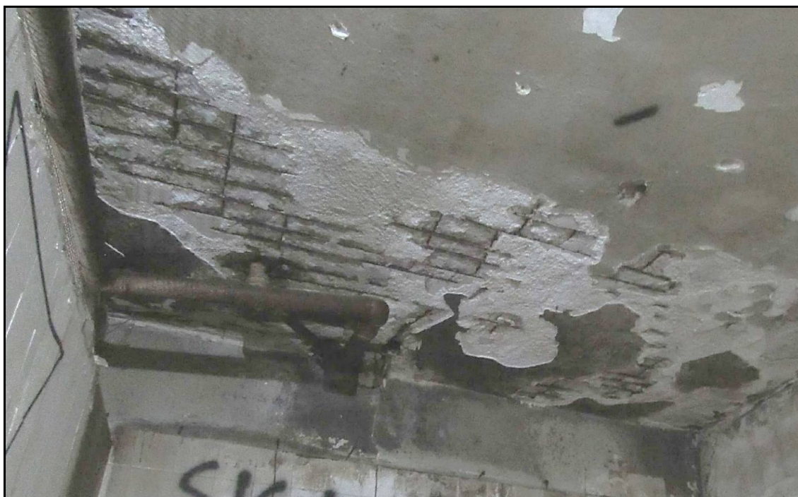
Figura 1 - Corrosão na armadura e deslocamento do concreto
