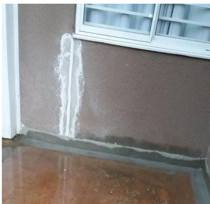
Figura 33. Infiltração de água na parte inferior da edificação
