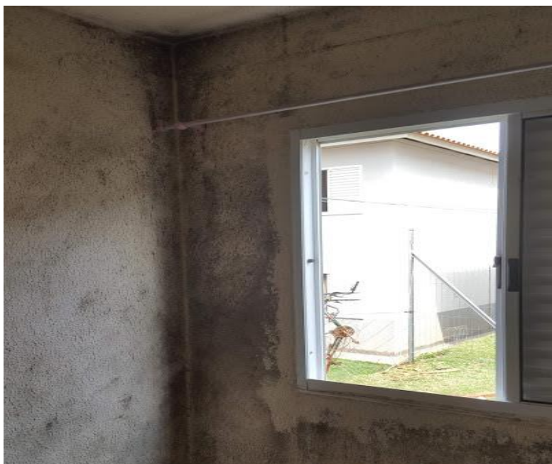
Figura 28. Parede com infiltração e bolor
