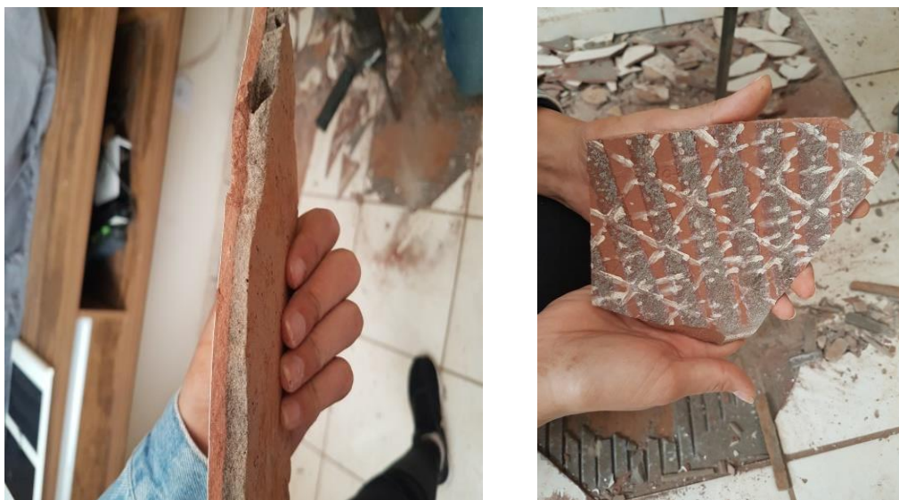
Figura 22. Desplacamento da cerâmica
