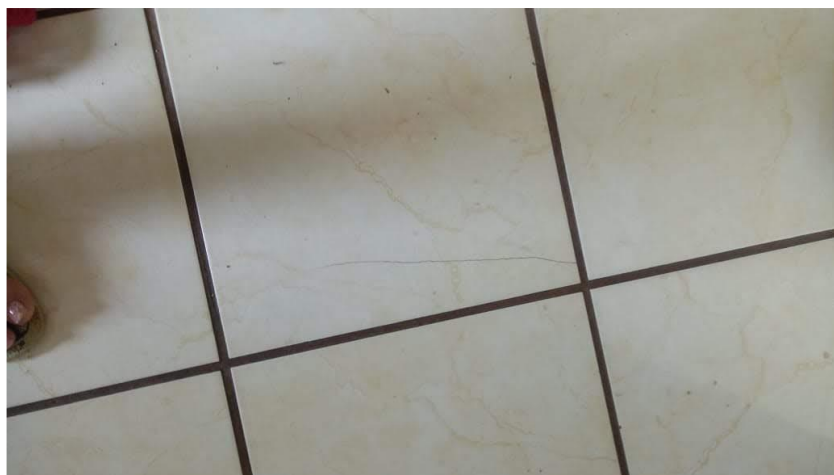
Figura 23. Fissuras no piso cerâmico
