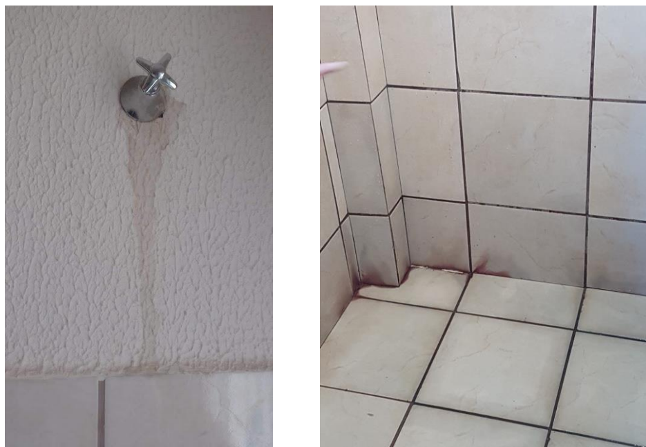
Figura 16. Lixiviação nos registros dos banheiros (continuação)
