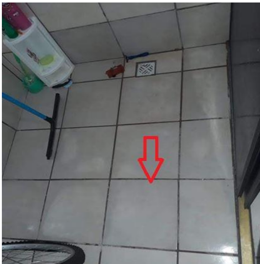
Figura 20. Caimento do piso no banheiro no sentido da seta
