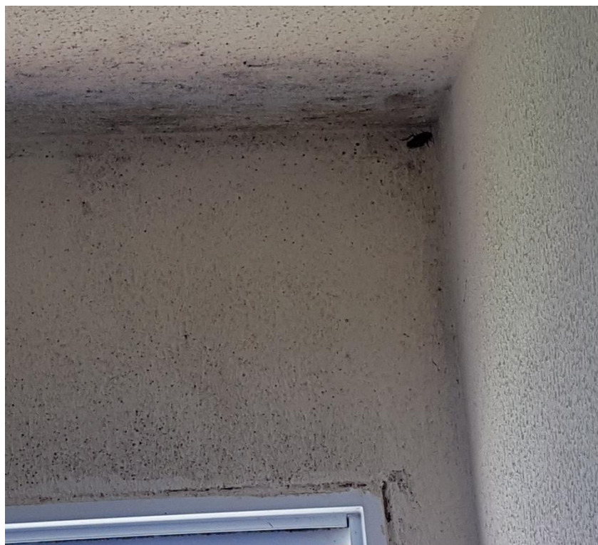
Figura 21. Umidade no teto dos apartamentos
