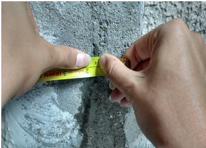
Figura 30. Passagem de água pelas fissuras
