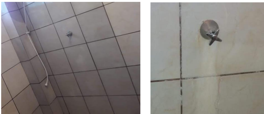
Figura 15. Lixiviação nos registros do banheiro
