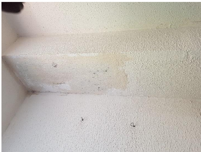
Figura 13. Manchas nas sancas técnicas
