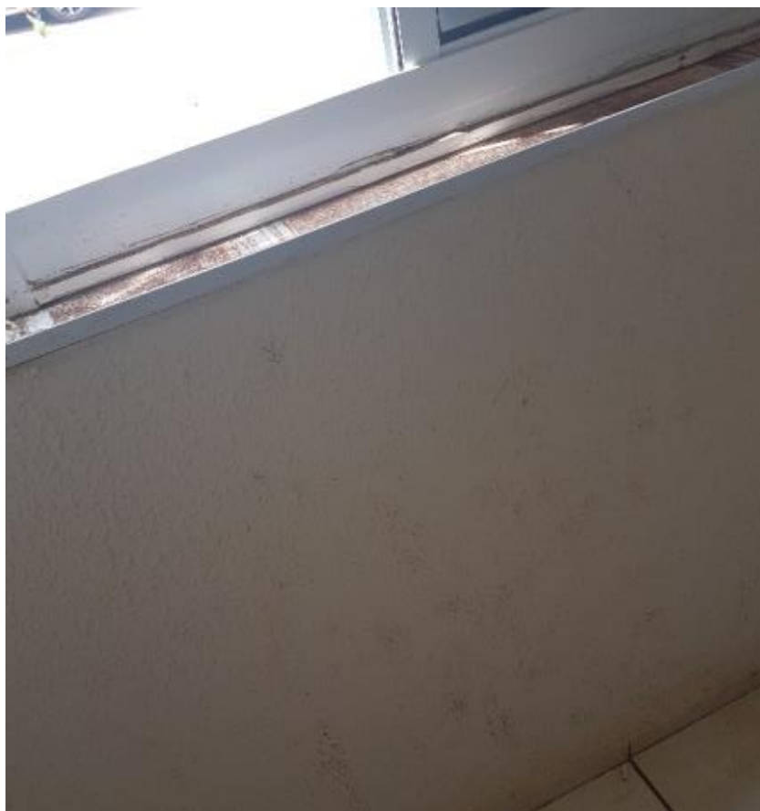
Figura 19. Falta de vedação nas esquadrias
