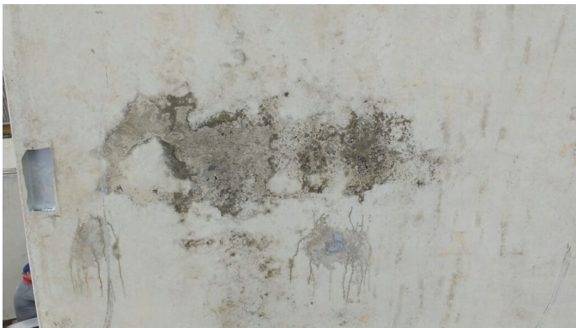
Figura 20– Avarias na superfície dos painéis devido a falha no processo de produção.
