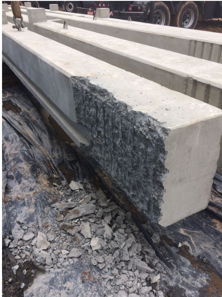
Figura 15- Devido ao erro de locação em virtude do projeto, alguns pilares pré-moldados sofreram retrabalhos.
