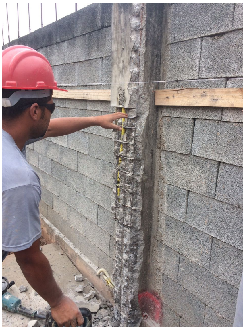
Figura 16– Pilares do muro existente na obra tiveram que sofrer adaptações não previstas para encaixe do painel de fechamento pré-moldado.
