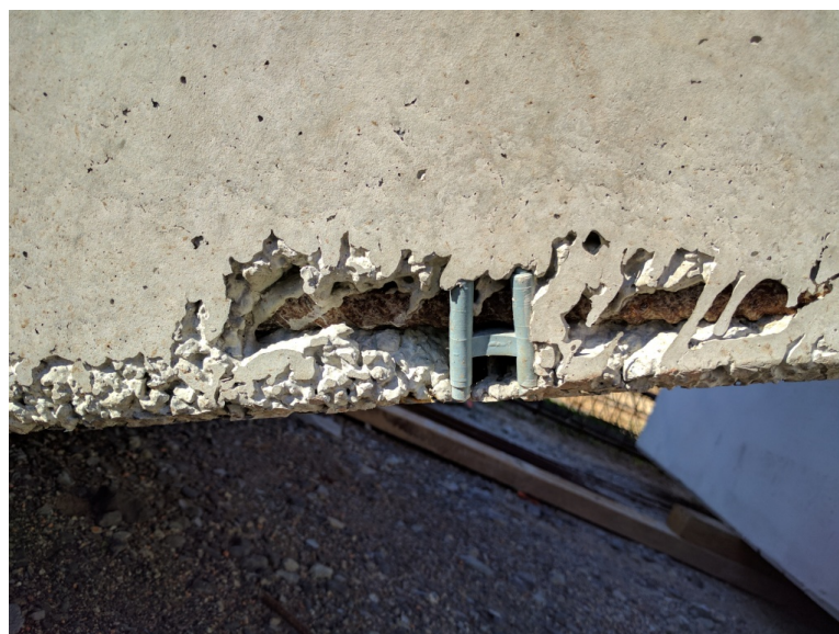
Figura 19– Vigas pré-moldadas com avarias na concretagem.
