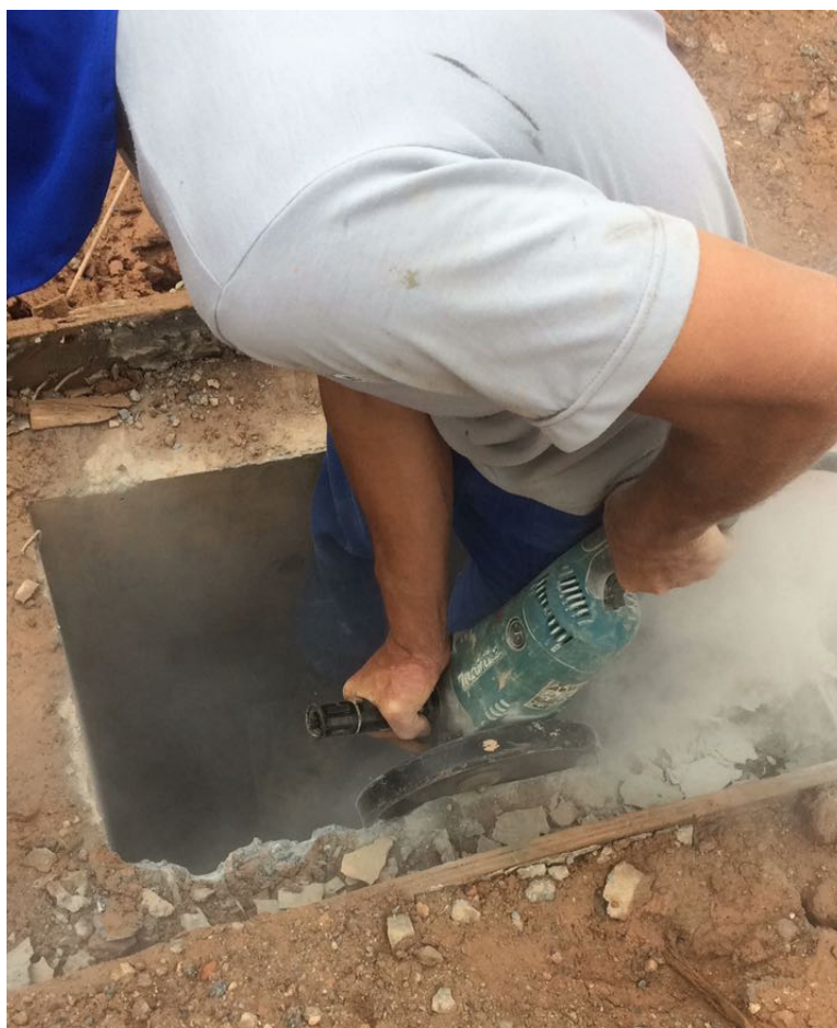
Figura 14– Devido ao erro na locação em virtude do projeto, o bloco de fundação sofreu retrabalhos.
