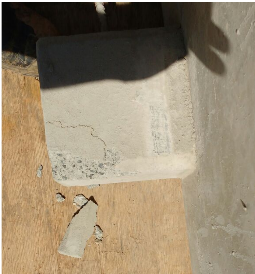
Figura 17– Consoles dos pilares ainda na carreta com pequenas quebras
