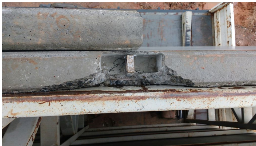
Figura 18– Painéis pré-moldados com defeitos devido ao mal manuseio das peças.
