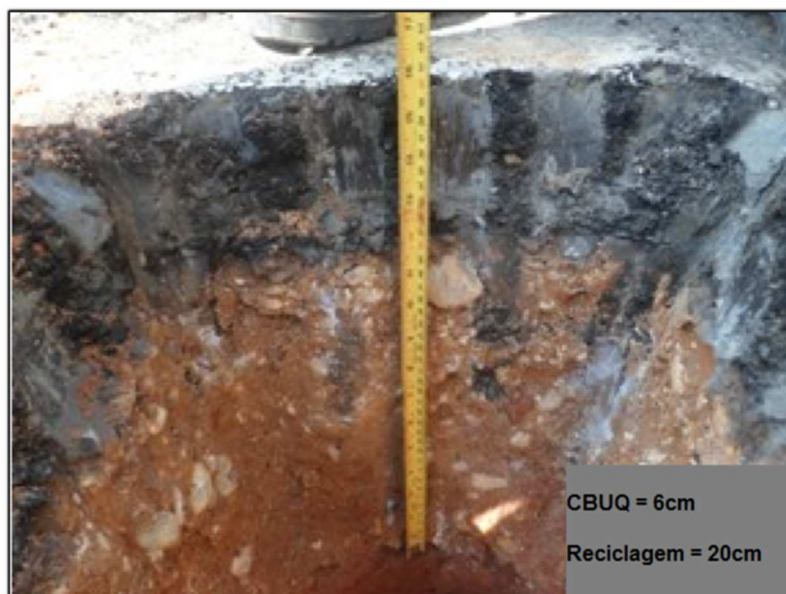
FIGURA 26 – POÇO DE INSPEÇÃO KM 175+404
