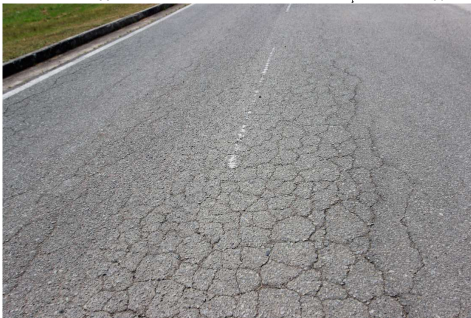
FIGURA 55 – TRINCAS INTERLIGADAS NA SEÇÃO FLEXS 601
