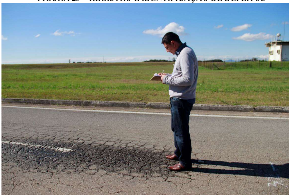
FIGURA 23 – REGISTRO E IDENTIFICAÇÃO DE DEFEITOS
