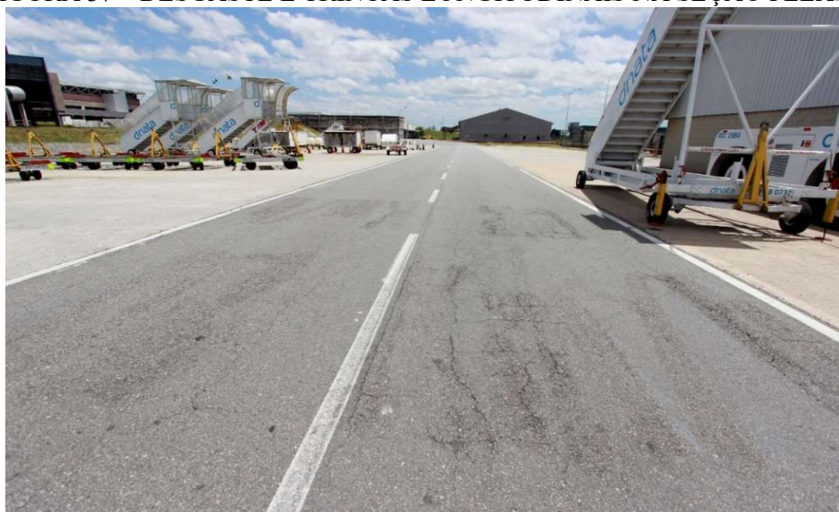
FIGURA 37 – DESGASTE E TRINCAS LONGITUDINAIS NA SEÇÃO FLEXS 103
