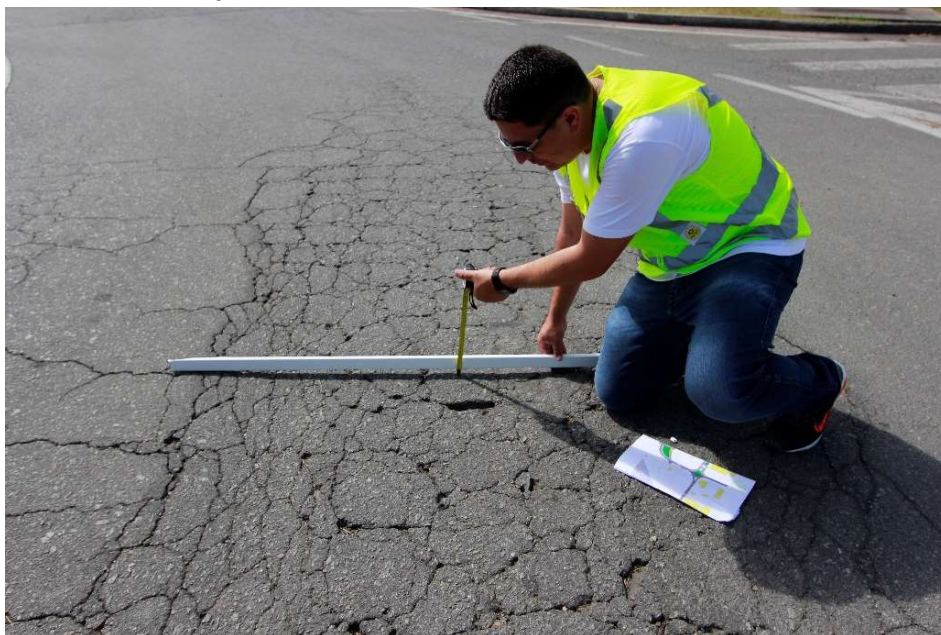
FIGURA 52 – TRILHA DE RODA COM SEVERIDADE MÉDIA
