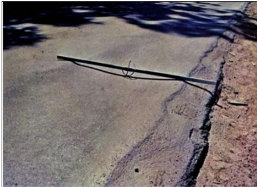
FIGURA 6 – AFUNDAMENTO POR CONSOLIDAÇÃO E TRILHA DE RODA
