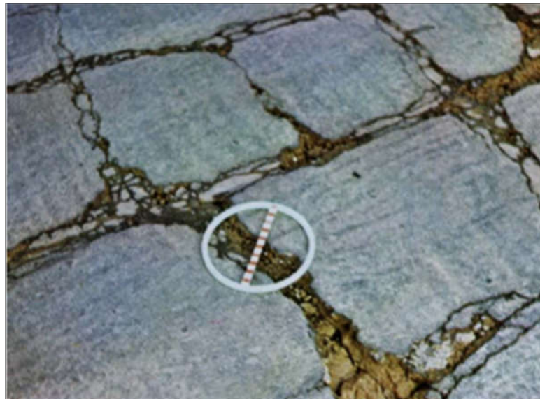
FIGURA 5- TRINCAS TIPO BLOCOS
