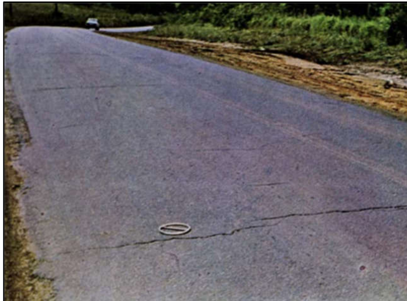
FIGURA 2 - TRINCA ISOLADA TRANSVERSAL
