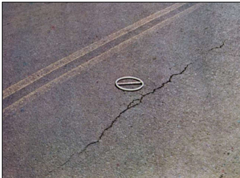
FIGURA 3 - TRINCA ISOLADA LONGITUDINAL
