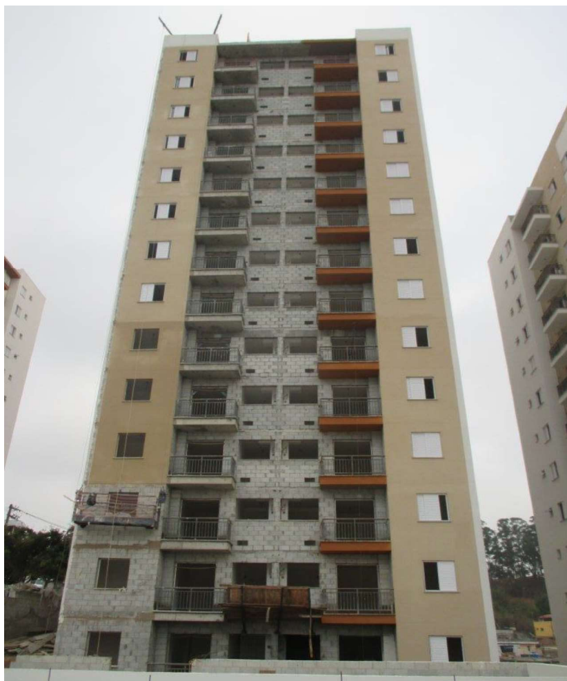
Fotografia 1. Revestimento monocamada em empreendimento habitacional (Os autores, 2019)
