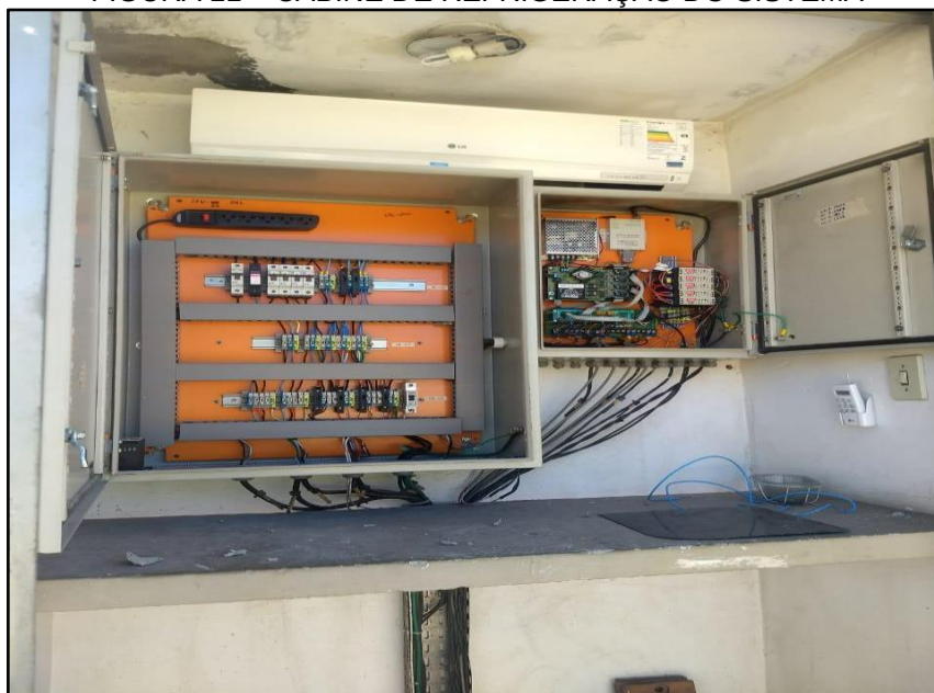
FIGURA 11 – CABINE DE REFRIGERAÇÃO DO SISTEMA
