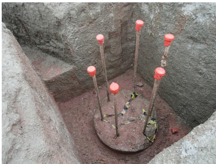
FIGURA 5 – Estaca arrasada na cota e forma contra barranco. (ACOMPANHAMENTO DE OBRA, 2014).
