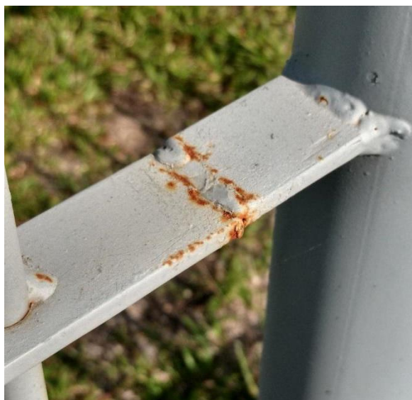
Figura 7: Corrosão na emenda da grade
