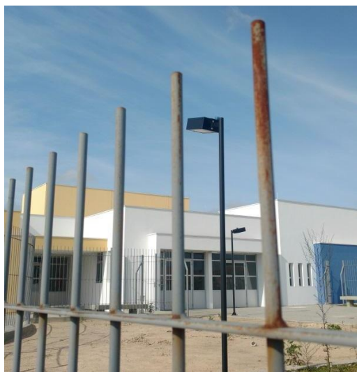
Figura 6: Pontos de corrosão da grade
