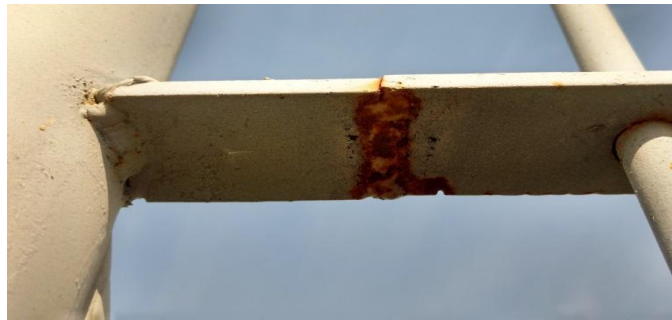
Figura 5: Corrosão da grade
