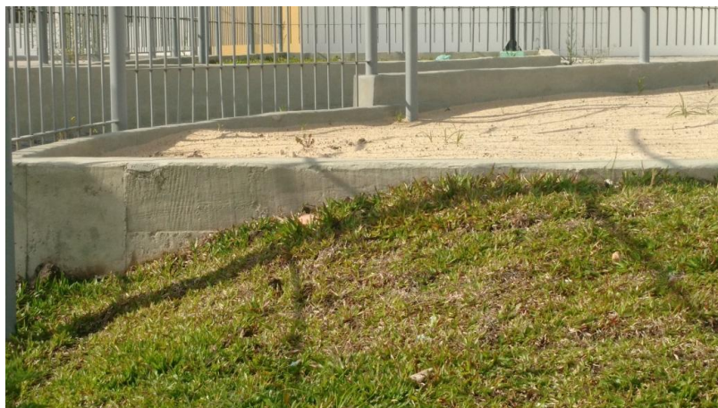
Figura 8: Estrutura passível de infiltração devido a falta de impermeabilização
