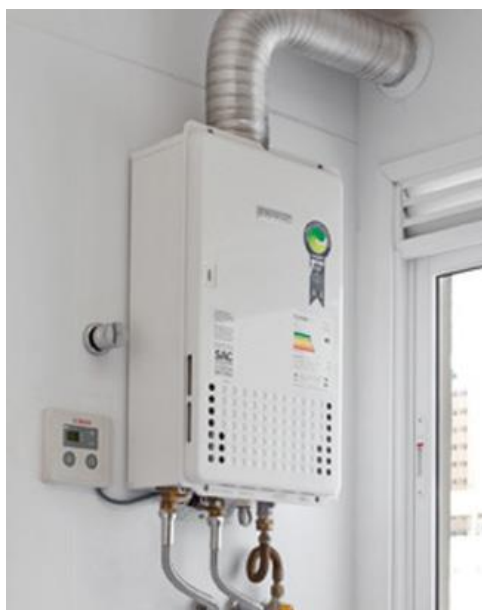
Figura 25 – Aquecedor de Passagem a Gás instalado. (FONTE: Acervo Pessoal)
