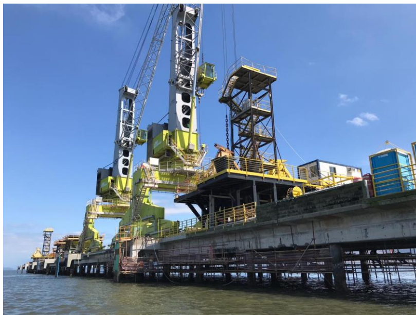
Figura 7. Vista externa do píer (Fonte: Laudo de manifestações patológicas – Píer de Paranaguá/PR, 2013)
