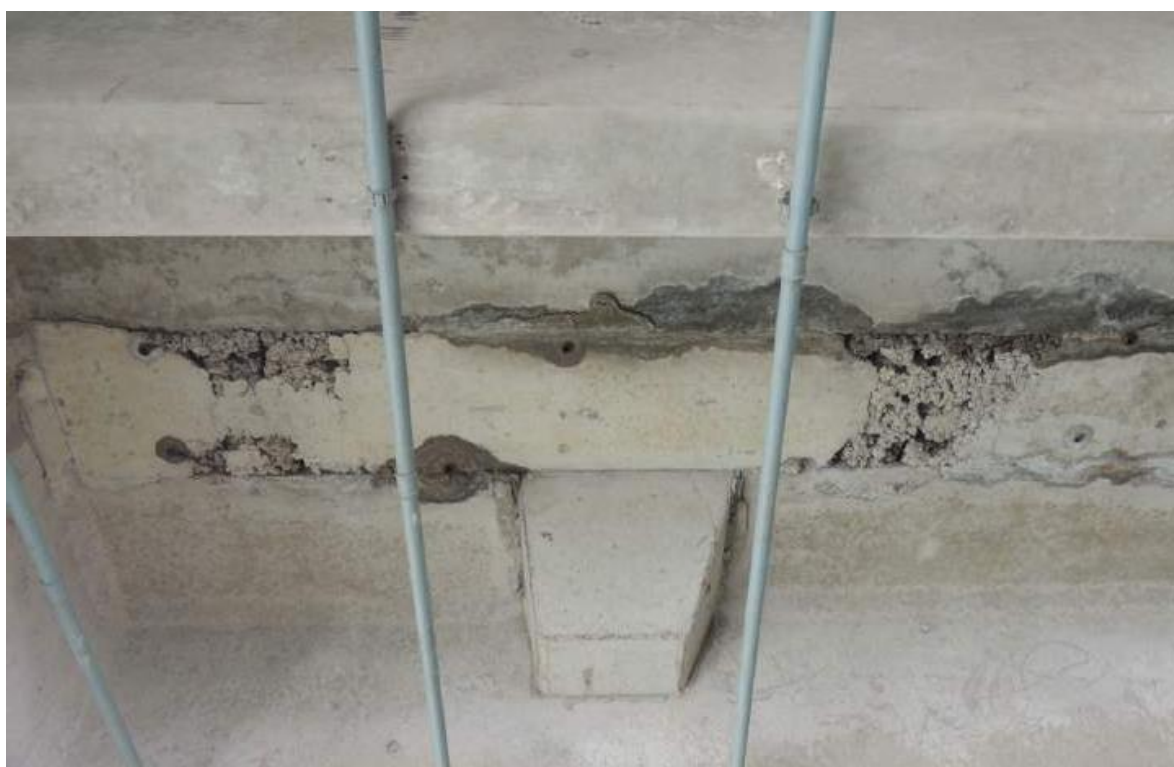
Figura 20. Desagregação do concreto, vigas longitudinais
