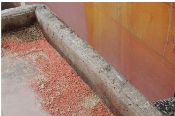
Figura 12. Presença de cloretos na estrutura de concreto armado.
