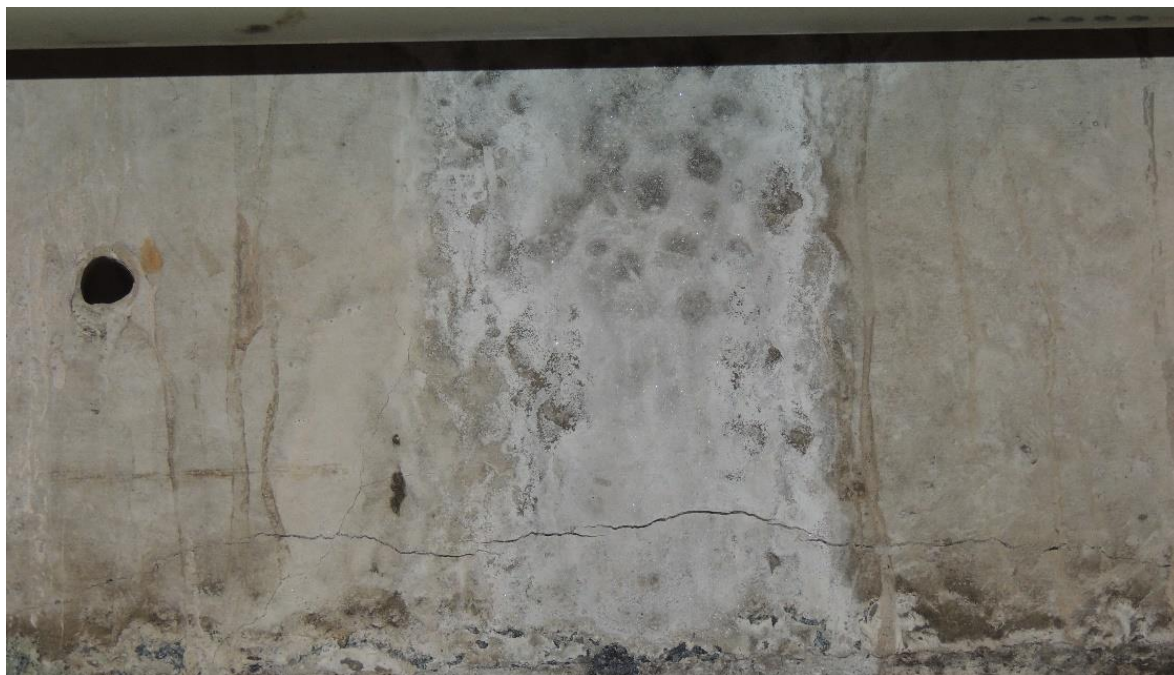
Figura 19. Aumento das manifestações patológicas, vigas transversais.
