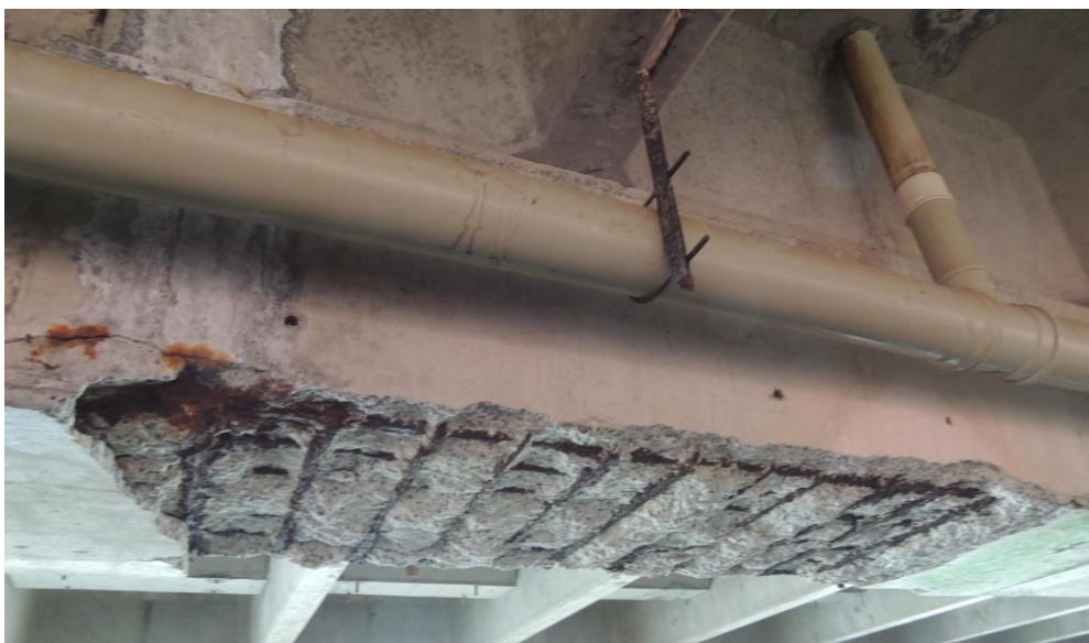
Figura 17. Deslocamento do concreto devido a corrosão das armaduras, vigas longitudinais.
