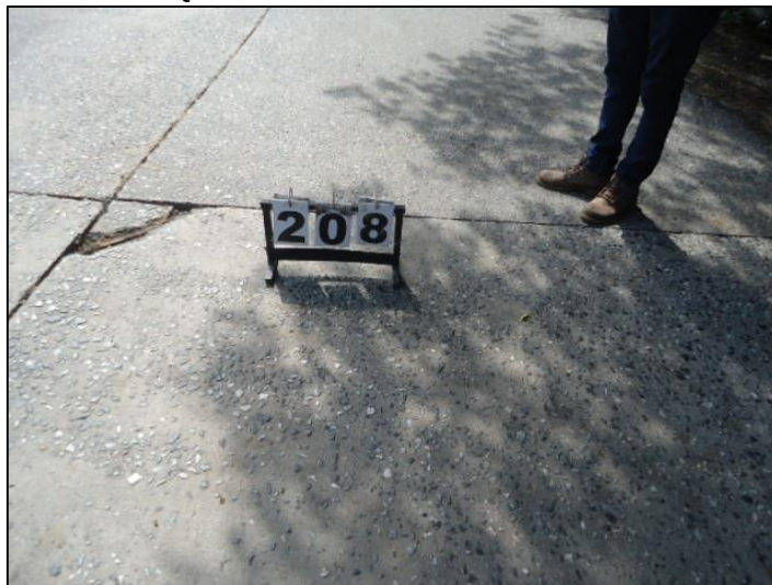
FIGURA 18 - DEFEITO QUEBRAS DE CANTO EM PAVIMENTO DE CONCRETO
