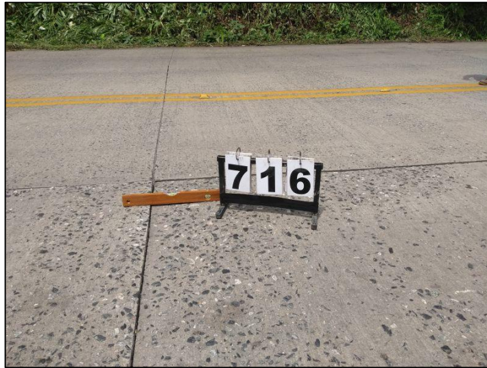
FIGURA 7 - DEGRAUS NAS JUNTAS EM PAVIMENTO DE CONCRETO
