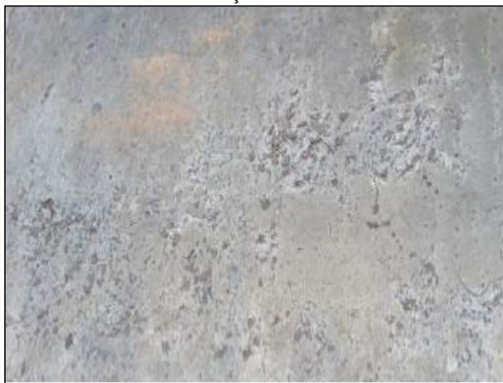
FIGURA 16 - DEFEITO ESCAMAÇÃO EM PAVIMENTO DE CONCRETO
