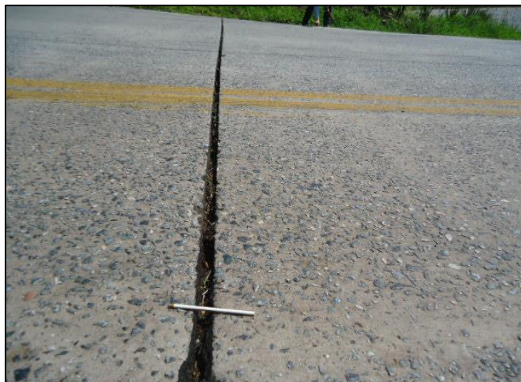
FIGURA 8 - DEFEITO NA SELAGEM DAS JUNTAS EM PAVIMENTO DE CONCRETO
