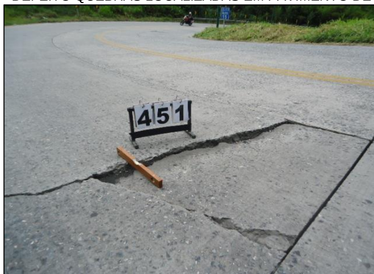
FIGURA 15 - DEFEITO QUEBRAS LOCALIZADAS EM PAVIMENTO DE CONCRETO
