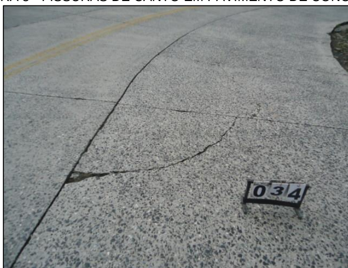
FIGURA 5 - FISSURAS DE CANTO EM PAVIMENTO DE CONCRETO
