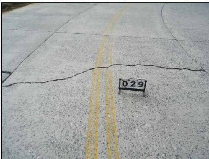
FIGURA 10 - DEFEITO FISSURAS LINEARES EM PAVIMENTO DE CONCRETO
