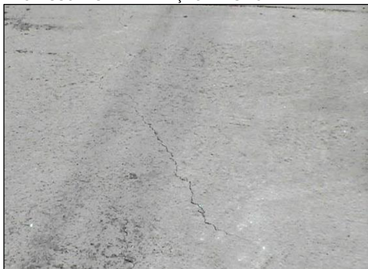
FIGURA 17 - DEFEITO FISSURAS DE RETRAÇÃO PLÁSTICA EM PAVIMENTO DE CONCRETO
