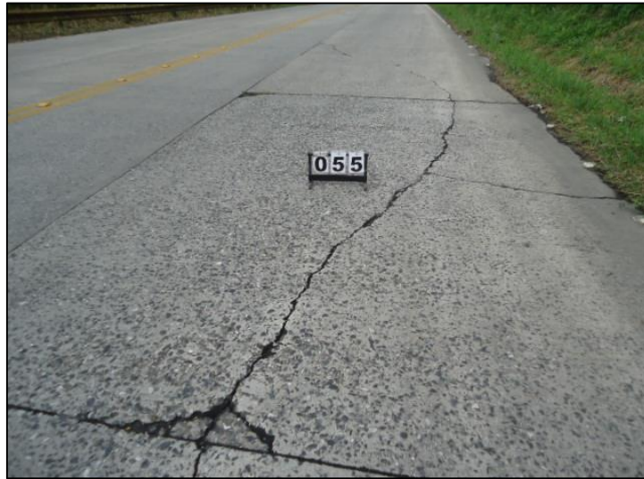
FIGURA 6 - PLACA DIVIDIDA EM PAVIMENTO DE CONCRETO
