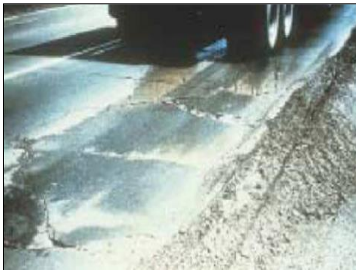
FIGURA 14 - DEFEITO BOMBEAMENTO EM PAVIMENTO DE CONCRETO
