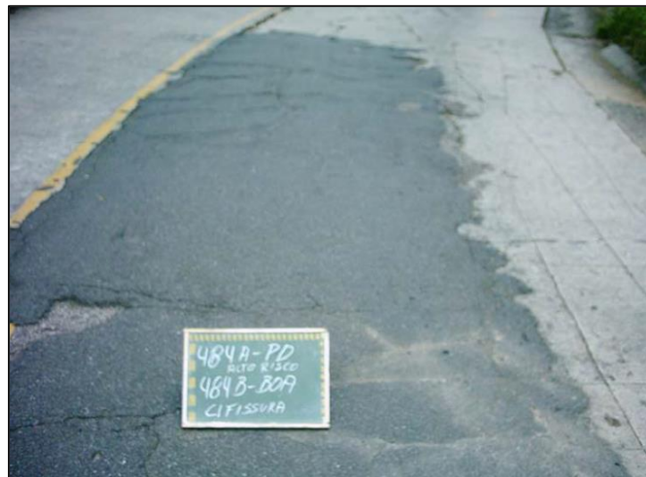
FIGURA 11 - DEFEITO GRANDES REPAROS EM PAVIMENTO DE CONCRETO
