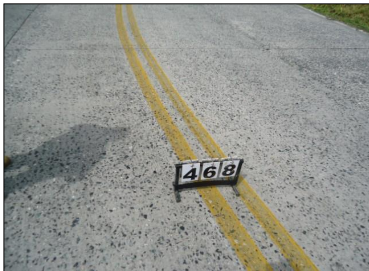
FIGURA 13 - DEFEITO DESGASTE SUPERFICIAL EM PAVIMENTO DE CONCRETO
