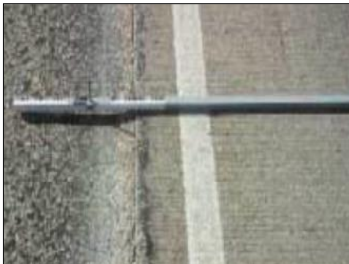
FIGURA 9 - DESNÍVEL ENTRE PAVIMENTO E ACOSTAMENTO EM PAVIMENTO DE
