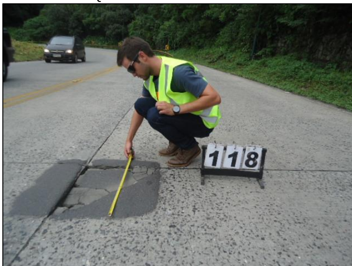
FIGURA 12 - DEFEITO PEQUENOS REPAROS EM PAVIMENTO DE CONCRETO
