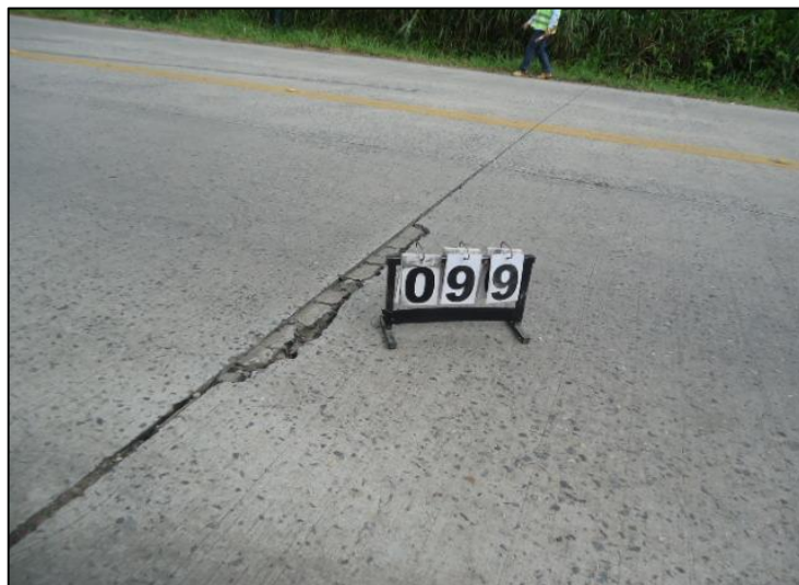
FIGURA 19 - DEFEITO ESBORCINAMENTO DE JUNTAS EM PAVIMENTO DE CONCRETO
