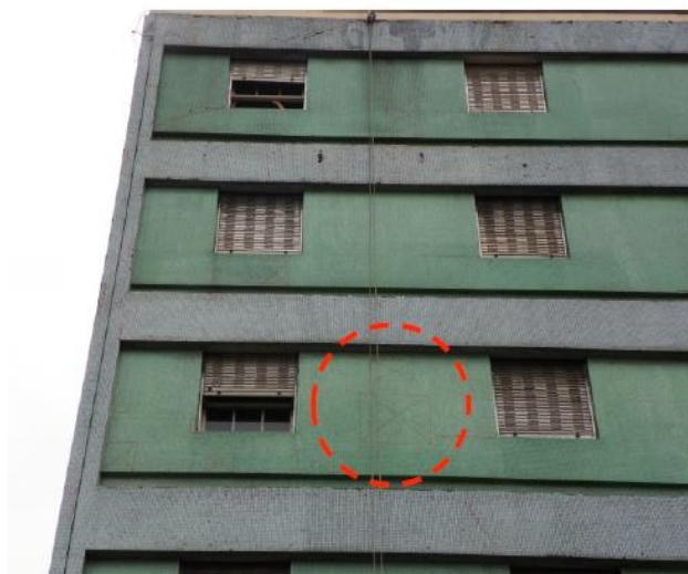
Figura 13 - Áreas demarcadas com som cavo à percussão denotando perda de aderência de todo o conjunto de revestimento.
