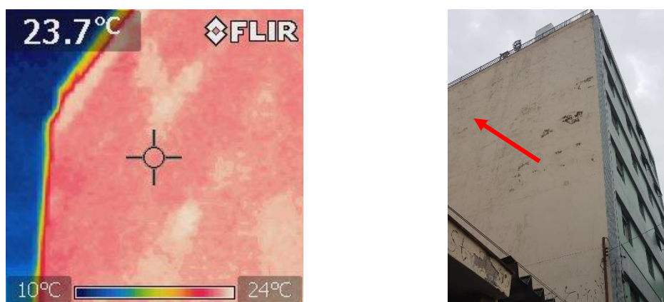
Figura 27 - Imagem térmica e física lateral esquerda 5º e 6º andar.
