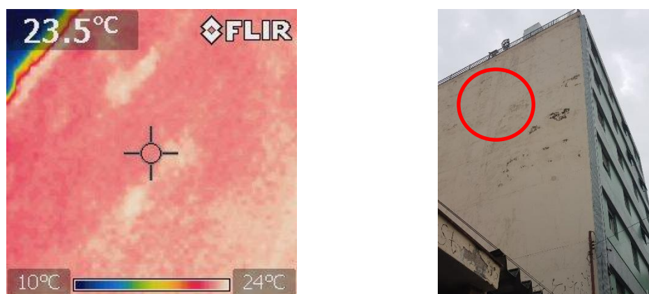
Figura 28- Imagem térmica e física lateral esquerda 5 e 6º andar.
