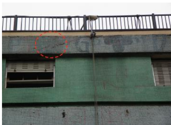
Figura 17 - Frontal– Perda de aderência com desprendimento do revestimento cerâmico em pastilhas
