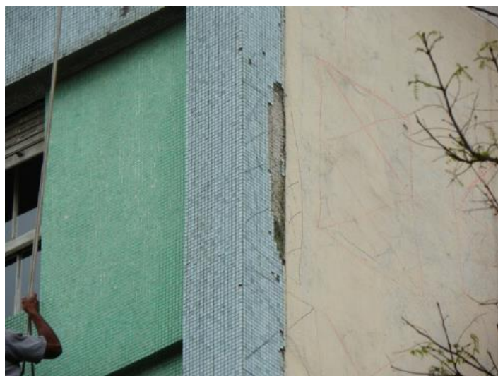
Figura 16 - Detalhe da fotografia anterior. Nota-se a ruptura na interface entre a argamassa adotada para o assentamento (alvaiade) e a pastilha cerâmica.
