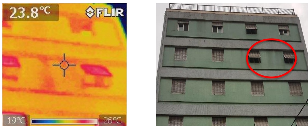
Figura 31- Imagem térmica e física lateral esquerda 5 e 6º andar.
