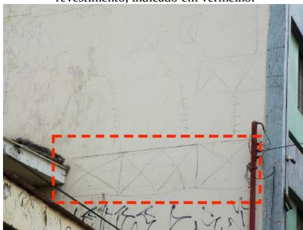
Figura 21 - Detalhe da fotografia anterior. Marcações de círculos sobre área com falha de aderência do revestimento, indicado em vermelho.
