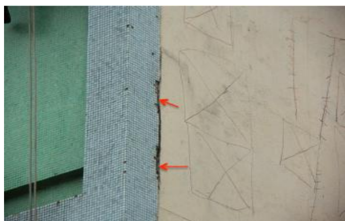
Figura 18 - Nota-se a ruptura na interface entre a argamassa adotada para o assentamento (alvaiade) e a pastilha cerâmica.
