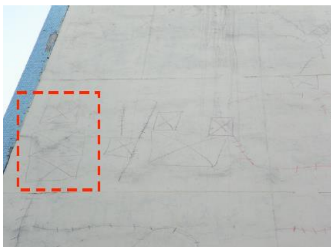
Figura 22 - Lateral Direita – Áreas demarcadas com “som cavo”, denotando falha de aderência do revestimento argamassado de fachada.
