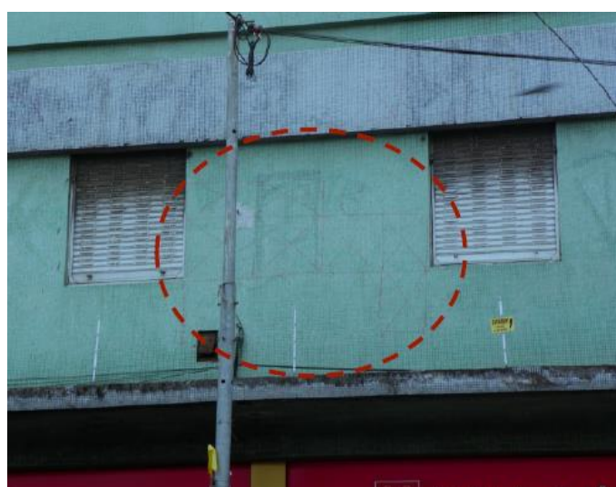
Figura 14 - Frontal – As áreas demarcadas com círculos no trecho ilustrado na fotografia estão com falha de aderência no conjunto de revestimento.
