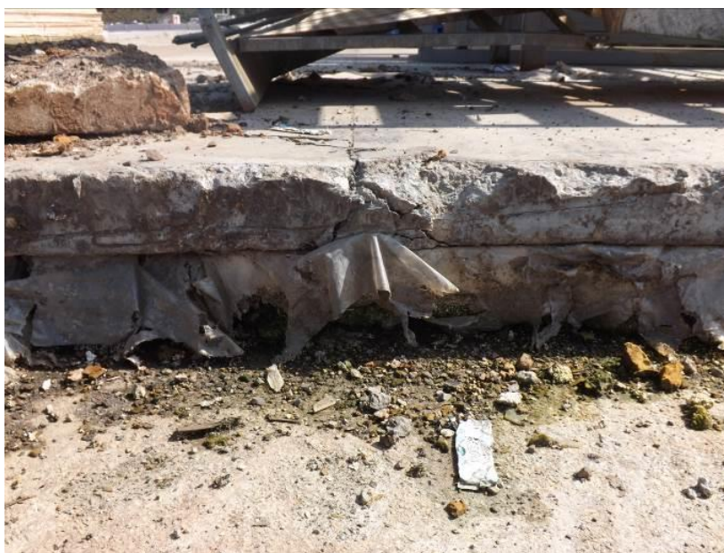
Foto 13: Isolamento térmico danificado
