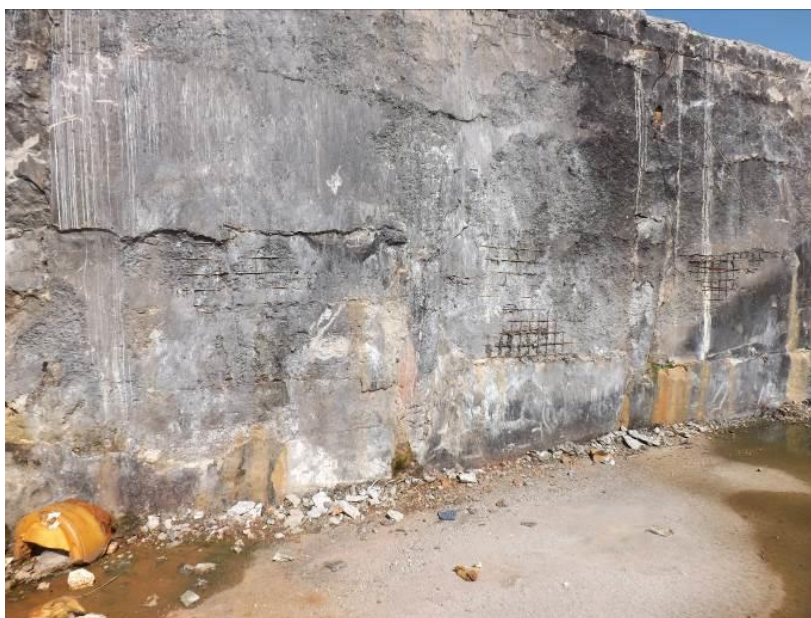
Foto 10: Avarias no concreto causadas pelo fogo.
