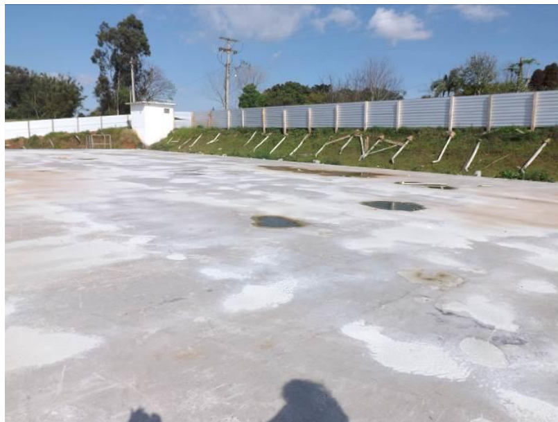
Foto 05: Observa-se o desgaste superficial do piso de concreto
