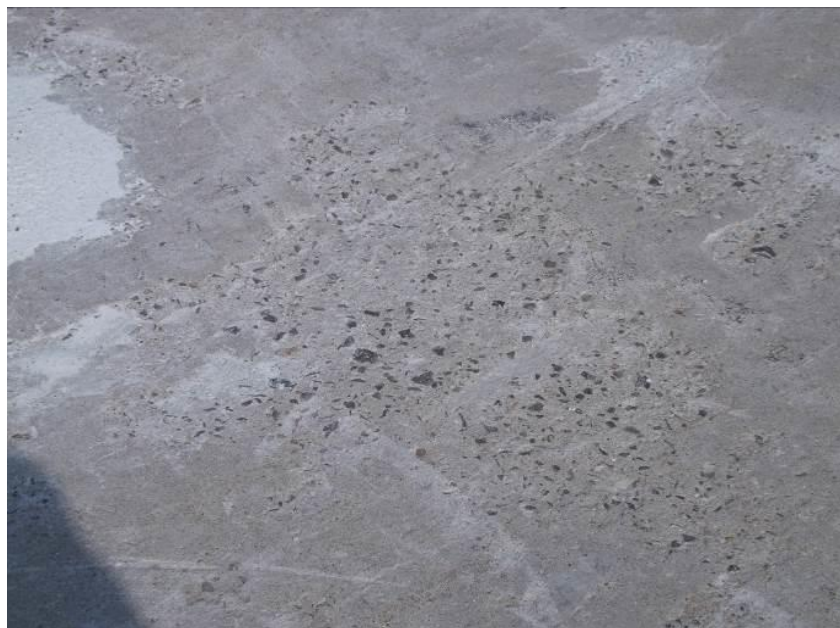
Foto 06: Observa-se a abrasão de superfície com exposição de agregados
