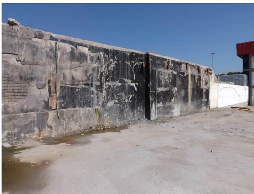
Foto 01: Efeito de altas temperaturas sobre o concreto.
