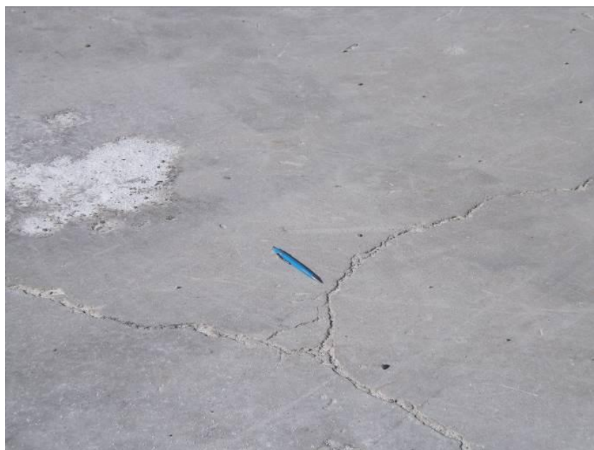
Foto 07: Fissuração térmica no piso de concreto após sinistro.
