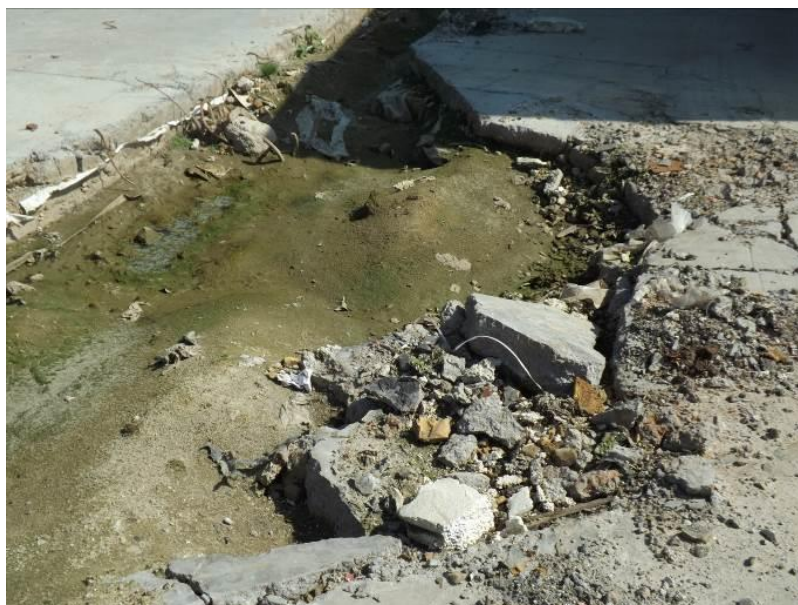
Foto 14: Vista da avaria causada após o incêndio. Nota-se o piso completamente quebrado.
