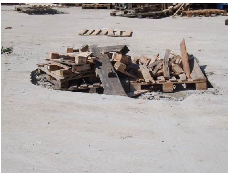
Foto 15: Afundamento do piso ocasionando o colapso do concreto devido à circulação de máquinas que removeram os escombros após o incêndio na câmara 2.
