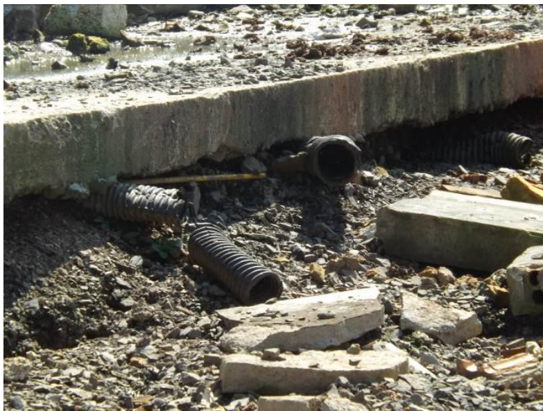
Foto 12: Nesta foto notam-se as avarias no sistema de ventilação forçada do piso, estando completamente comprometida.
