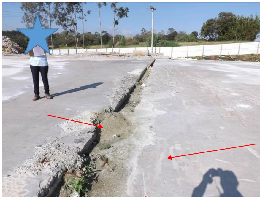
Foto 08: Nesta foto nota-se a ruptura das bordas e o afundamento do piso entre as câmaras.
