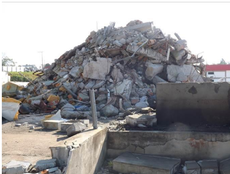
Foto 02: Restos de material inerte após sinistro
