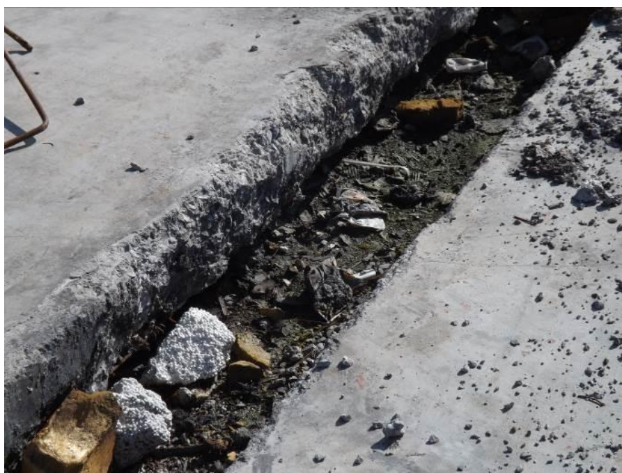
Foto 09: Detalhe dos vãos sob o piso onde ocorreram às infiltrações e acúmulo de chorume no solo.
