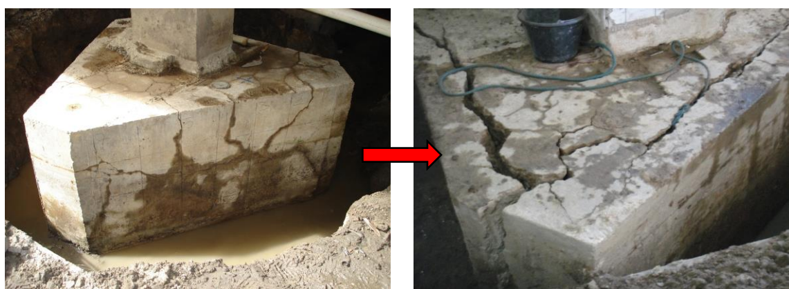
Figura 4 – Quadro fissuratório intenso em blocos de fundação de edificação na Região Metropolitana do Recife – PE (ANDRADE, 2006).
