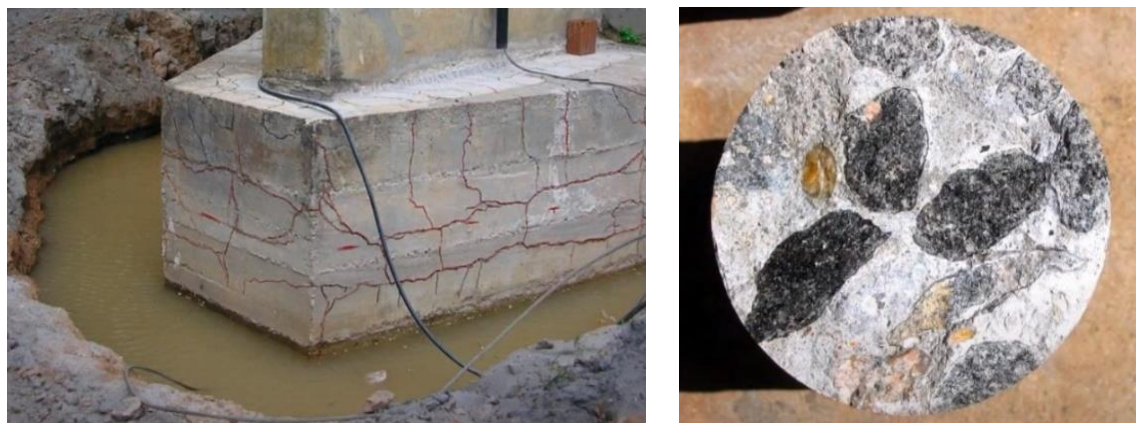
Figura 10 – Bloco de fundação de um edifício em Recife/PE, com fissuras devido à RAA. (ABCP, 2020)
