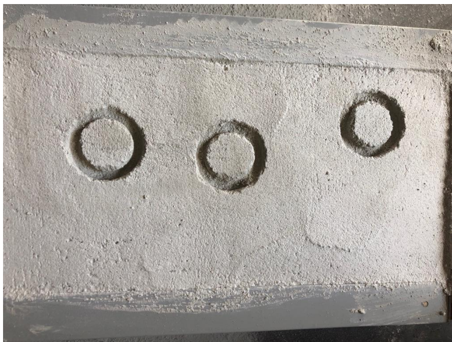
Figura 32 Vista superior – cortes na argamassa
