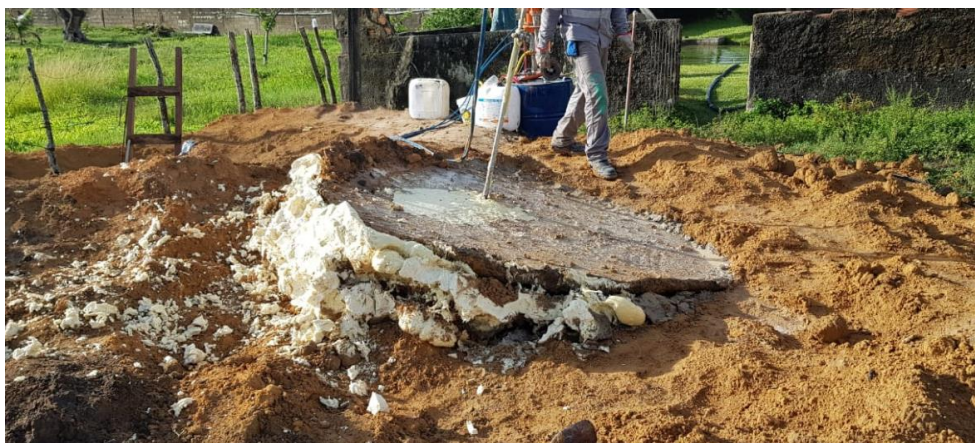
Figura 27 – Resultado da aplicação após a expansão do PU, deslocamento da placa de concreto.
