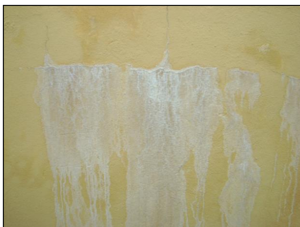
Figura 4. Eflorescência: cristalização dos sais solúveis na superfície da argamassa (FERREIRA, 2010, p. 94)
