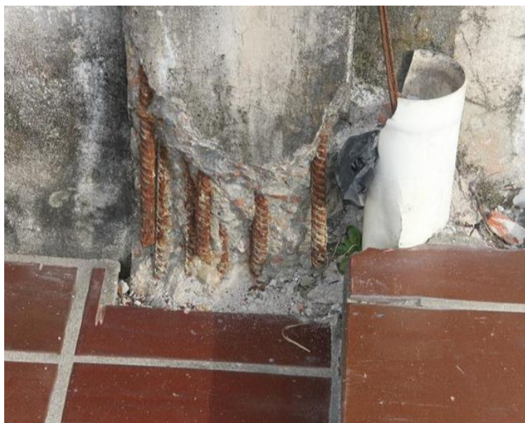
Figura 5 - Corrosão de armadura e deslocamento de concreto em base de pilar de uma antiga igreja, em cidade do norte catarinense.
