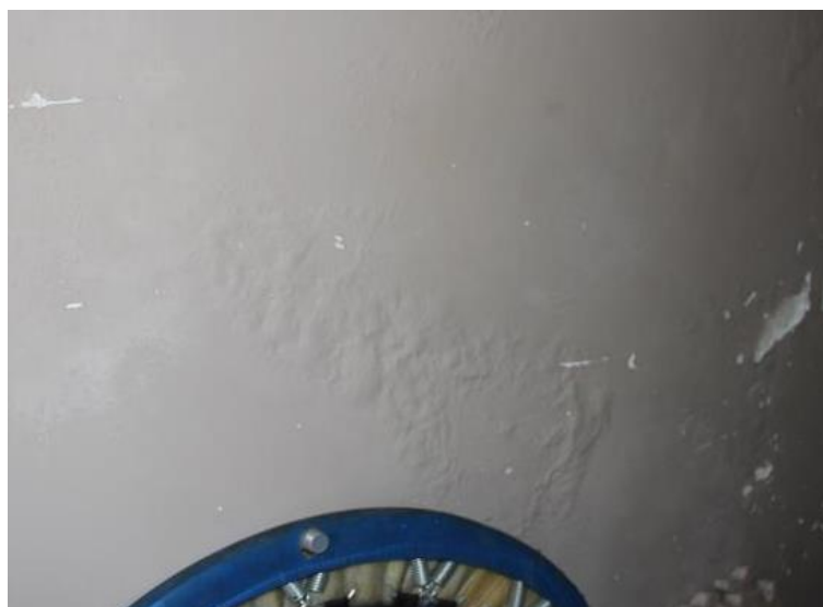
Figura 9 - Formação de bolhas e enrugamento da pintura em parede de edificação. Fonte: Autor (2020).
