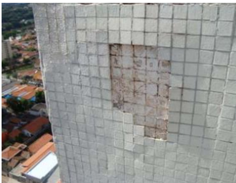
Figura 8 - Deslocamento de cerâmica em fachada de edifício. Fonte: Galletto; Andrello, 2013).
