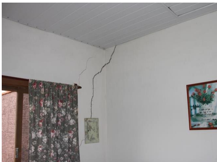
Figura 3 - Fissuração em parede de residência térrea. Fonte: Autor (2020).
