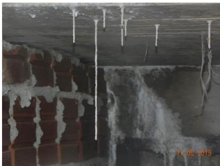
Figura 7 - Formação de eflorescência na parte inferior de uma laje com infiltração. Fonte: Autor (2020).
