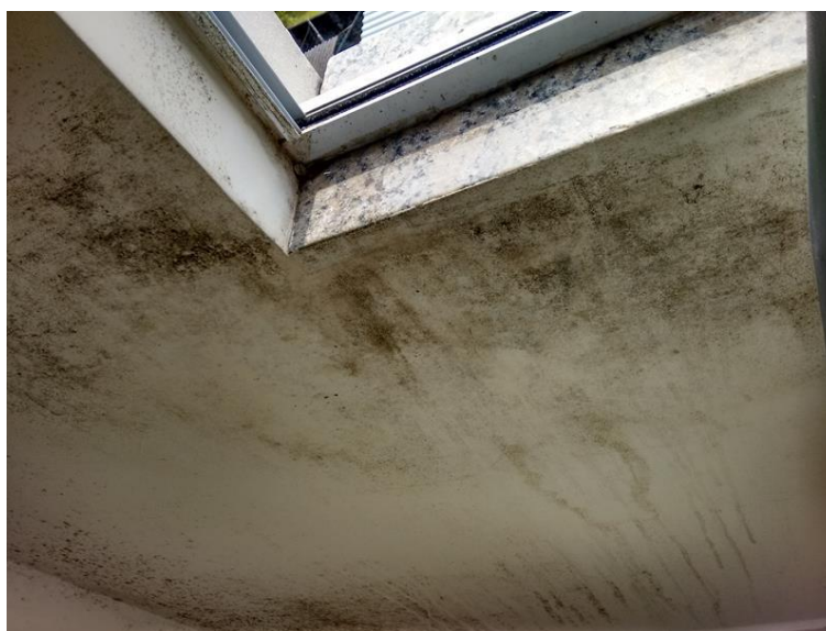
Figura 6 - Incidência de umidade em parede interna de apartamento. Fonte: Autor (2020).
