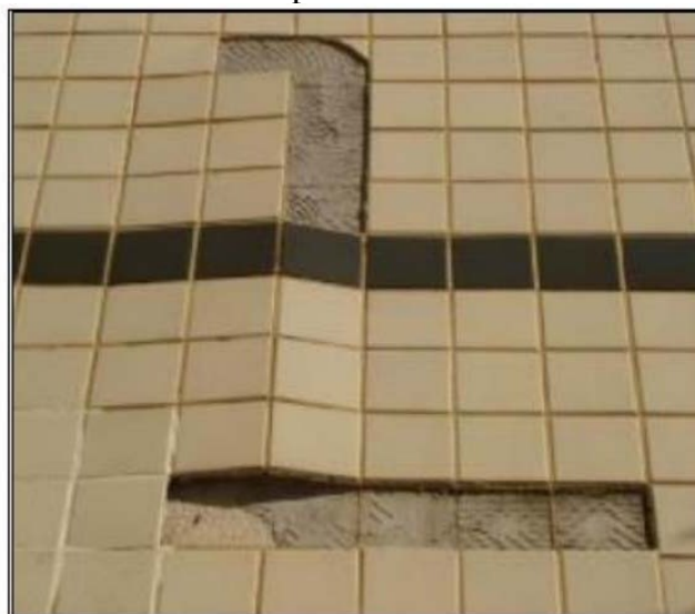
Figura 2 - Descolamento e deslocamento de revestimento cerâmico.
