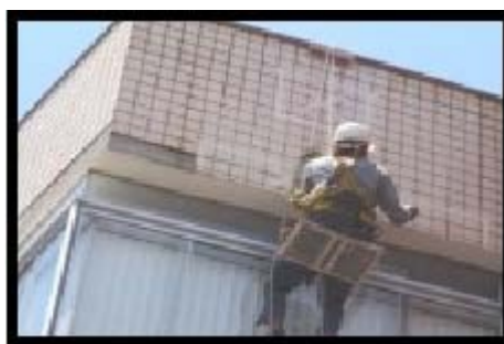
Figura 6 – Teste de percussão em fachada.
