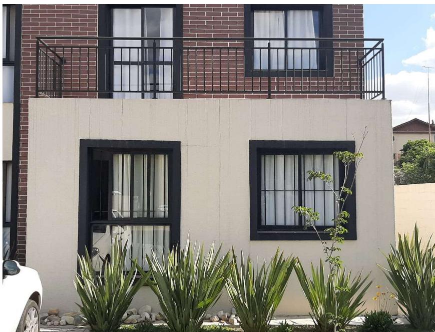
Figura 13 – Ausência de rufo
