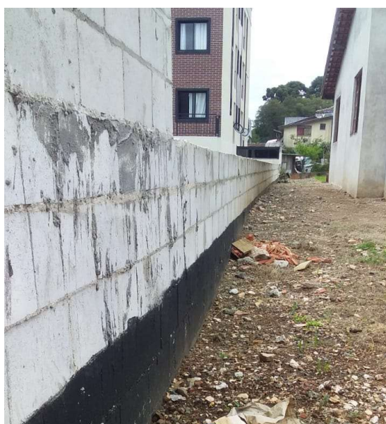
Figura 12 – Falta de impermeabilização
