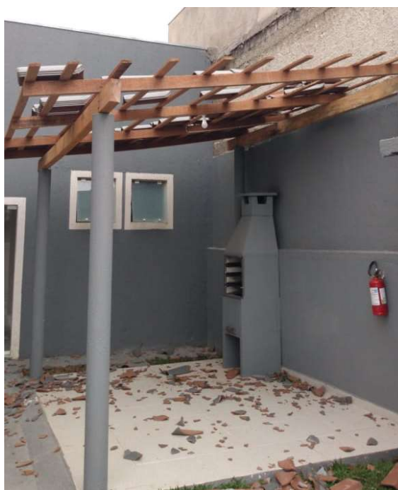
Figura 8 – Colocação incorreta das telhas
