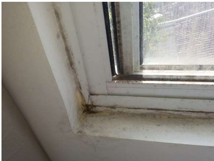
Figura 9 – Problema de vedação na esquadria
