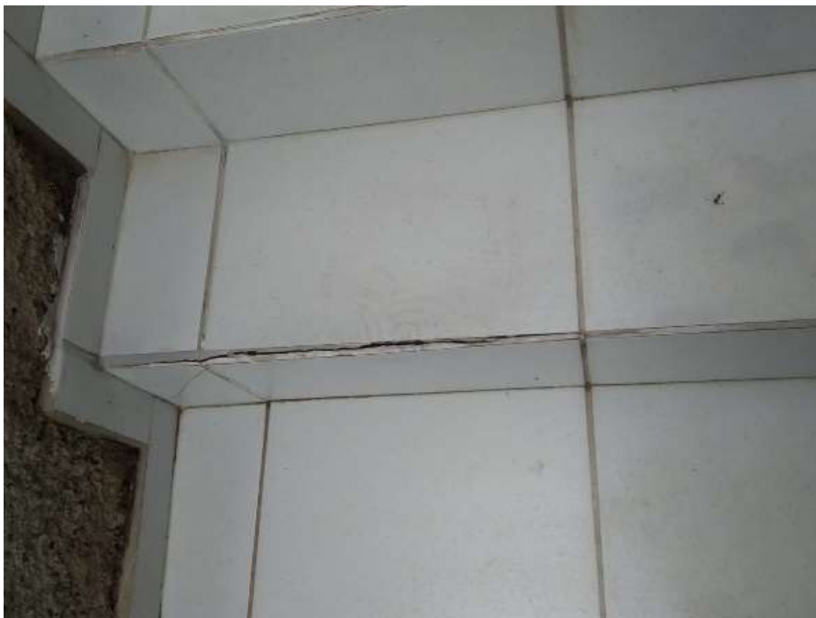
Figura 6 – Descolamento da placa cerâmica
