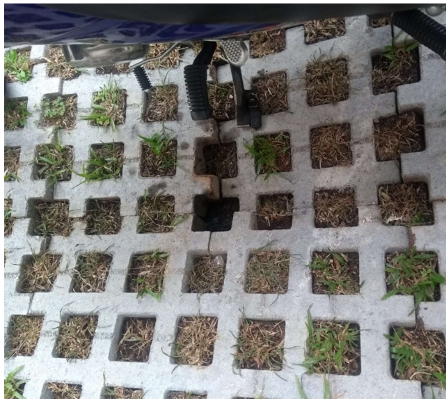
Figura 7 – Recalque do piso
