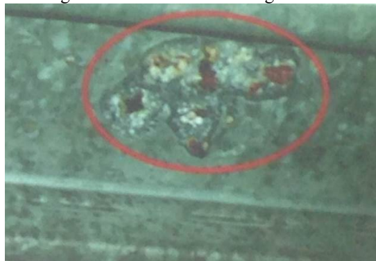
Figura 4: Corrosão em telhas galvanicas
