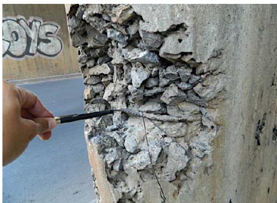
Figura 13: falhas de concretagem ( Fi = 3 )
