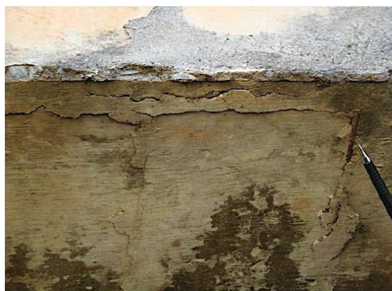
Figura 2: corrosão de armadura ( Fi = 3 )
