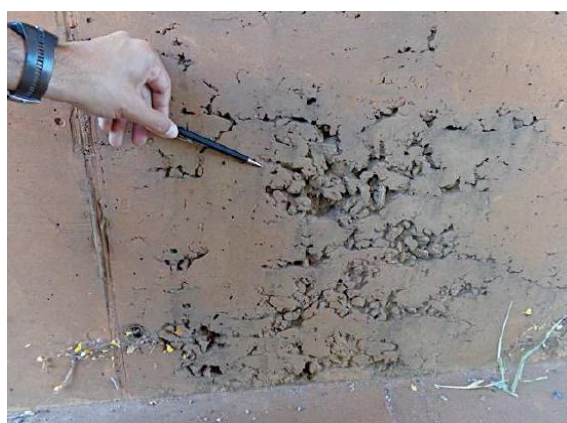
Figura 12: falhas de concretagem ( Fi = 2 )
