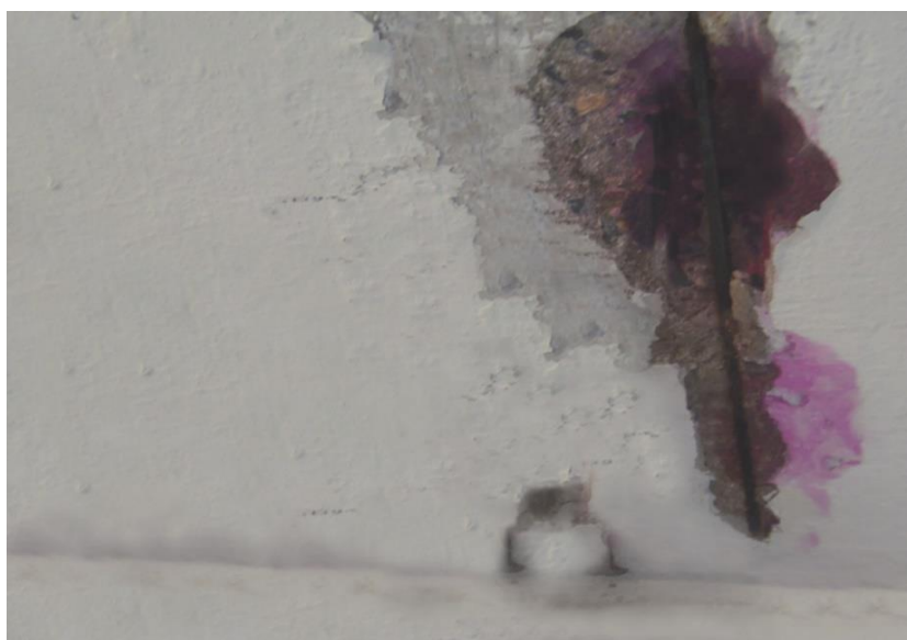
Figura 28. Resultado da realização do Ensaio de Carbonatação, Fachada Lateral face inferior (O Autor, 2019).
