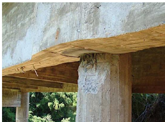
Figura 20: sinais de esmagamento de concreto ( F_i = 4 )
