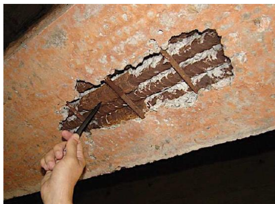
Figura 14: falhas de concretagem ( Fi = 3 )
