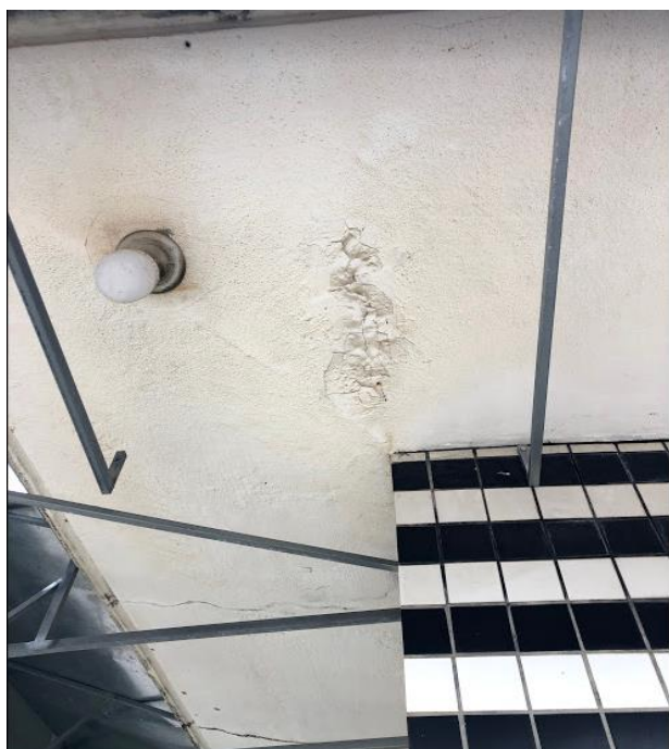
Figura 17. Manchas de Infiltração na Fachada Frontal (O Autor, 2019).
