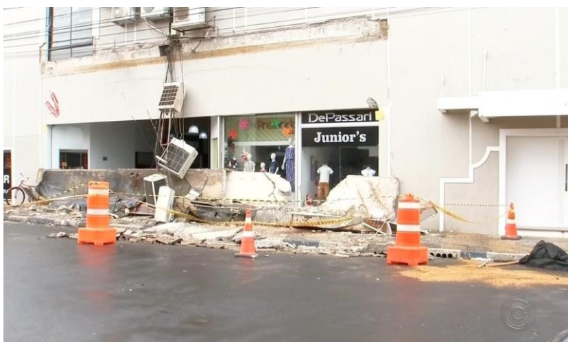
Figura 5. Queda de marquise do shopping center em Penápolis (G1 SP, 2019).
