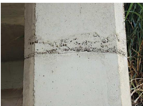
Figura 11: falhas de concretagem ( Fi = 1 )
