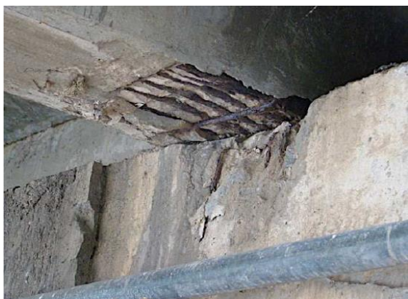
Figura 19: sinais de esmagamento de concreto ( F_i = 4 )
