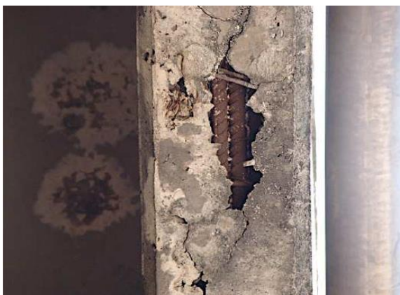
Figura 1: corrosão de armadura ( Fi = 2 )
