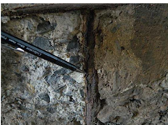
Figura 3: corrosão de armadura ( Fi = 4 )
