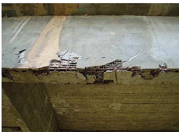
Figura 15: falhas de concretagem ( Fi = 4 )
