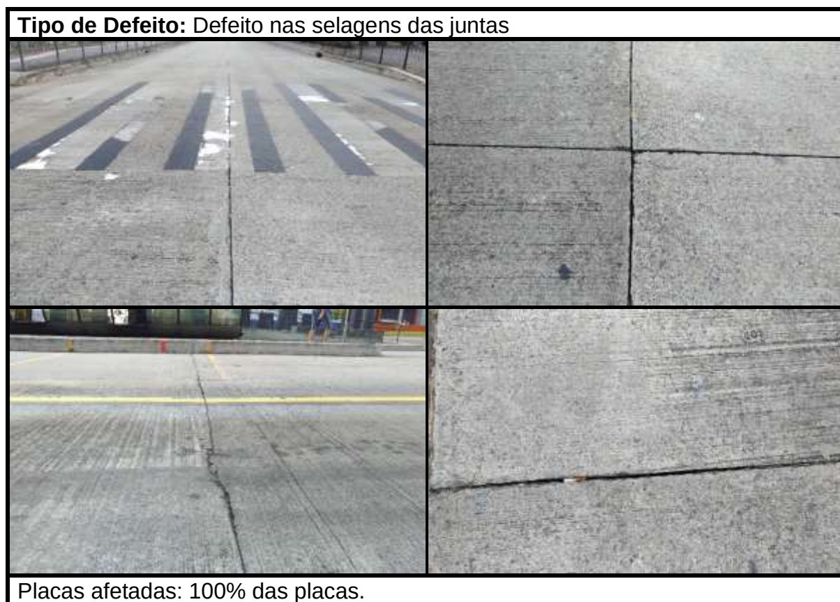
Quadro 9 - Defeito nas selagens das juntas
