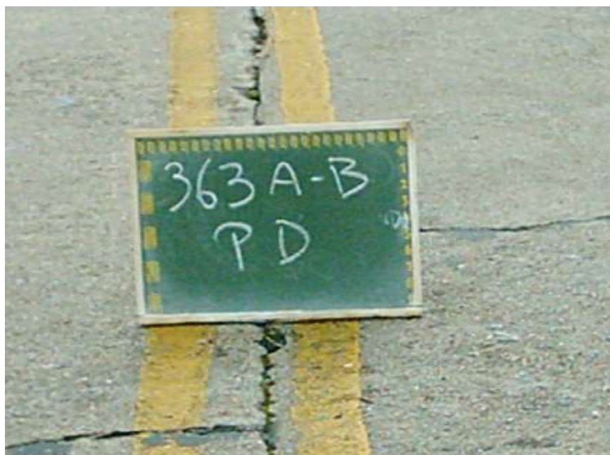
Foto 04: Falha na Selagem das Juntas
