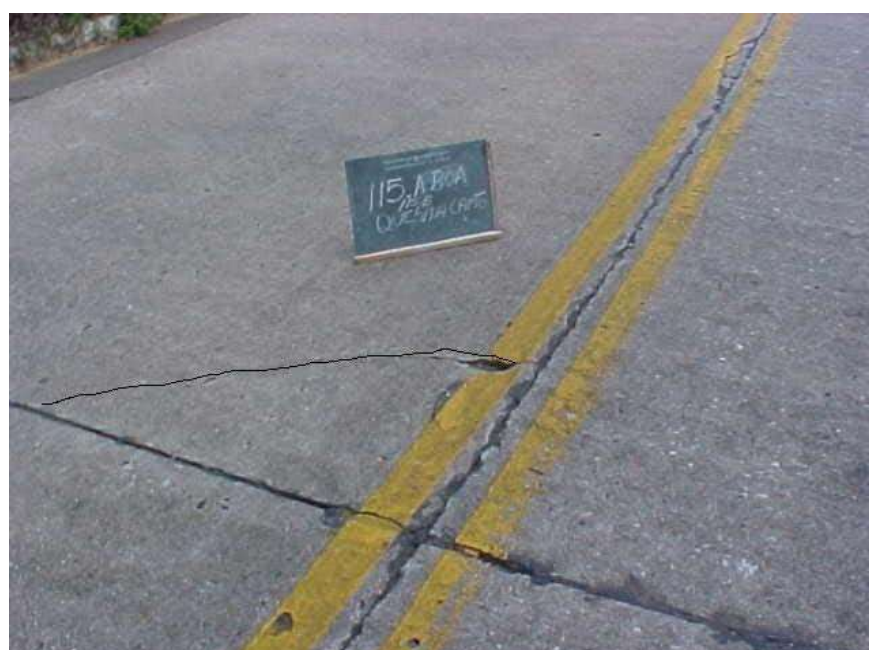
Foto 02: Fissuras de Canto
