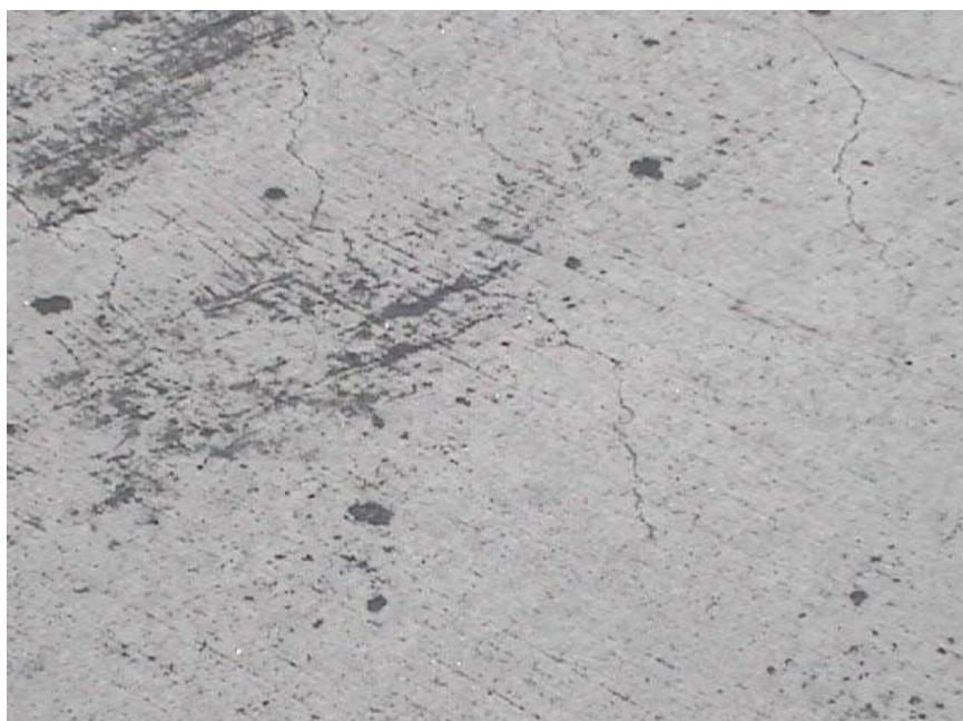
Figura 13: Fissura de Retração Plástica
