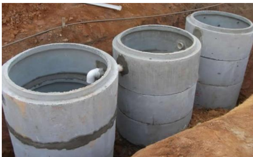
Figura 35 – Tanque de decantação Fonte: Acervo pessoal do autor, 2019
