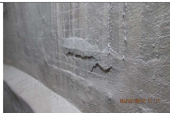
Foto 13 - Parede interna com deslocamento do concreto.
