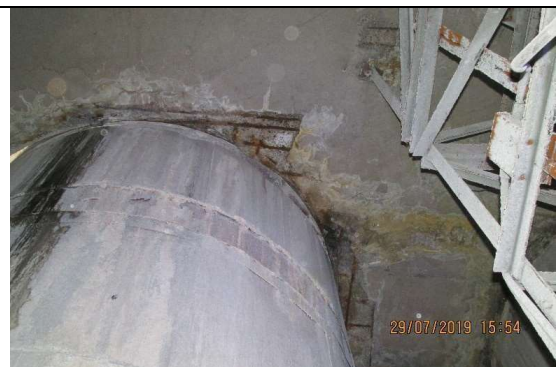
Foto 5 - Deslocamento do concreto e corrosão das armaduras.
