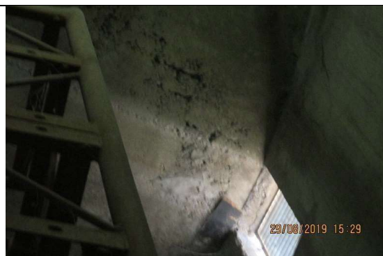
Foto 14 - Pontos de segregação no concreto da laje teto.
