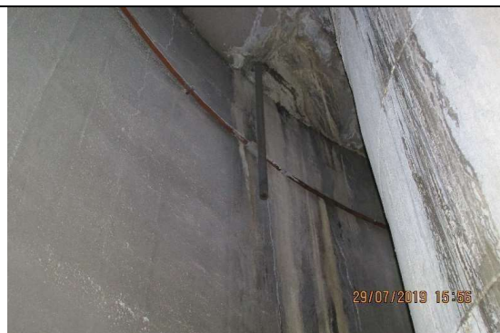
Foto 6 – Processo de lixiviação do concreto.
