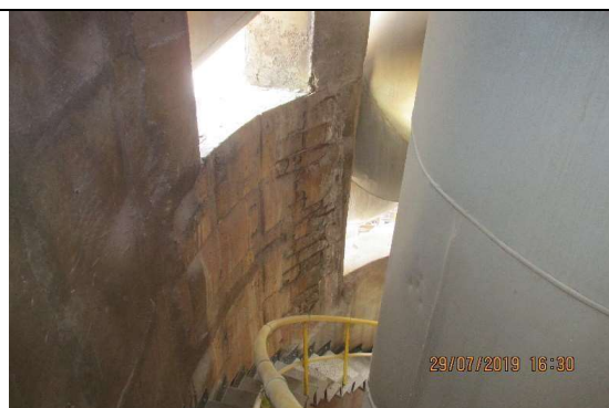
Foto 8 – Parede interna com armaduras com baixo cobrimento.
