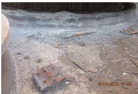
Foto 1 – Sinais de lixiviação e impregnações de sais na mureta.
