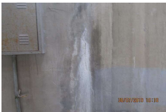
Foto 2 – Fissura com manchas de percolação de água e eflorescência.
