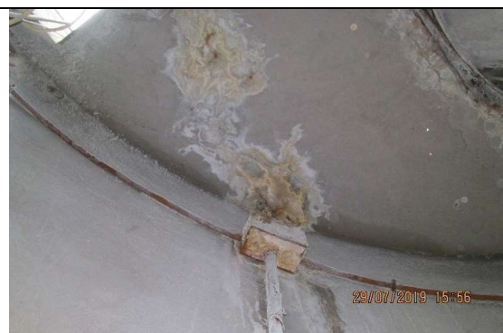
Foto 7 – Evidência de umidade e eflorescência.
