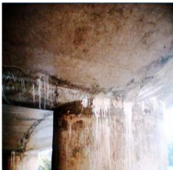
Figura 7 – Eflorescências em peça de concreto armado
