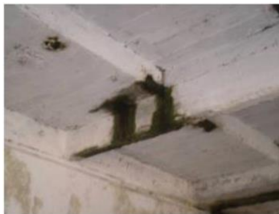
Figura 4 – Manchas em estruturas de concreto do Presídio de Porto Alegre
