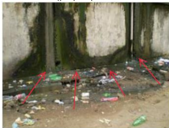
Figura 3 – Vazamento de esgoto pelas paredes do Presídio de Porto Alegre
