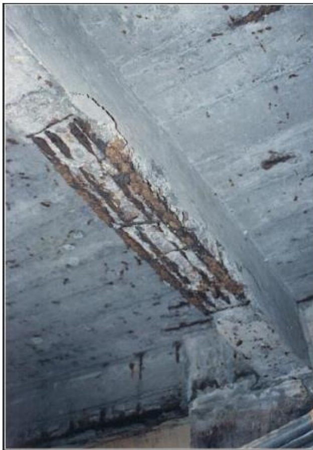
Figura 8 – Viga de concreto armado com corrosão generalizada e lascamento
