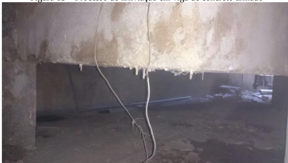
Figura 15 – Processo de lixiviação em viga de concreto armado
