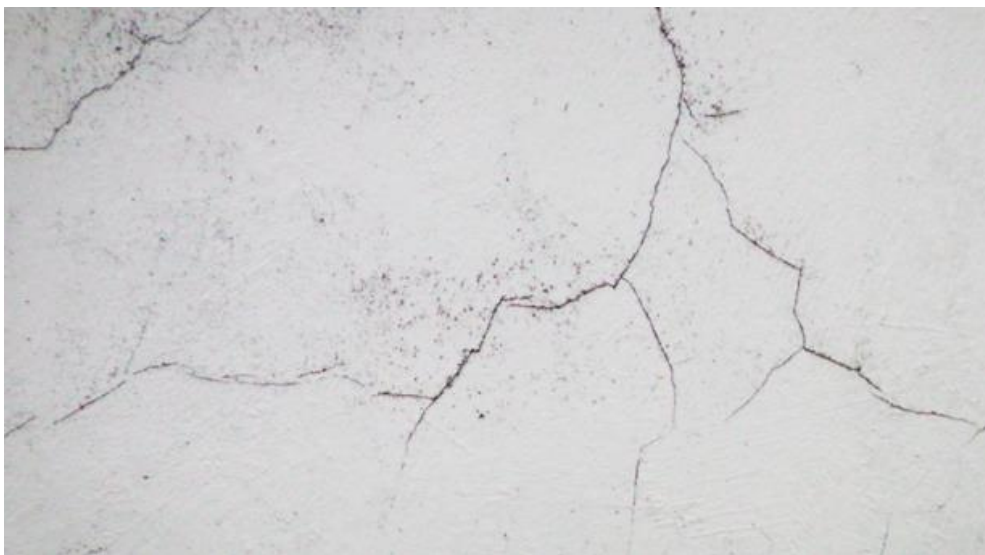
Figura 6 – Trincas em peça de concreto armado
