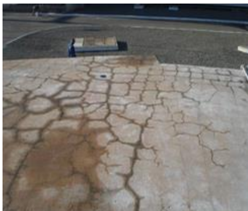
Figura 12 – Fissuras devido reação álcali-agregado
