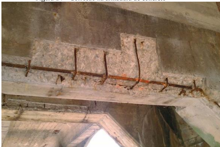
Figura 14 – Corrosão na armadura de concreto
