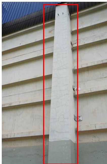
Figura 50. Tipologia de fissuras identificadas pelo número “5” (cinco) em legenda convencionada (AUTOR, 2019).
