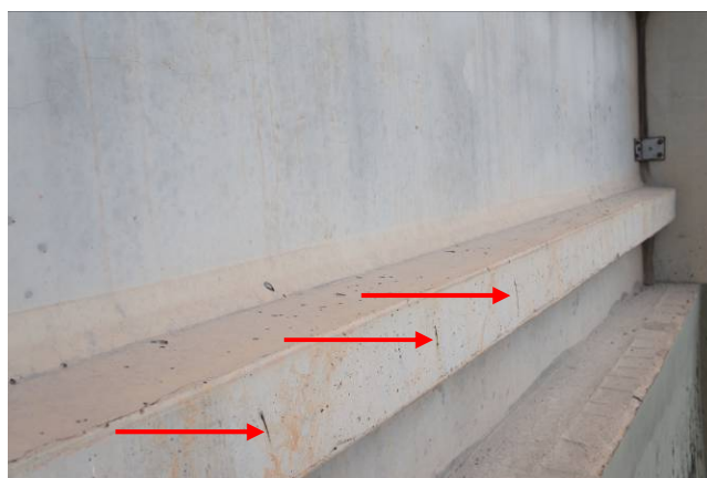
Figura 48. Tipologia de fissuras identificadas pelo número “3” (três) em legenda convencionada (AUTOR, 2019).
