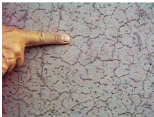
Figura 20. Fissura típica por ataque de sulfato (FELSKE et al., 2016).
