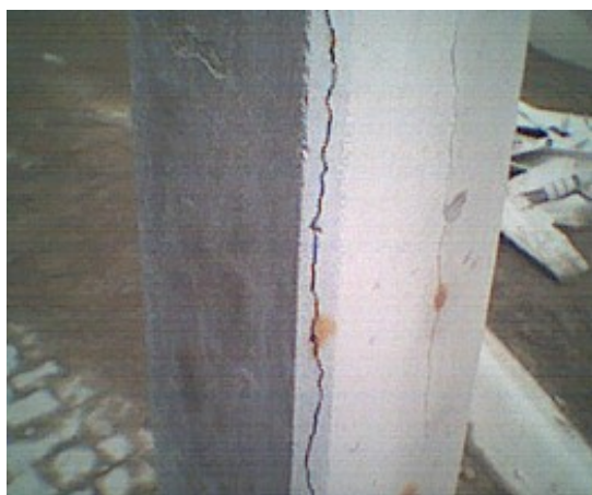
Figura 19. Fissura típica e destacamento por corrosão de armadura (FELSKE et al., 2016).
