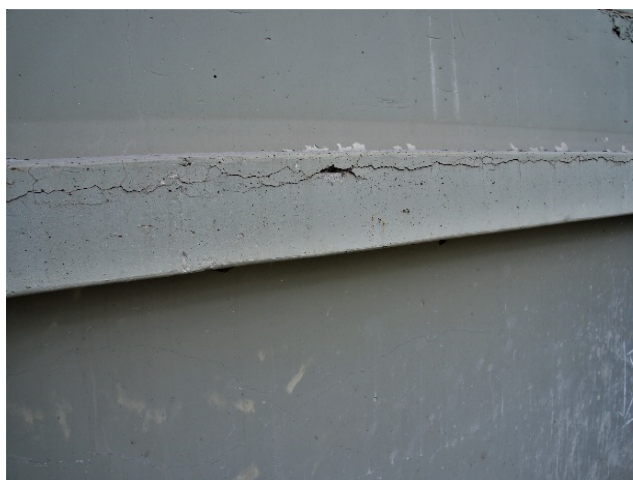
Figura 52. Fissuras em painel vertical pré moldado devido à corrosão de armadura (AUTOR, 2019).
