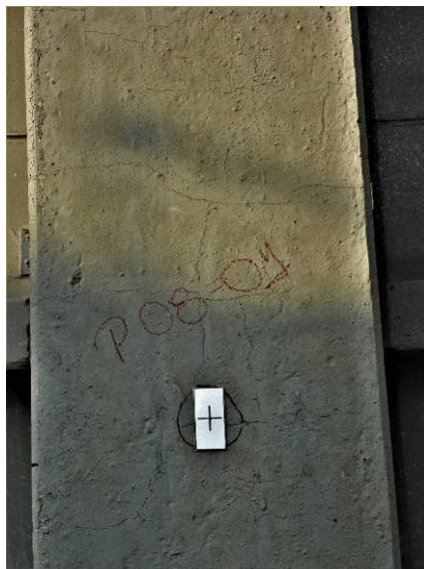
Figura 58. Fissuras tipo pele de crocodilo em pilar pré moldado (AUTOR, 2019).
