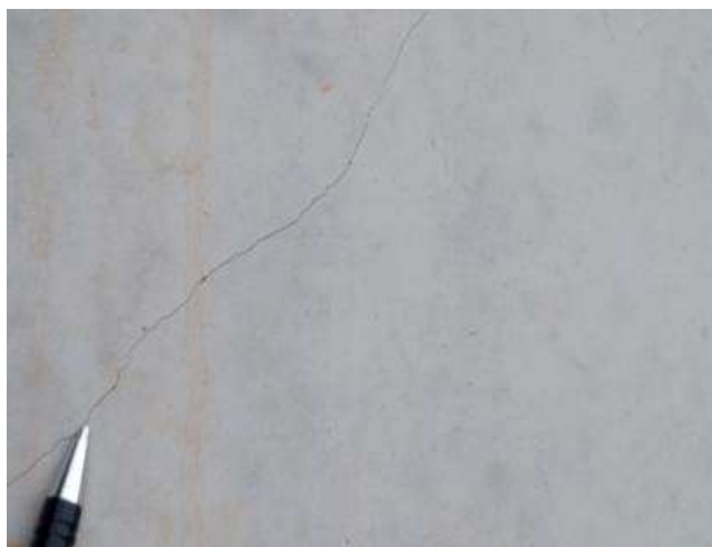
Figura 54. Fissuras diagonais registradas em painéis verticais a partir de seus vértices por excesso de carga (AUTOR, 2019).
