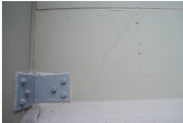
Figura 49. Tipologia de fissuras identificadas pelo número “4” (quatro) em legenda convencionada (AUTOR, 2019).
