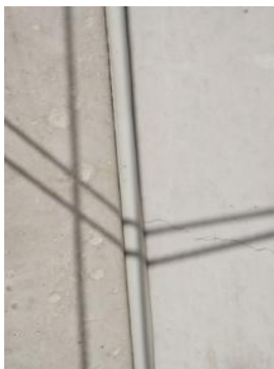
Figura 56. Detalhe de esmagamento de juntas entre pilares e painéis verticais (AUTOR, 2019).
