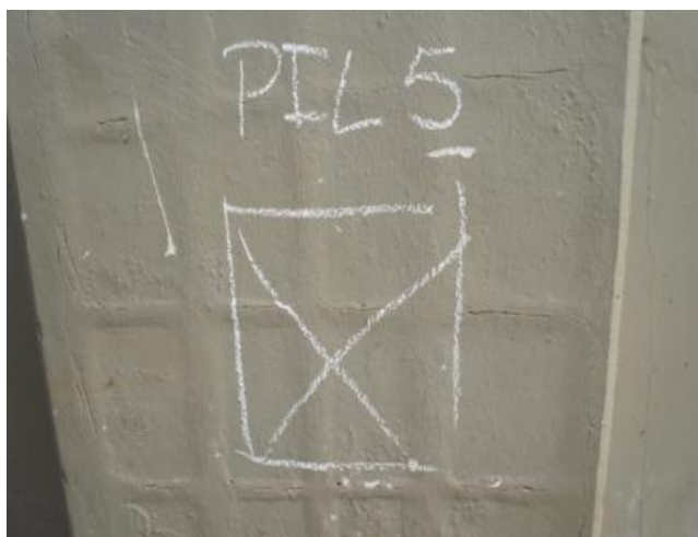
Figura 51. Fissuras em pilar pré moldado por assentamento plástico (AUTOR, 2019).
