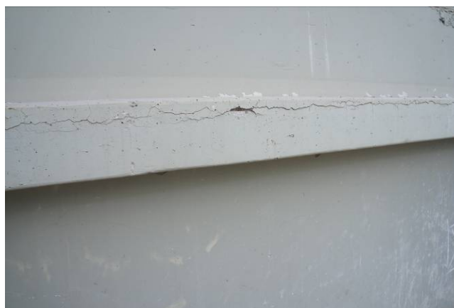
Figura 47. Tipologia de fissuras identificadas pelo número “2” (dois) em legenda convencionada (AUTOR, 2019).
