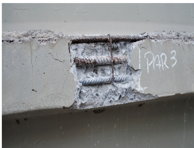
Figura 53. Detalhe de abertura de janela de inspeção em painel vertical pré moldado com fissuras e destacamento devido ao processo de corrosão de armaduras (AUTOR, 2019).
