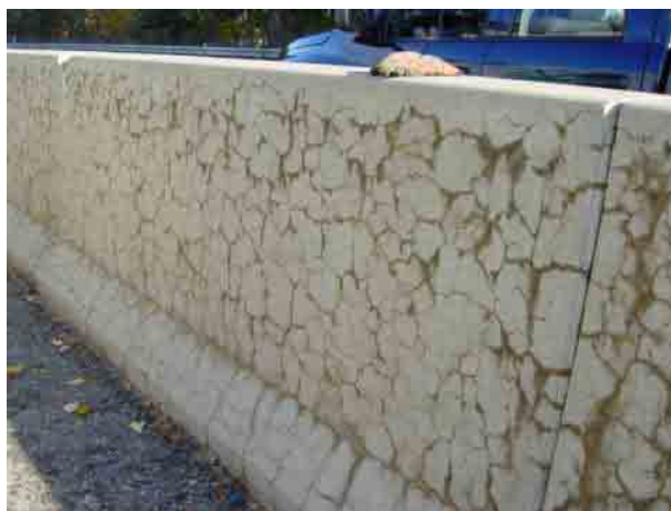
Figura 21. Fissuras típica por reação álcali-agregado (WIKIPEDIA, 2020).
