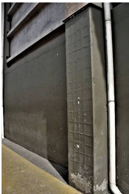
Figura 46. Tipologia de fissuras identificadas pelo número “1” (um) em legenda convencionada (AUTOR, 2019).
