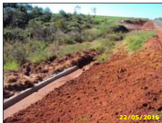
Figura 25 – Drenagem assoreada, Km 139+965.
