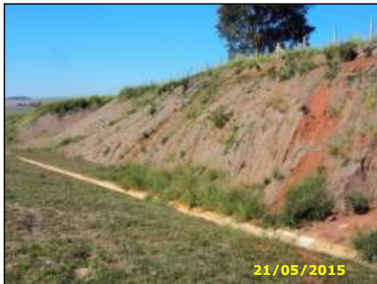
Figura 34 – Enleivamento parcial do solo, Km 141+280.
