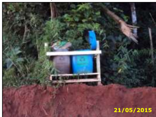
Figura 62 – Lixeiras coloridas para triagem de resíduos sólidos, km 133+000.
