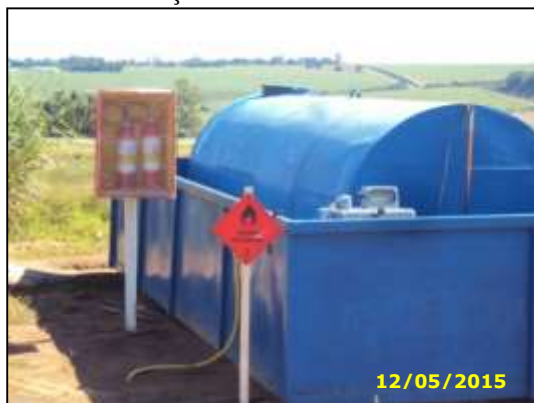
Figura 74 – Extintores de incêndio, sinalização e bacia de contenção.
