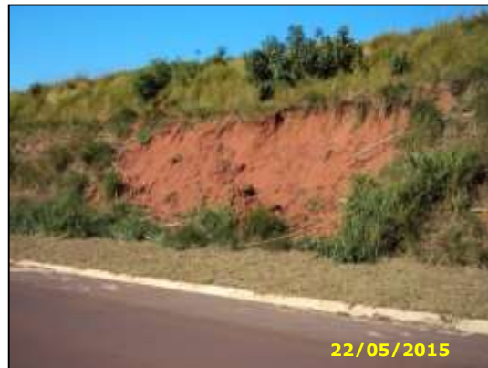
Figura 35 – Movimentação de massa em talude de corte, Km 142+860.
