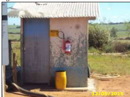
Figura 50 – Extintor de incêndio.
