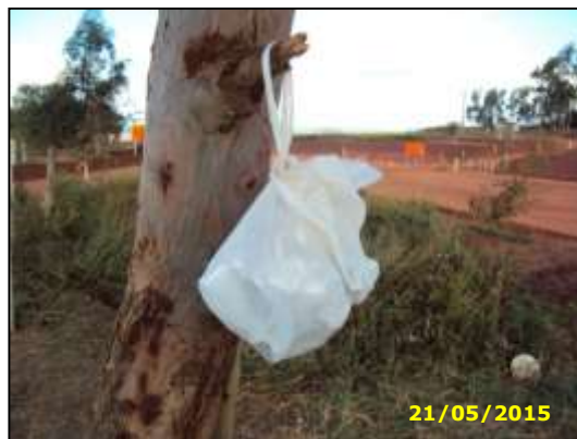
Figura 63 – Resíduos sólidos na frente de obras, km 127+700.
