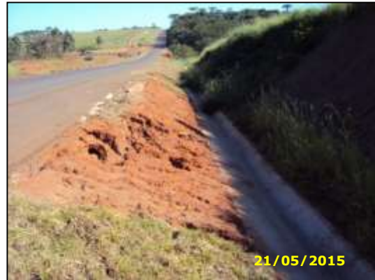
Figura 21 – Solo exposto e drenagem superficial (VPA), Km 143+500.
