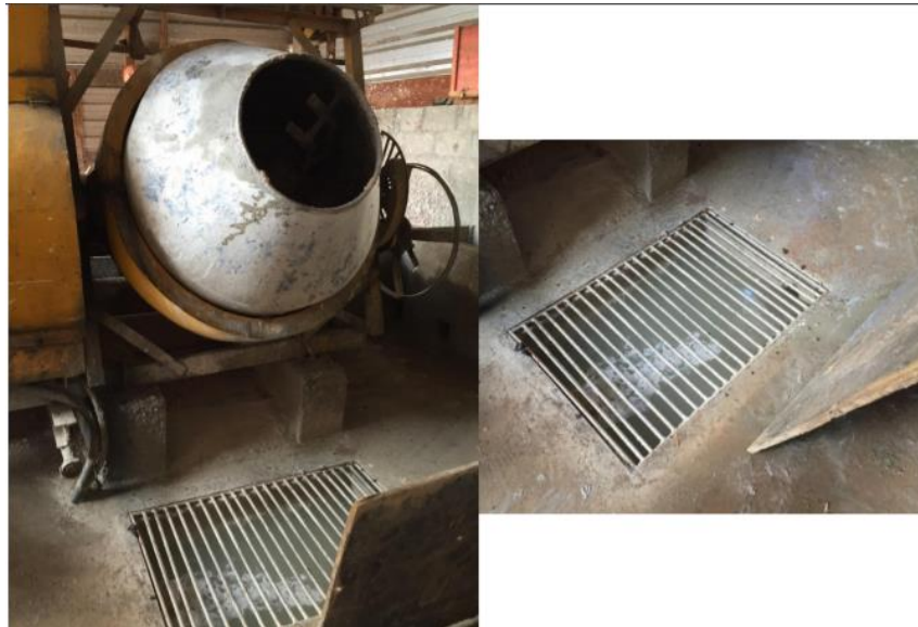
Figura 121 - Decantador em Obra Fonte: A.Yoshii Engenharia (2018)
