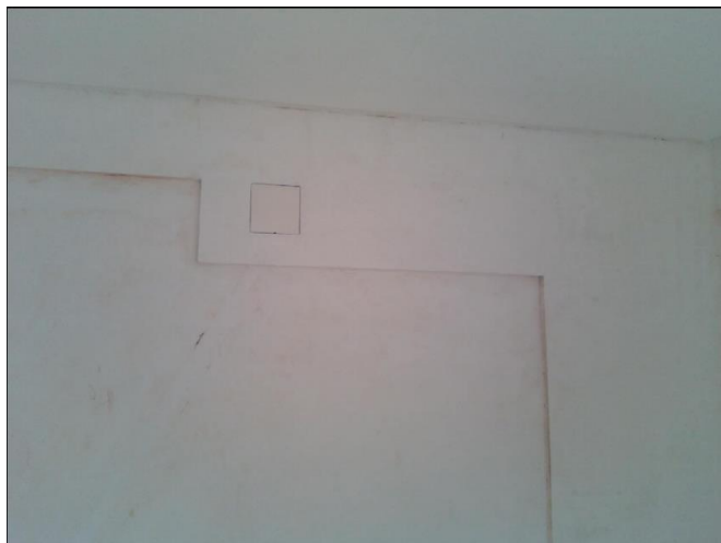
Figura 78 - Saliência de vigas em relação às paredes (situação a ser evitada) Fonte: Sousa (2010)
