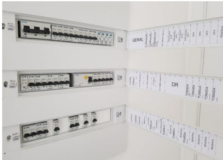
Figura 5 - Quadro Elétrico Instalado
