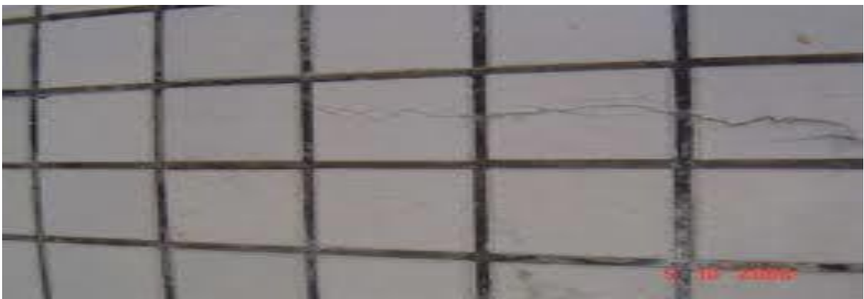
Figura 12 . Fissura de placas cerâmica – Fonte Google
