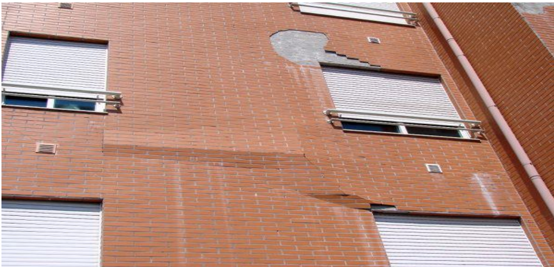
Figura 11.Desplacamento de cerâmica. Fonte: www.cimentoitambé.com.br
