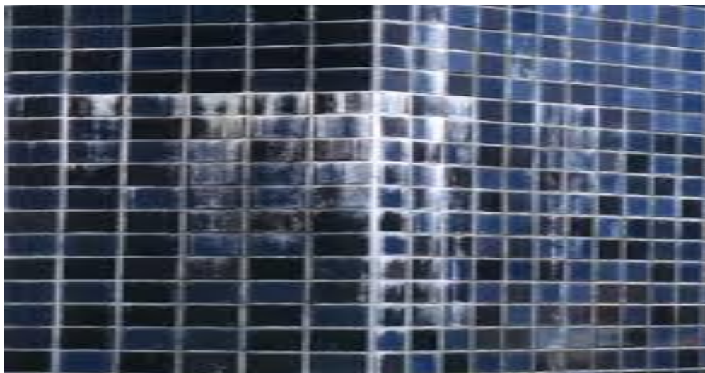
Figura 10- Eflorescência na Edificação - Fonte ; Thomaz (sd)
