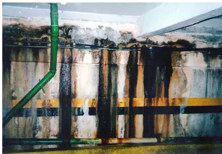
Figura 3. Garagem em Subsolo com incidência de Carbonatação (ARAKI ENGENHARIA, 2018, s.p.)
