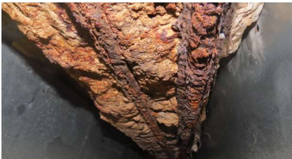
Figura 2. Exposição da Armadura Pós Deslocamento do Concreto (ARAKI ENGENHARIA, 2018, s.p.)
