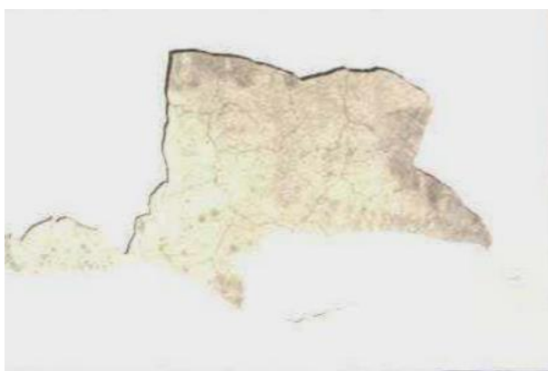
Figura 19 - Fissuras decorrentes da retração da argamassa provocadas pela falha da pintura e exposição contínua da parede a água da chuva.
