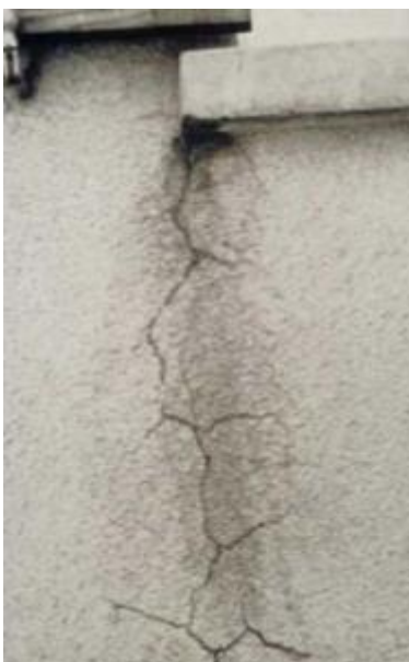
Figura 20 - O fluxo de água interceptado do peitoril da janela escorre lateralmente, provocando a fadiga do reboco desenvolvendo sua fissuração.
