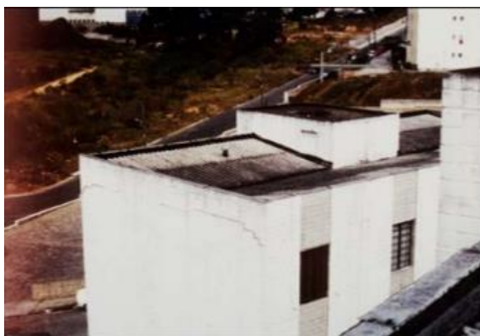
Figura 18 – Típica fissura no topo da parede e destacamento da platibanda por movimentações térmicas da laje.
