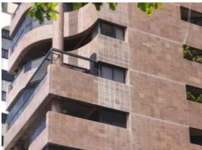
Figura 29 - Eflorescência em fachada. Fonte: LOPES, FONSÊCA, NEVES, FREITAS, & SILVA (2018)
