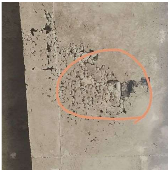
Figura 10 - Concreto segregado (pikgram.com, acessado 05/2019)
