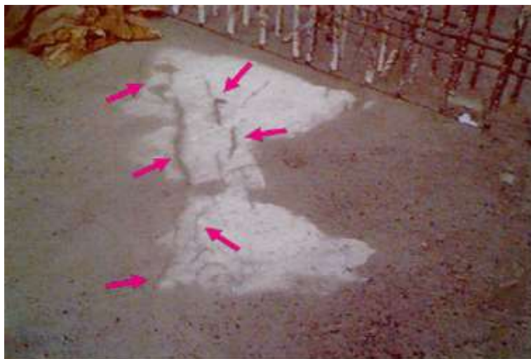
Figura 3 - Fissura de Retração Plástica - antes do endurecimento do concreto (ANTÔNIO & RECENA, 2014)
