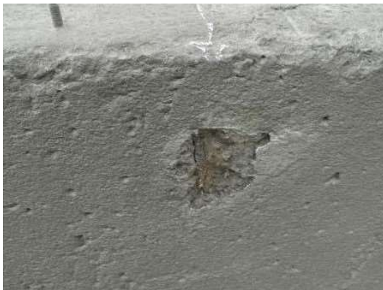
Figura 12 - Concreto disgregado com armadura exposta e corroída (FOTOGRAFADO PELO AUTOR, 2019)
