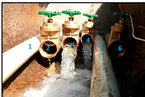
Figura 9: Desemboque galeria – Posicionamento das tubulações
