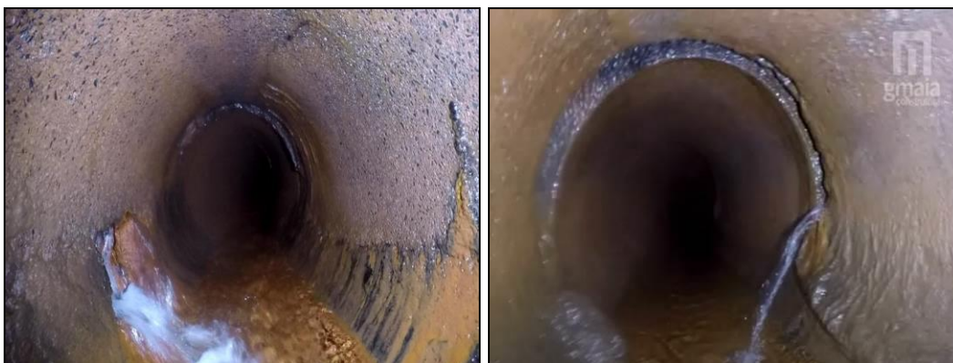
Figura 7: Patologias na estrutura da galeria pré-fabricada
