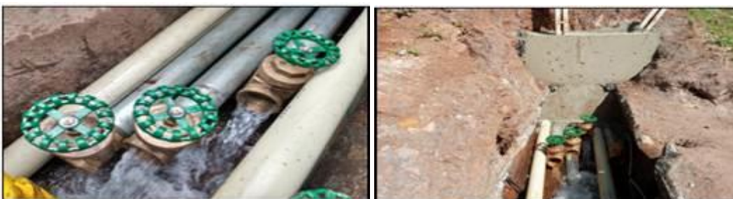
Figura 17: Desemboque da galeria – Sistema de tubos em operação
