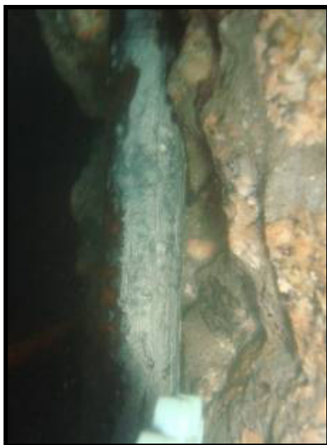
Foto 11 – Coloração típica da armadura
