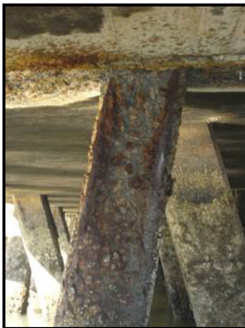
Foto 2 – Estaca tipo 1, antes do reparo.
