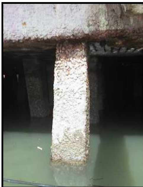
Foto 1 – Estaca tipo 1, antes do reparo
