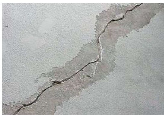
Figura 3: Fissura geométrica Fonte: CORSINI, 2010
