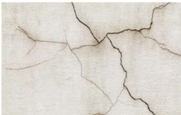
Figura 4: Fissura mapeada Fonte: CORSINI, 2010
