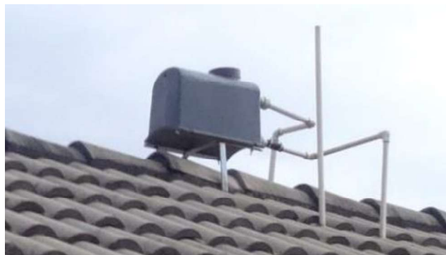
Figura 16: Reservatório térmico Fonte: AUTORAS, 2019
