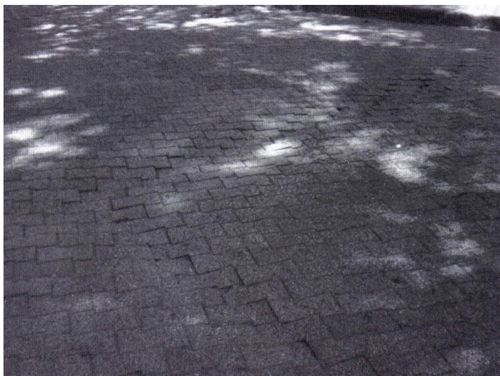
Figura 32. Correção com material diferente – grau de severidade alto (Interlocking Concrete Block Pavement Distress Guide, 2007)
