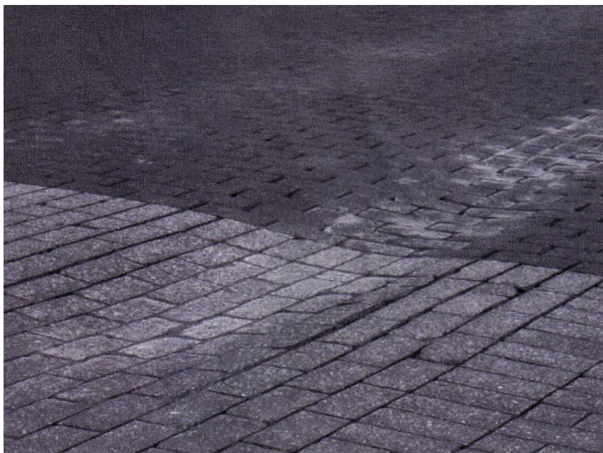
Figura 35. Trilhos ou Sulcos – grau de severidade alto (Interlocking Concrete Block Pavement Distress Guide, 2007)
