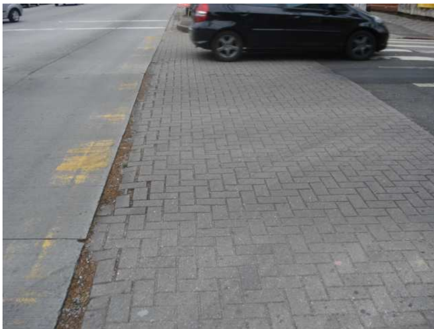
Figura 56: Cruzamento da Av. Iguaçu com a Rua Saint Hilaire (faixa dir.), condição péssima.
