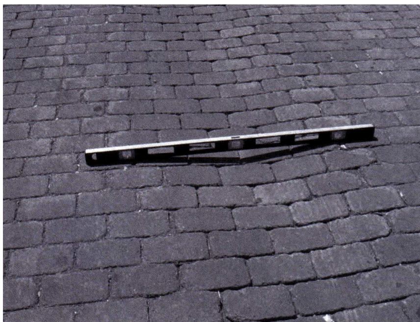
Figura 34. Trilhos ou Sulcos – grau de severidade alto (Interlocking Concrete Block Pavement Distress Guide, 2007)
