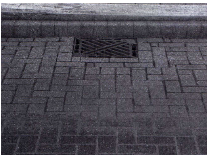
Figura 18. Hasteamento– grau de severidade baixo (Interlocking Concrete Block Pavement Distress Guide, 2007)
