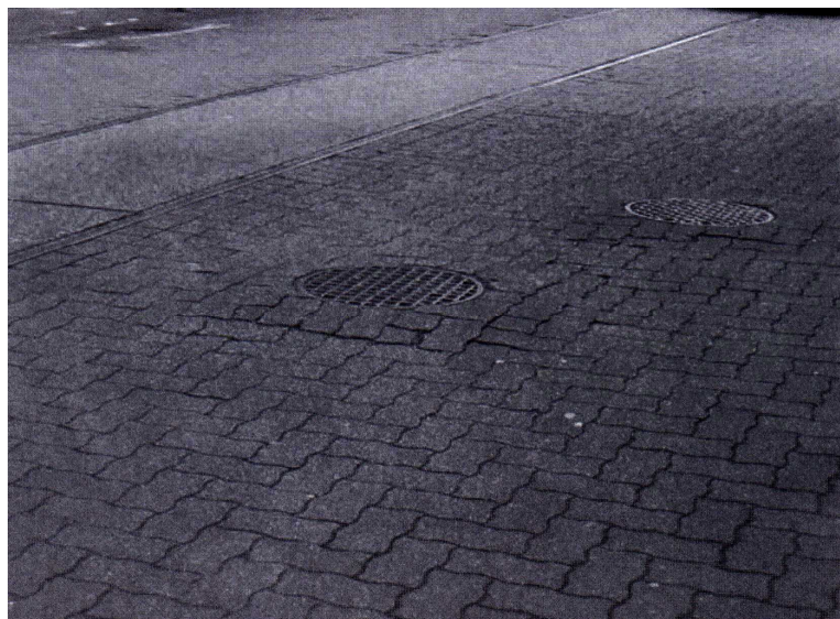
Figura 19. Hasteamento– grau de severidade médio (Interlocking Concrete Block Pavement Distress Guide, 2007)
