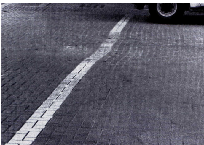
Figura 8. Depressão – grau de severidade médio(Interlocking Concrete Block Pavement Distress Guide, 2007)
