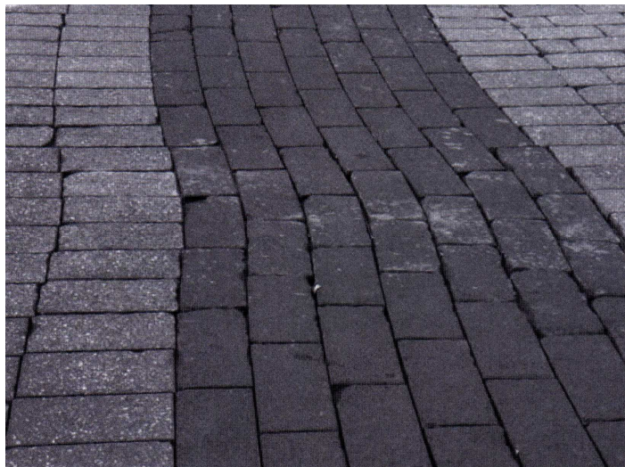
Figura 23. Deslocamento— grau de severidade alto (Interlocking Concrete Block Pavement Distress Guide, 2007)
