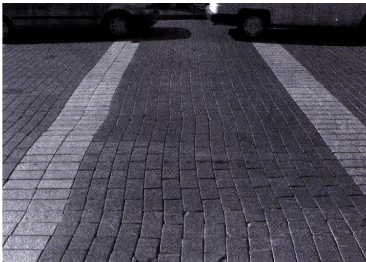
Figura 33. Trilhos ou Sulcos – grau de severidade alto (Interlocking Concrete Block Pavement Distress Guide, 2007)
