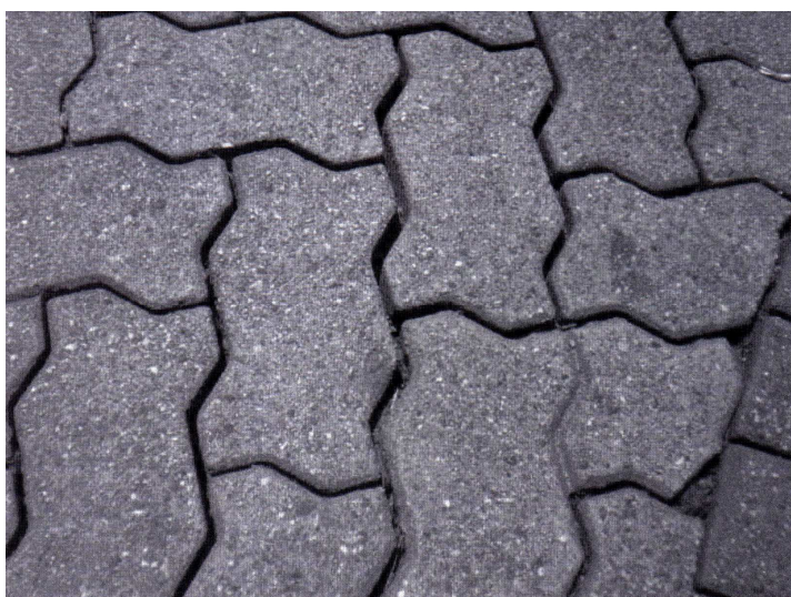
Figura 26. Perda de areia por bombeamento– grau de severidade alto (Interlocking Concrete Block Pavement Distress Guide, 2007)
