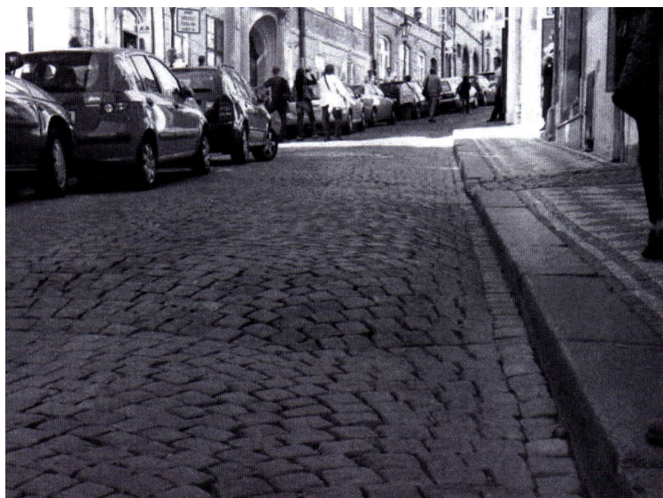
Figura 20. Hasteamento– grau de severidade alto(Interlocking Concrete Block Pavement Distress Guide, 2007)
