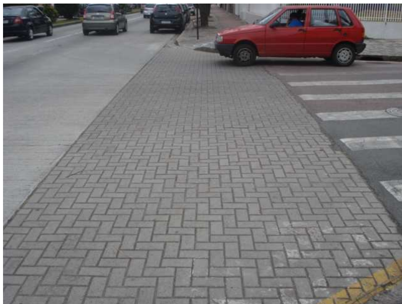
Figura 41: Cruzamento da Avenida Iguaçu com a Rua Buenos Aires, condição muito pobre.
