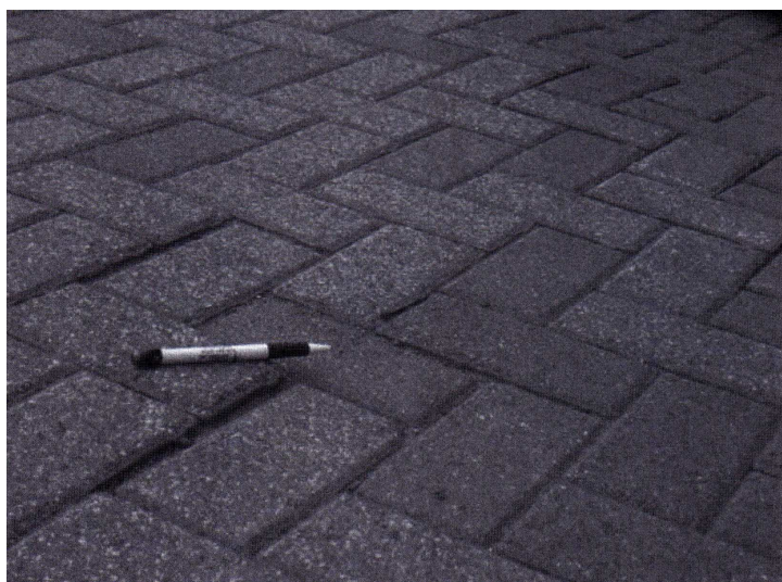
Figura 17. Diferença de Altura entre Blocos Isolados– grau de severidade alto(Interlocking Concrete Block Pavement Distress Guide, 2007)
