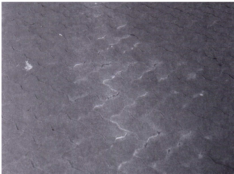
Figura 25. Perda de areia por bombeamento– grau de severidade médio (Interlocking Concrete Block Pavement Distress Guide, 2007)
