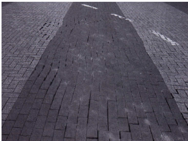
Figura 12. Contenção lateral – grau de severidade alto (Interlocking Concrete Block Pavement Distress Guide, 2007)
