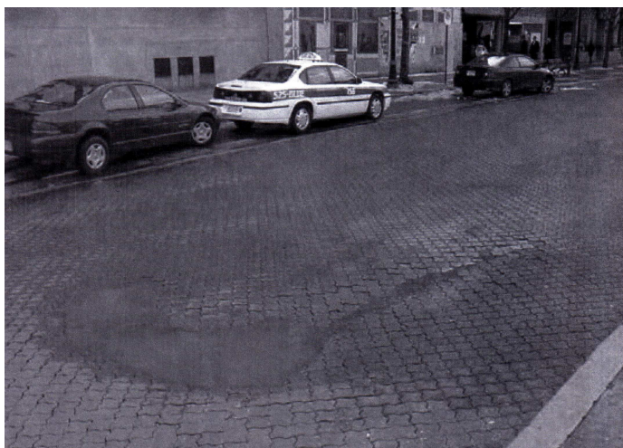
Figura 9. Depressão – grau de severidade alto (Interlocking Concrete Block Pavement Distress Guide, 2007)
