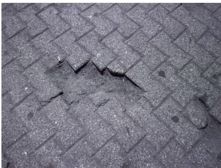
Figura 28. Falta de blocos— grau de severidade médio(Interlocking Concrete Block Pavement Distress Guide, 2007)
