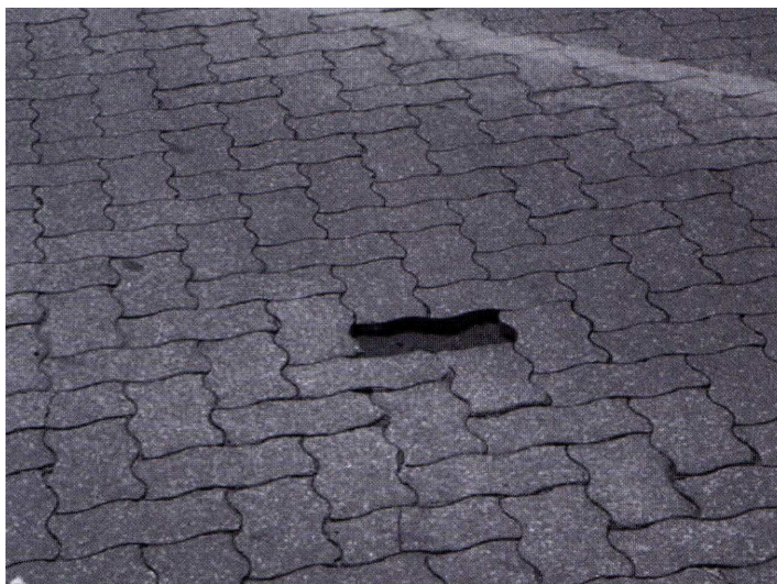
Figura 27. Falta de blocos— grau de severidade baixo(Interlocking Concrete Block Pavement Distress Guide, 2007)
