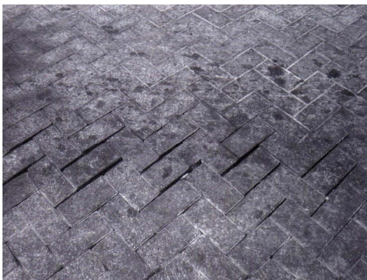
Figura 14. Largura Excessiva das Juntas – grau de severidade médio (Interlocking Concrete Block Pavement Distress Guide, 2007)
