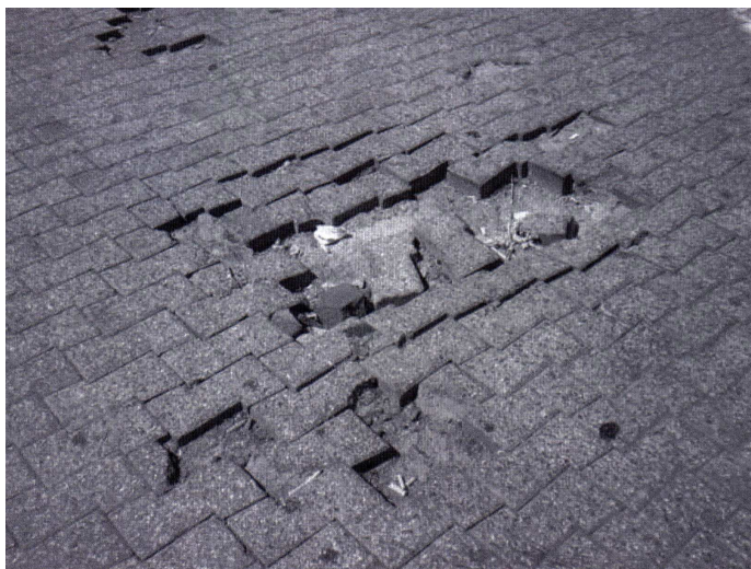
Figura 29. Falta de blocos– grau de severidade alto(Interlocking Concrete Block Pavement Distress Guide, 2007)
