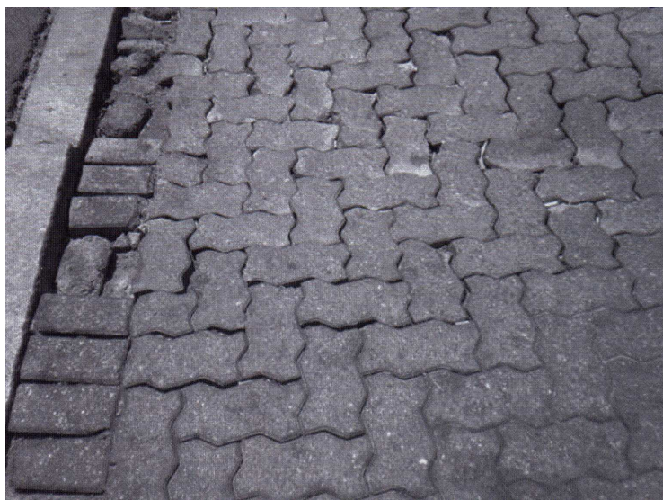
Figura 11. Contenção lateral – grau de severidade médio (Interlocking Concrete Block Pavement Distress Guide, 2007)
