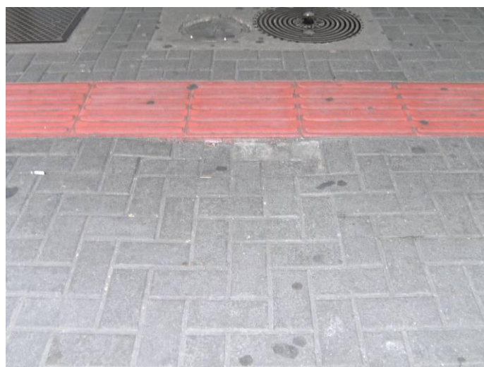
Figura 44. (Foto 60 – Q05A) Paver com desnivelamento.
