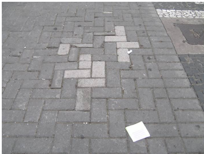
Figura 45. (Foto 53 – Q05A) Paver com desgastes superficiais.
