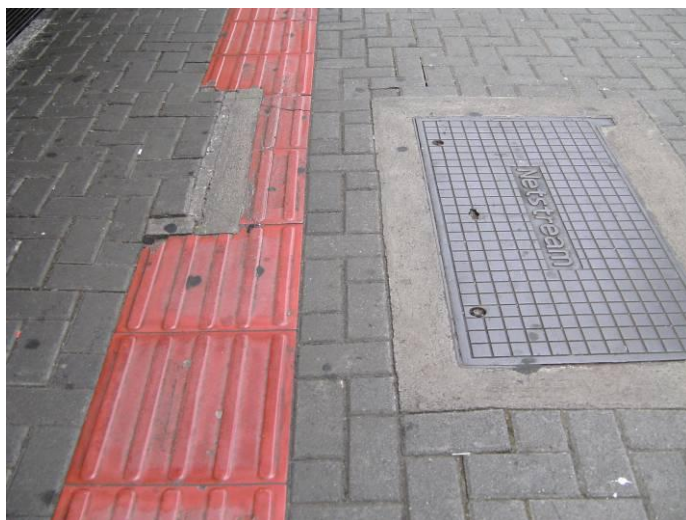
Figura 54. (Foto 52 – Q05B) Piso Tátil sem manutenção.
