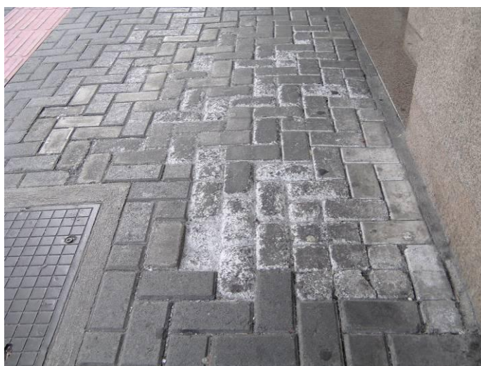
Figura 64. (Foto 23 – Q07A) Paver com desgastes superficiais.
