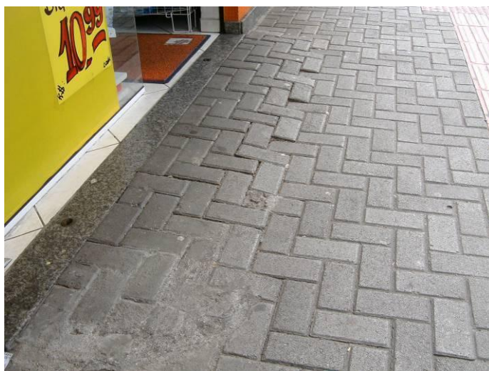
Figura 89. (Foto 84 – Q09) Paver com desnivelamento.
