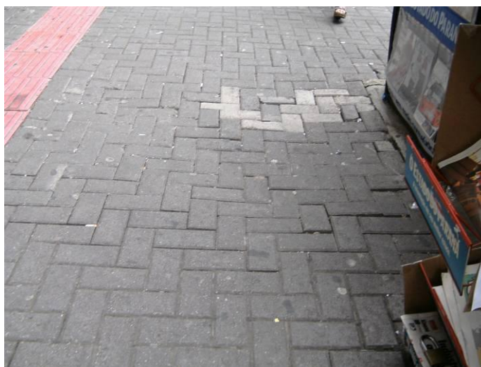
Figura 51. (Foto 44 – Q05B) Paver com desgastes superficiais.
