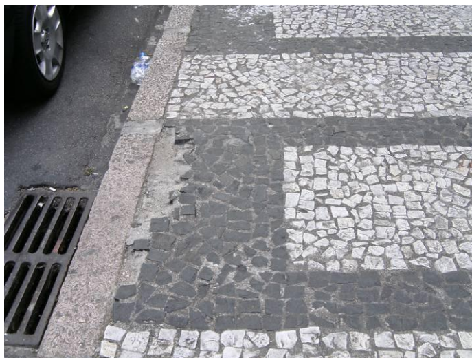
Figura 63. (Foto 21 – Q07A) Petit Pavê com colocação irregular.
