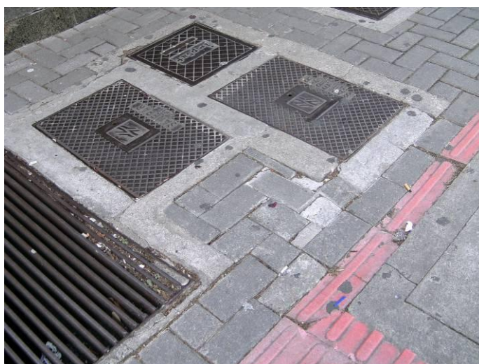
Figura 30. (Foto 40 – Q04A) Paver com desnivelamento e desgastes.
