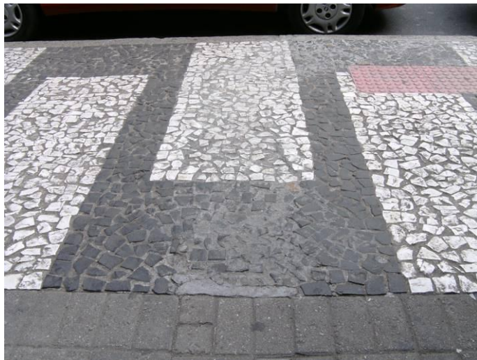
Figura 36. (Foto 66 – Q04B) Petit Pave com rejunte inadequados.
