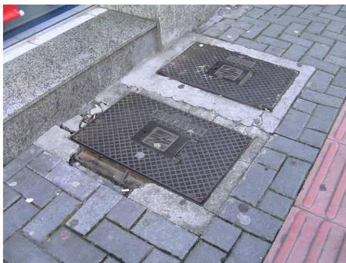
Figura 78. (Foto 108 – Q08) Tampas com trincas nas bordas.
