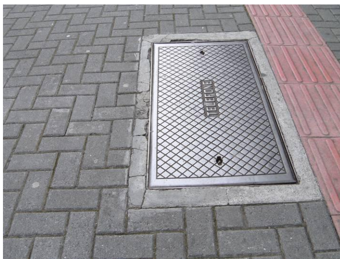
Figura 65. (Foto 25 – Q07A) Tampas com trincas nas bordas.
