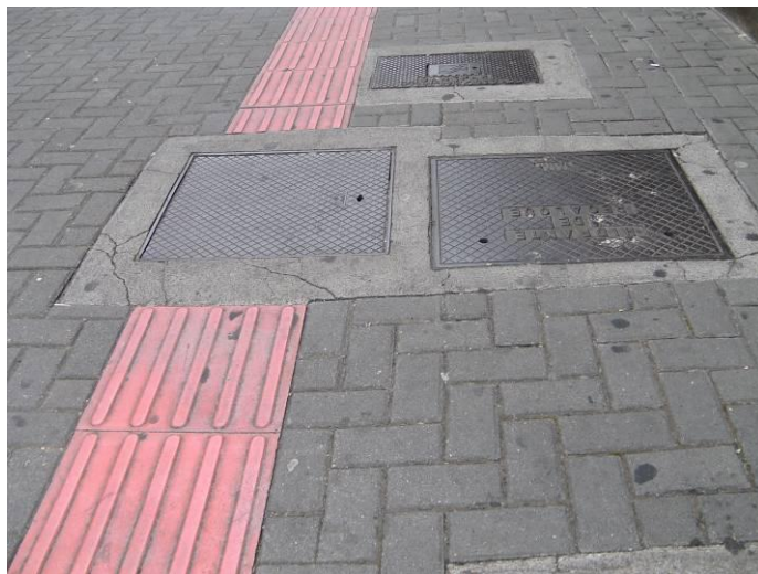
Figura 58. (Foto 38 – Q06) Tampas com trincas nas bordas.
