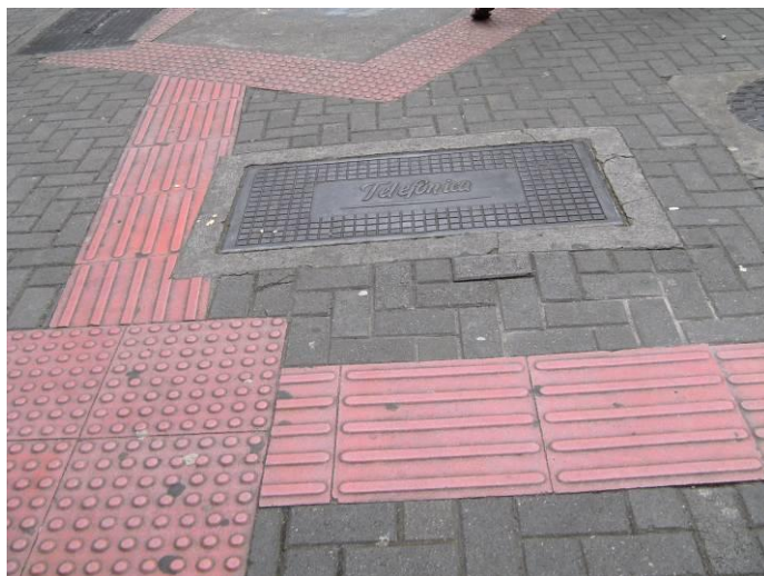
Figura 56. (Foto 39 – Q06) Tampas com trincas nas bordas.
