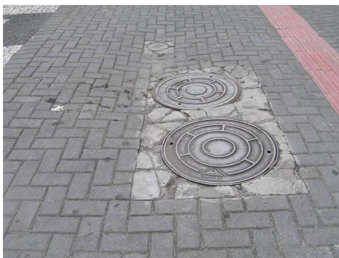
Figura 71. (Foto 15 – Q07B) Tampas com trincas nas bordas.
