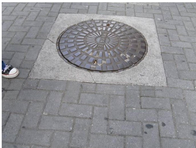
Figura 66. (Foto 26 – Q07A) Tampas com trincas nas bordas.
