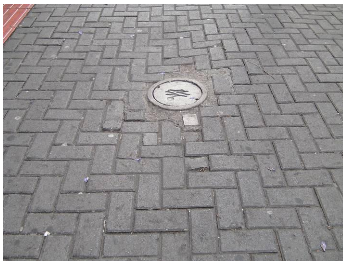
Figura 60. (Foto 34 – Q06) Paver com desnivelamento.
