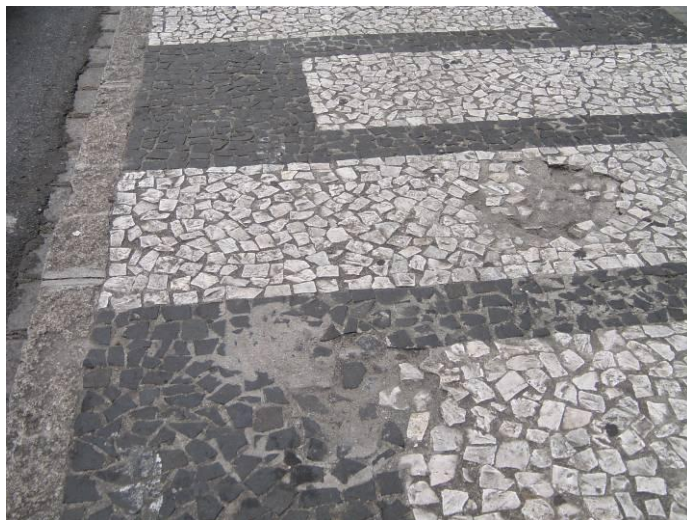
Figura 52. (Foto 49 – Q05B) Petit Pave com irregularidades e rejunte inadequados.
