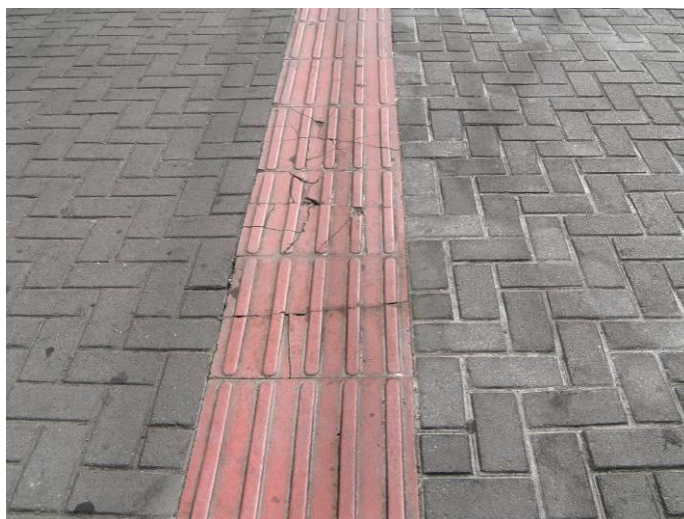
Figura 74. (Foto 05 – Q07B) Piso Tátil com trincas.
