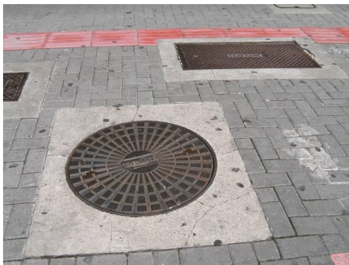
Figura 41. (Foto 60 – Q04B) Tampas com trincas nas bordas.
