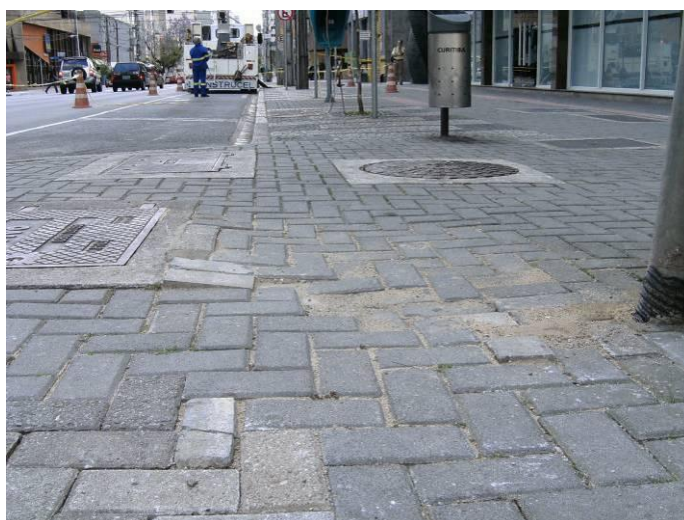
Figura 85. (Foto 79 – Q09) Paver com desnivelamento.
