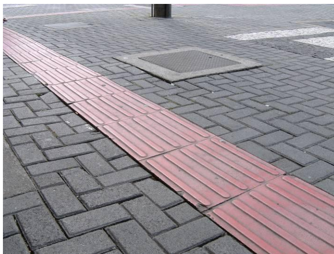
Figura 82. (Foto 100 – Q08) Paver com desnivelamento.
