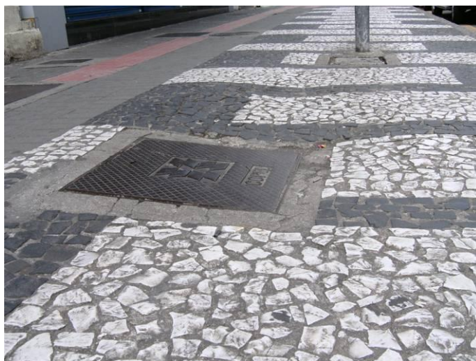
Figura 38. (Foto 71 – Q04B) Tampas com trincas nas bordas.
