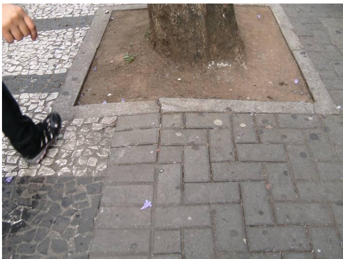
Figura 61. (Foto 35 – Q06) Paver com deformação por raízes.
