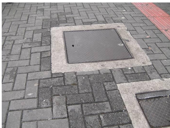
Figura 16. (Foto 73 – Q02) Paver com desgastes superficiais.
