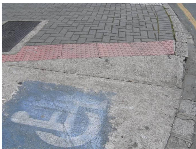
Figura 86. (Foto 80 – Q09) Piso Tátil (rampa) com trincas.
