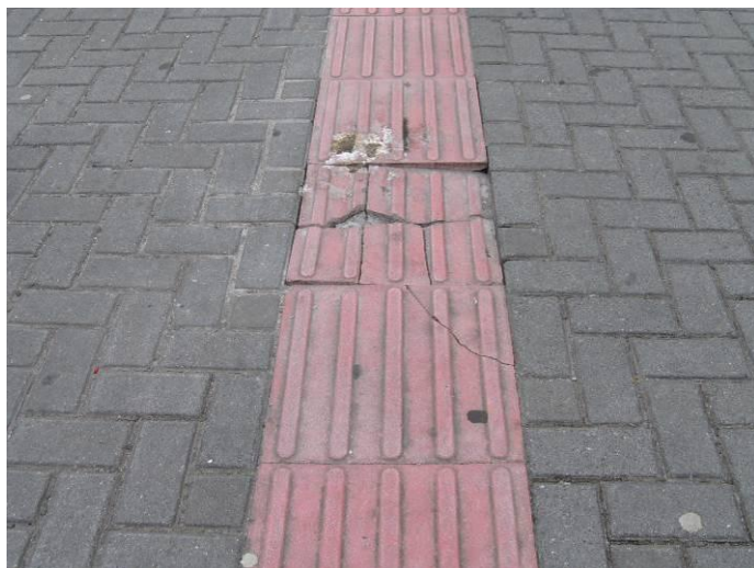
Figura 70. (Foto 13 – Q07B) Piso Tátil com trincas.
