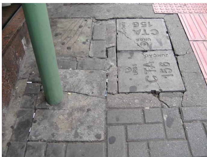
Figura 59. (Foto 30 – Q06) Tampas com trincas generalizadas.
