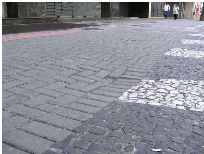
Figura 29. (Foto 38 – Q04A) Paver com desnivelamento.
