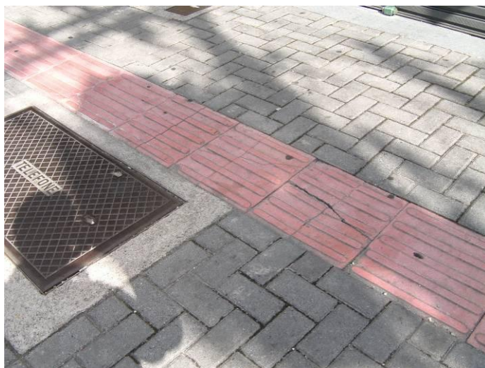
Figura 80. (Foto 91 – Q08) Piso Tátil com trincas.
