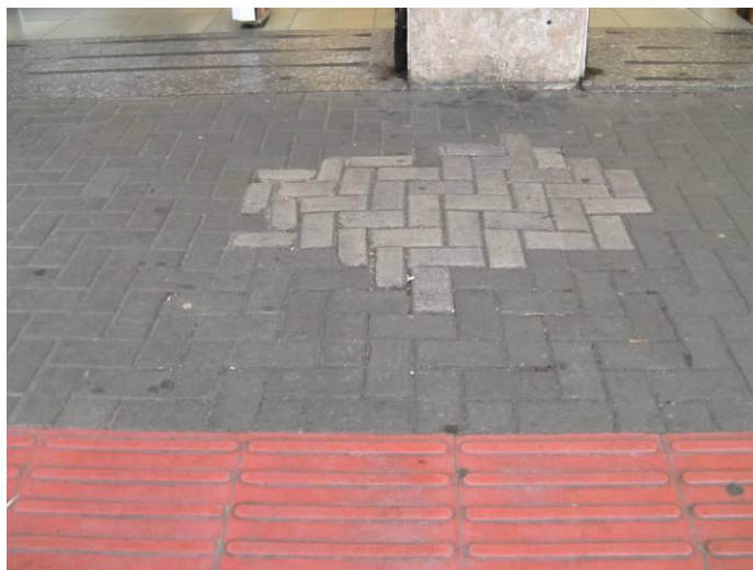
Figura 43. (Foto 58 – Q05A) Paver com desgastes superficiais.
