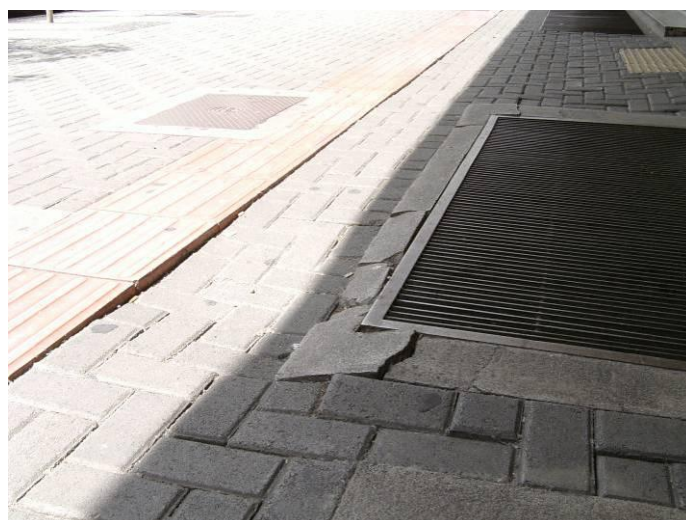
Figura 33. (Foto 47 – Q04A) Tampas com trincas nas bordas.
