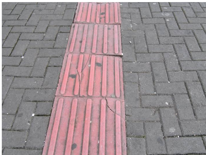
Figura 24. (Foto 18 – Q03) Piso Tátil com trincas.
