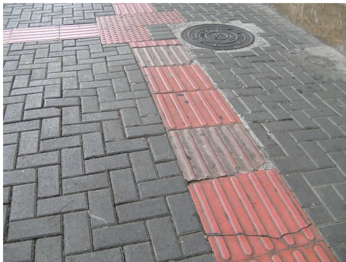
Figura 18. (Foto 63 – Q02) Piso Tátil com trincas e desgastes superficiais.
