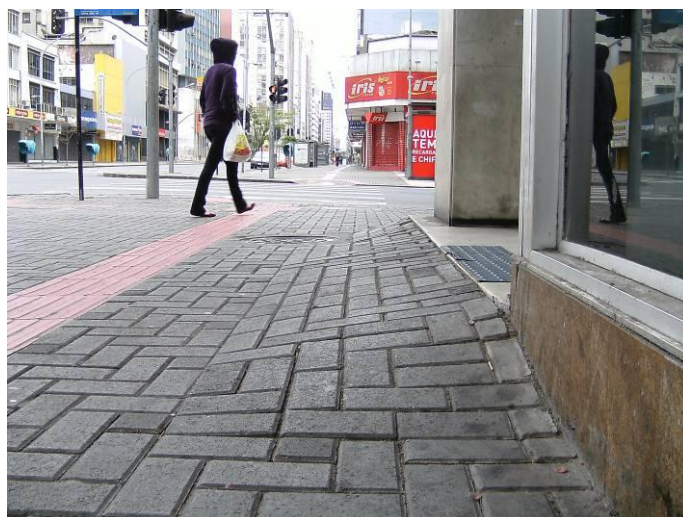
Figura 19. (Foto 66 – Q02). Paver com desnivelamento
