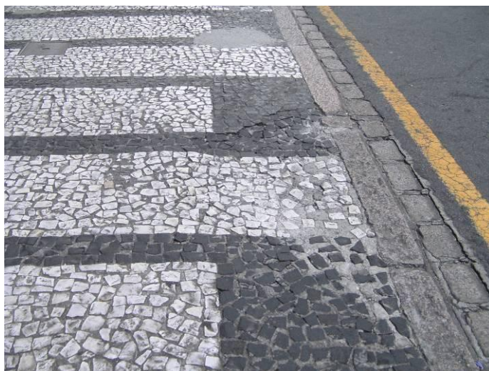
Figura 68. (Foto 28 – Q07A) Petit Pave com rejuntas inadequados.
