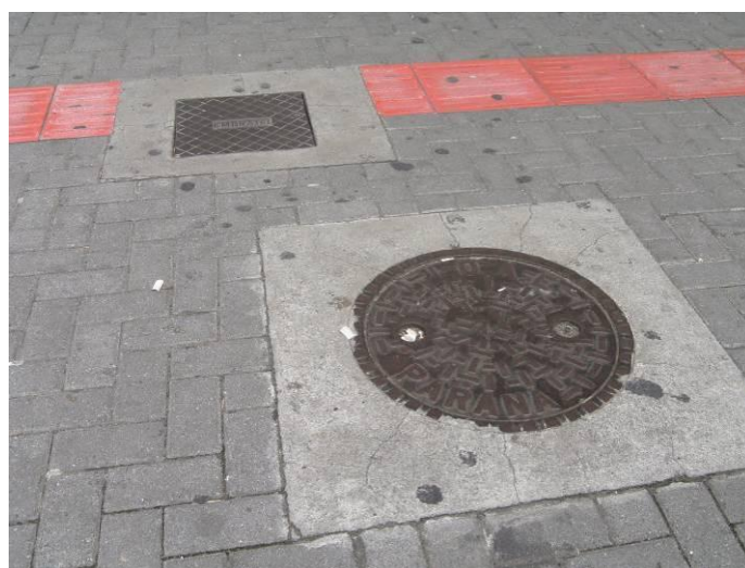
Figura 34. (Foto 52 – Q04A) Tampas com trincas nas bordas.
