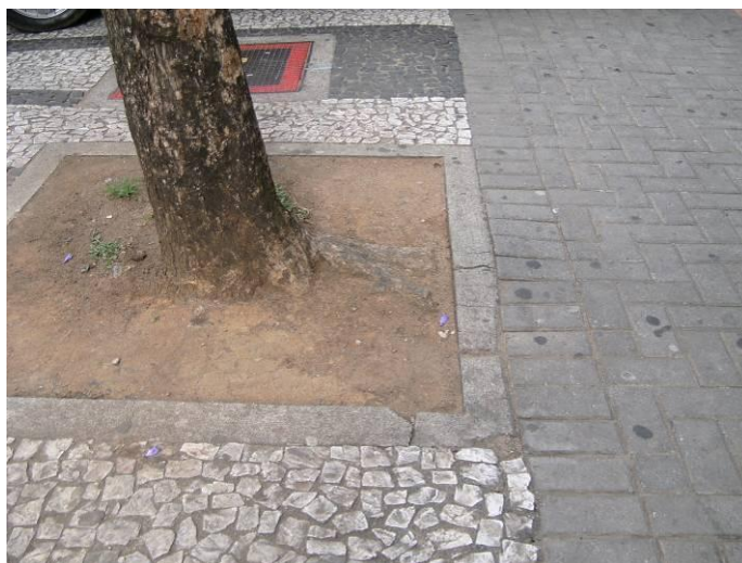
Figura 67. (Foto 27 – Q07A) Paver com deformação por raízes.
