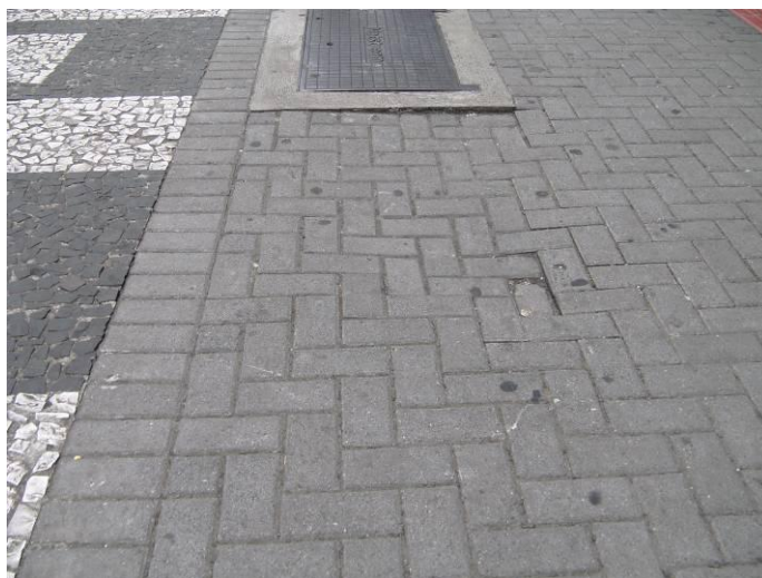
Figura 53. (Foto 50 – Q05B) Paver com desnivelamento.
