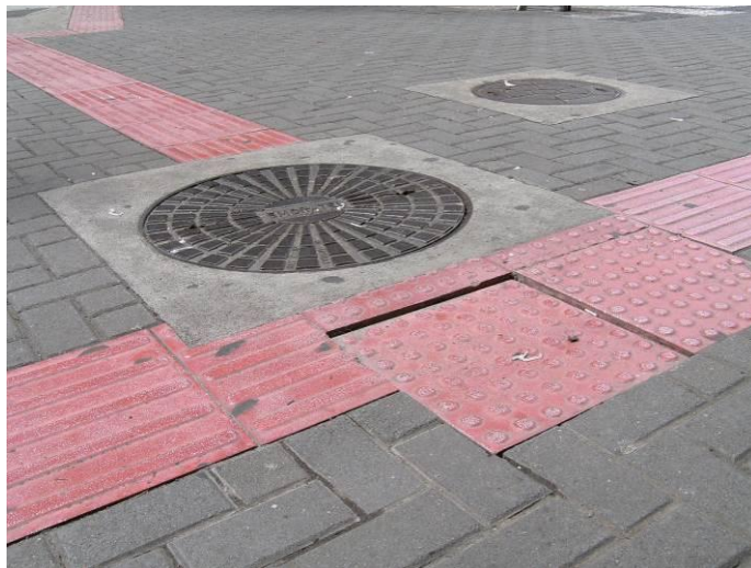
Figura 32. (Foto 42 – Q04A) Piso tátil com peça desnivelada e solta.
