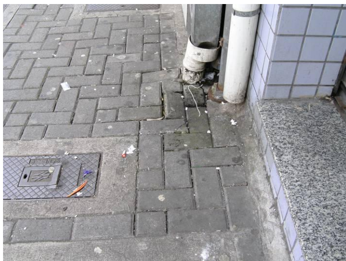
Figura 22. (Foto 23 – Q03) Paver com desnivelamento.
