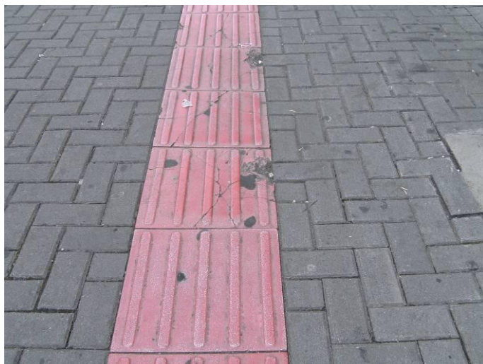
Figura 27.(Foto 13 – Q03) Piso Tátil com trincas.
