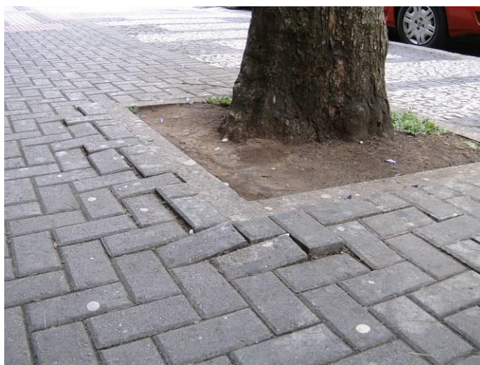
Figura 31. (Foto 41 – Q04A) Paver com deformação por raízes.
