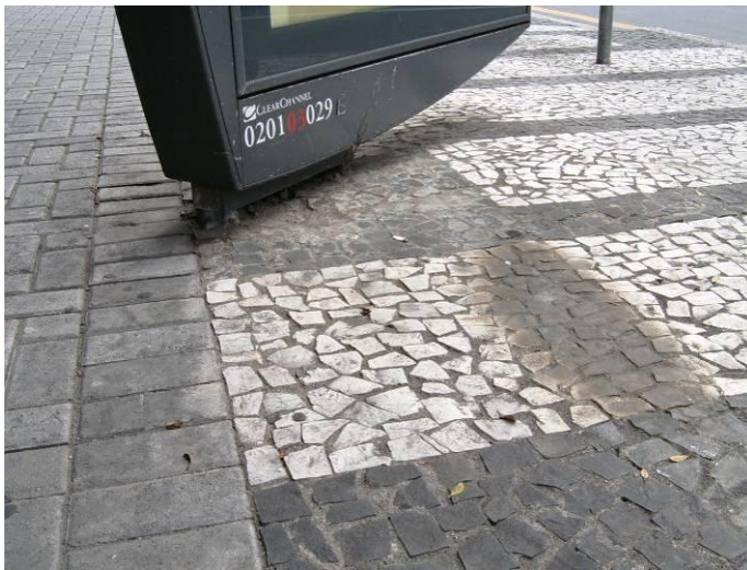
Figura 87. (Foto 82 – Q09) Petit Pave com rejuntas inadequadas.
