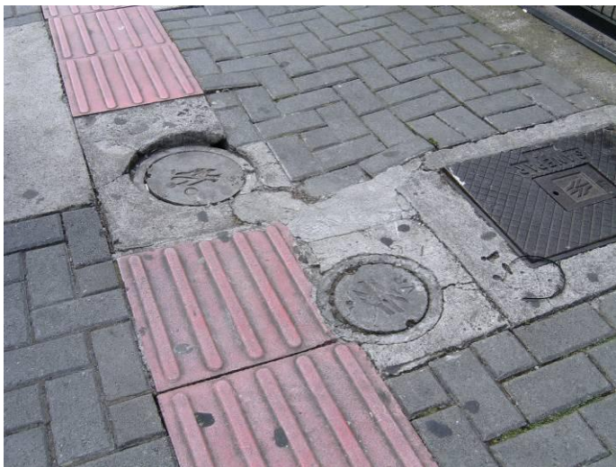
Figura 77. (Foto 104 – Q08) Tampas com trincas nas bordas.
