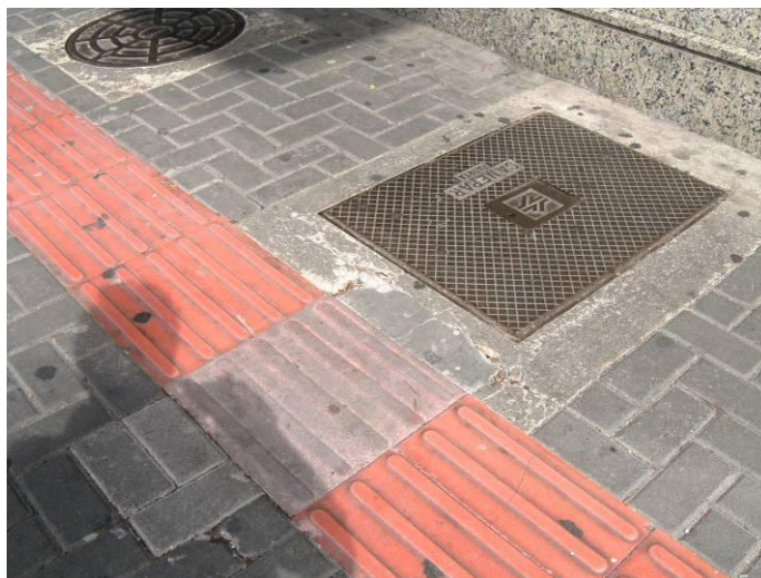
Figura 88. (Foto 83 – Q09) Tampas com trincas nas bordas.
