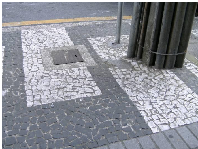
Figura 84. (Foto 76 – Q09) Petit Pave com rejuntas inadequados.
