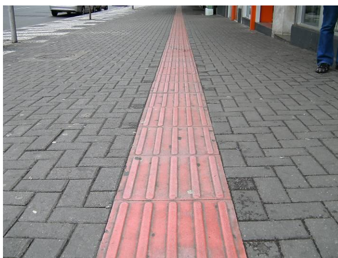
Figura 17. (Foto 78 – Q02) Paver com desgastes superficiais.
