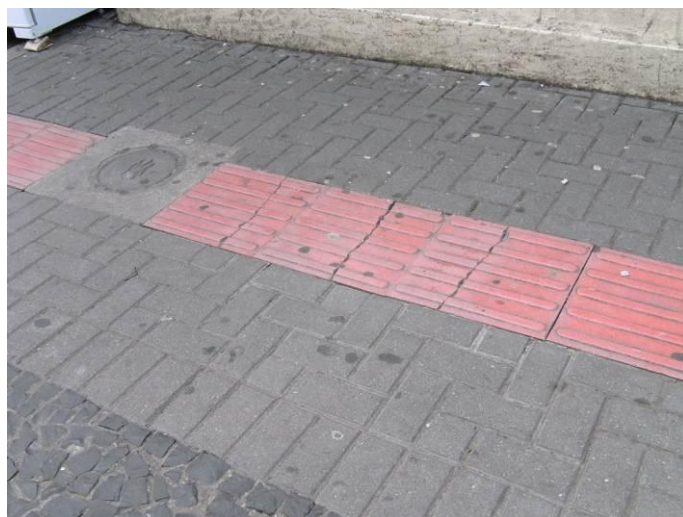
Figura 37. (Foto 70 – Q04B) Piso Tátil com trincas.
