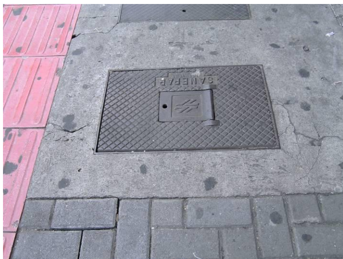
Figura 25. (Foto 09 – Q03) Tampas com trincas nas bordas.
