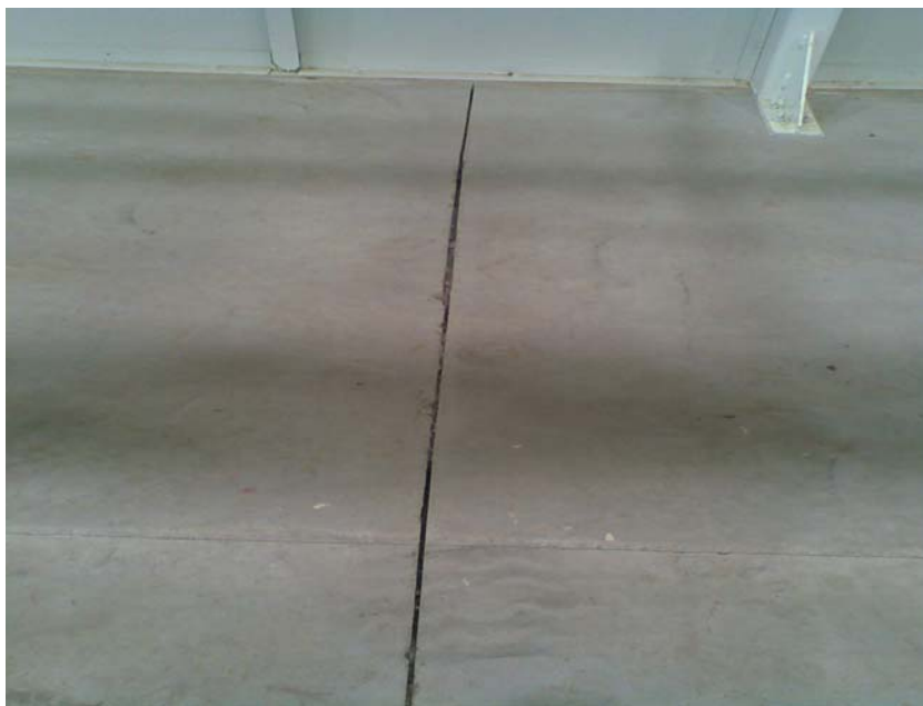
Figura 47 - Placas 21 / 22 – Longitudinal – Nov./2010.
