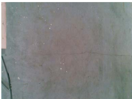
Figura 39 - Fissura localizada no trecho entre os pilares 14 e 15 – Nov./2010.
