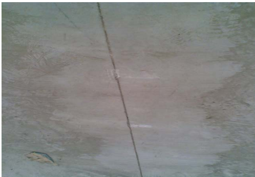
Figura 45 - Placas 8 / 9 – Longitudinal – Nov./2010.
