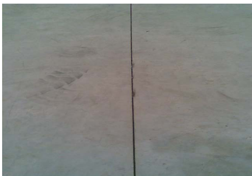
Figura 50 - Placas 33 / 34 – Longitudinal – Nov./2010.
