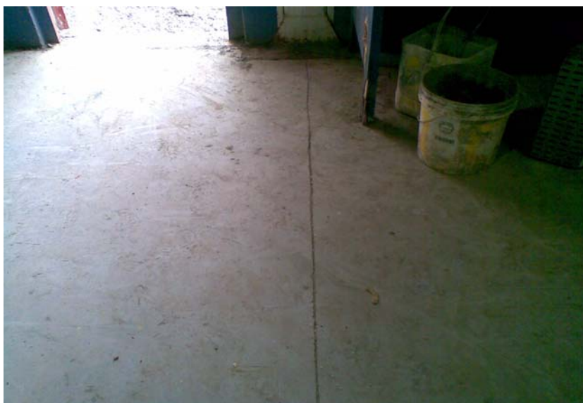
Figura 42 - Placas 2 / 3 – Longitudinal – Nov./2010.
