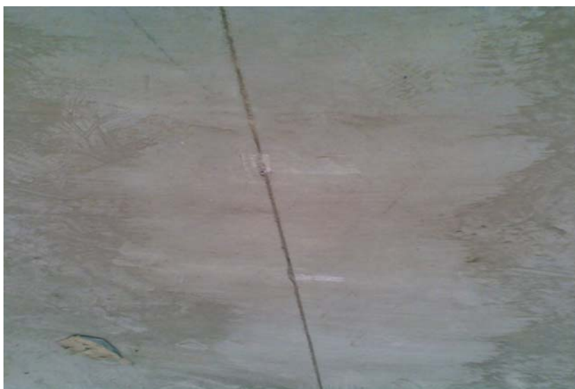
Figura 43 - Placas 3 / 4 – Longitudinal – Nov./2010.
