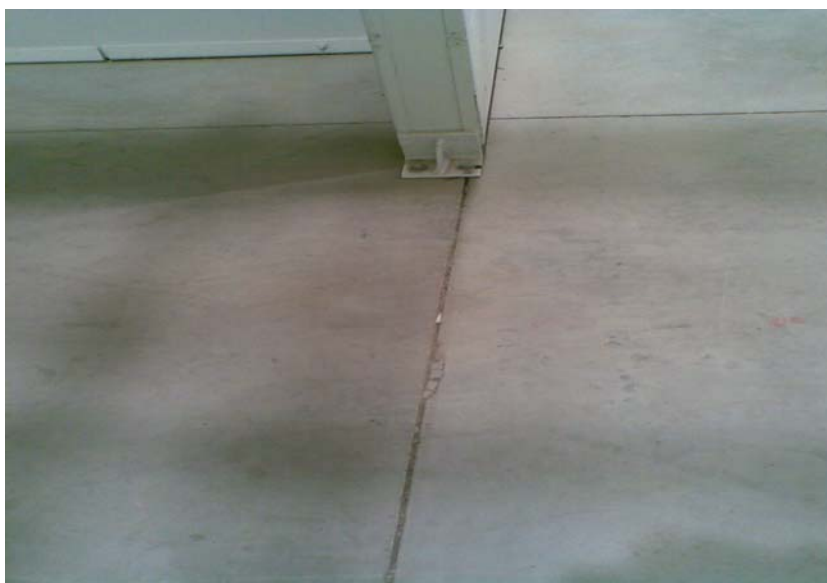
Figura 54 - Placas 45 / 46 – Longitudinal – Nov./2010.
