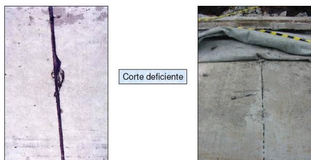
Figura 33 - Esborcinamento (Fonte: Giublin, 2010).
