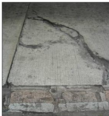
Figura 32 - Quebra de Canto (Fonte: Giublin, 2010).
