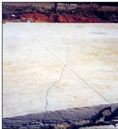
Figura 31 - Fissuras Diagonais (Fonte: Giublin, 2010).
