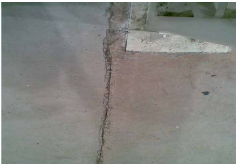
Figura 55 - Placas 50 / 51 – Longitudinal – Nov./2010.
