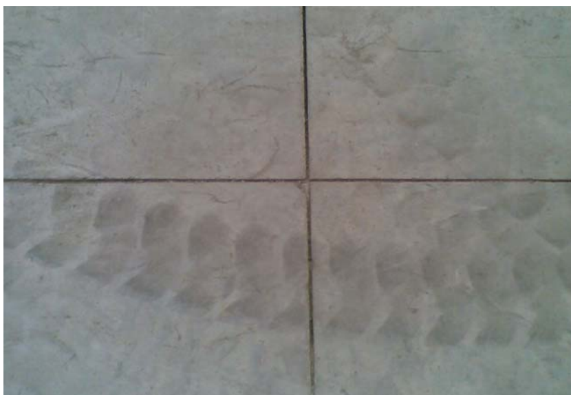
Figura 53 - Placas 41 / 42 – Longitudinal – Nov./2010.
