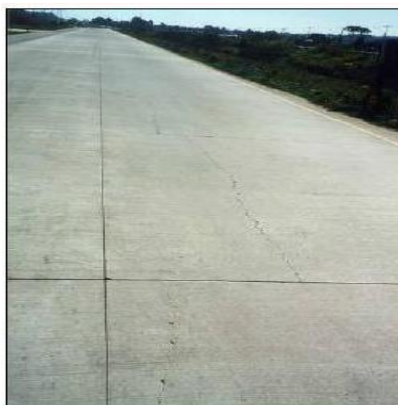
Figura 30 - Fissura Longitudinal (Fonte: Giublin, 2010).
