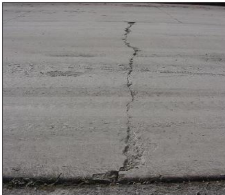
Figura 29 - Fissura Transversal (Fonte: Giublin, 2010).
