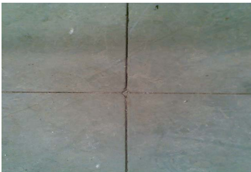
Figura 44 - Placas 4 / 5 – Longitudinal – Nov./2010.
