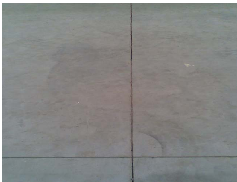
Figura 49 - Placas 28 / 29 – Longitudinal – Nov./2010.
