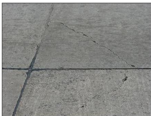
Figura 27 - Fissura de Canto (Fonte: Giublin, 2010).
