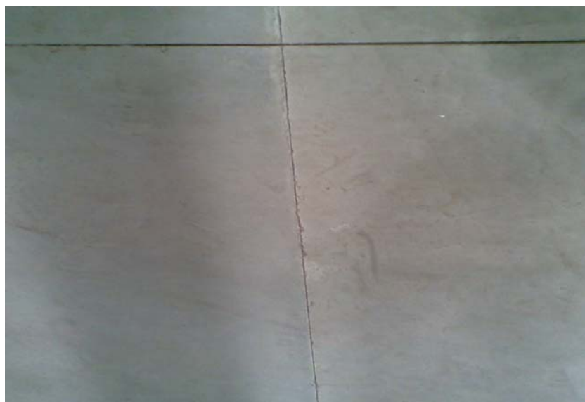
Figura 48 - Placas 26 / 27 – Longitudinal – Nov./2010.
