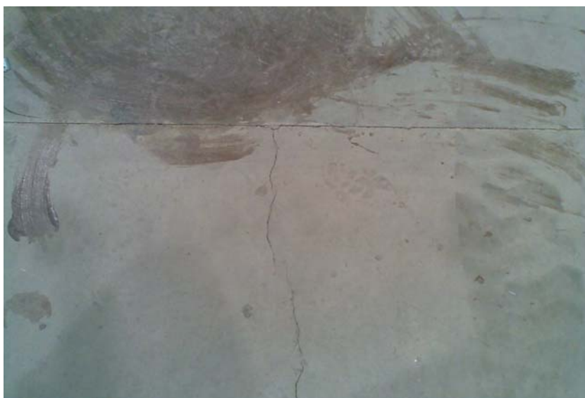
Figura 56 - Placas 53 – Longitudinal – Nov./2010.
