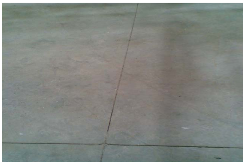
Figura 41 - Placas 1 / 2 – Longitudinal – Nov./2010.
