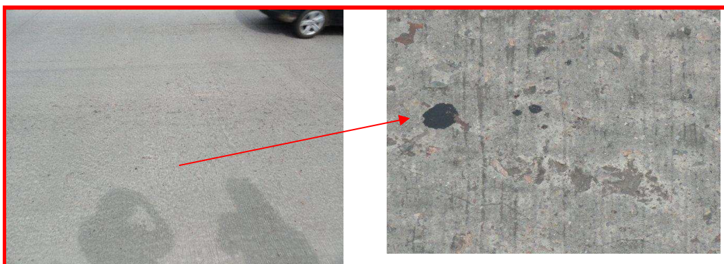
Figura 35 - Desgaste Superficial na placa 381B - Pista 2
