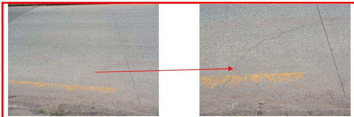
Figura 29 - Fissura de canto na placa 3A
