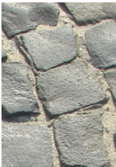
FIGURA 3.2 – Desgaste Superficial. Foto do autor.
