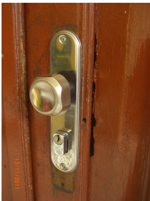
Figura 9 - Ponto de apodrecimento encontrado comumente próximo às maçanetas
