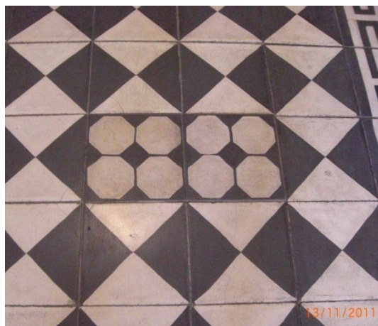
Figura 30 - Peças de ladrilho hidráulico inseridas num contexto diferente do original (corredor – 2º pavimento)
