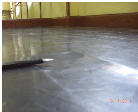
Figura 26 – Tábuas de piso de madeira deformadas em Sala 4 (1º pavimento)
