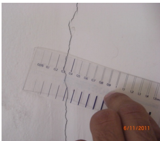
Figura 13 - Fissura identificada em parede da Sala 2 (2º pavimento)
