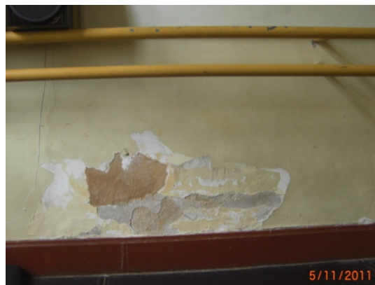
Figura 24 – Desplacamento de revestimento em parede da Sala 2 (2º pavimento)
