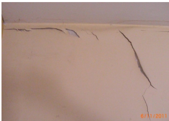
Figura 23 – Descascamento de pintura em parede da Sala 5 (1º pavimento)
