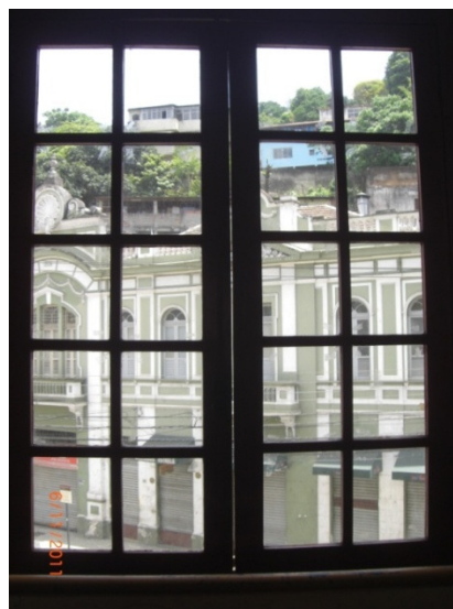
Figura 12 - Janela com bandeiras desalinhadas na Sala 1 (2º pavimento)
