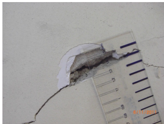
Figura 16 - Detalhe de trinca em parede e verificação de espessura com fissurômetro
