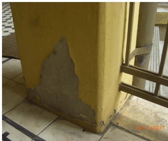
Figura 20 – Descascamento de pintura em pilar (1º pavimento)
