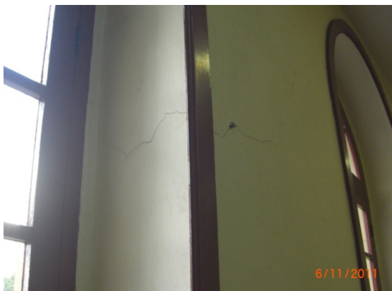
Figura 15 - Trinca em parede da Sala 4 (1º pavimento)
