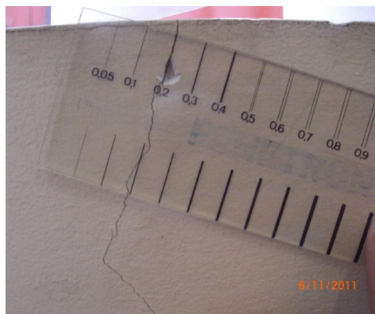
Figura 14 - Fissura identificada abaixo de janela
