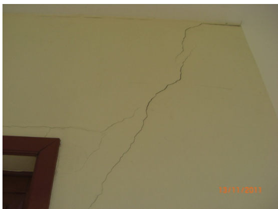
Figura 17 – Trincas junto à porta e próxima ao teto
