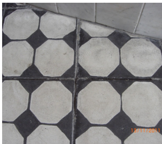
Figura 28 – Deficiência de rejuntamento em ladrilho hidráulico do corredor (2º pavimento)
