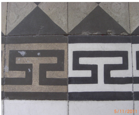
Figura 29 - Peças de ladrilho hidráulico antigas desgastadas e réplica de peças originais (camarim – 2º pavimento)
