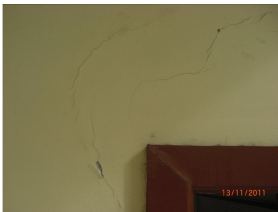
Figura 18 - Trincas junto à porta
