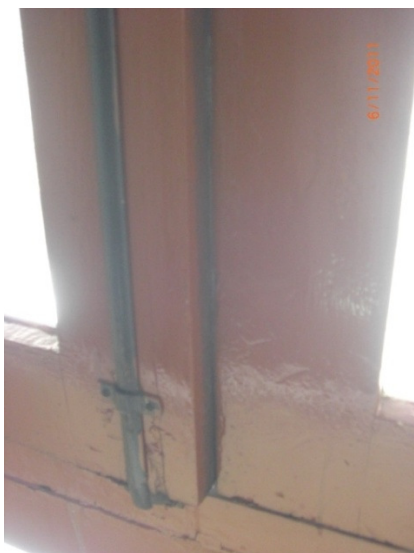
Figura 11 - Janela do Centro de Documentação apresentando empenamento
