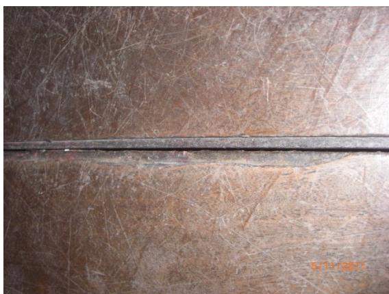
Figura 25 – Peça lascada na Coordenação (2º pavimento)
