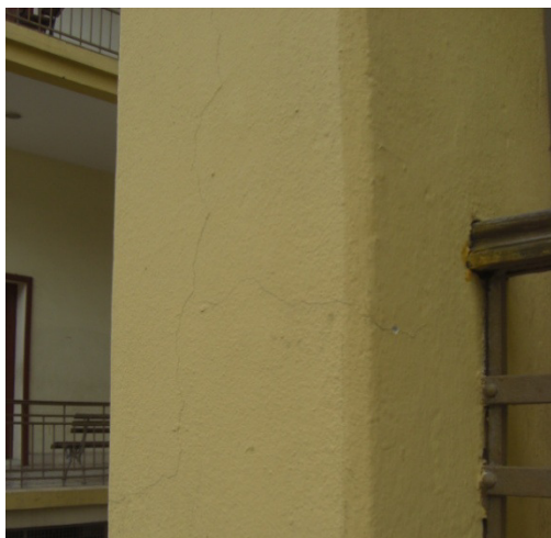
Figura 19 – Fissura em pilar (1º pavimento)
