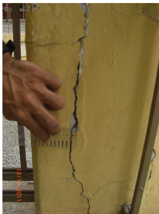
Figura 22 – Detalhe de trinca observada em pilar (1º pavimento)
