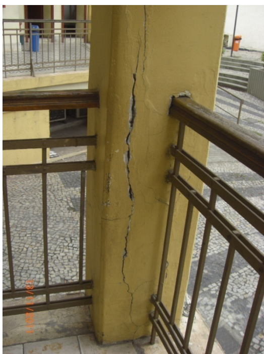
Figura 21 – Trinca observada em pilar (1º pavimento)
