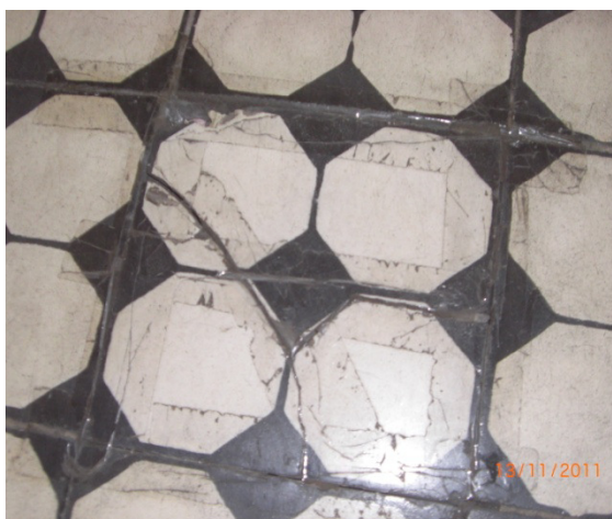
Figura 27 – Peça de ladrilho hidráulico solta e quebrada em corredor (2º pavimento)
