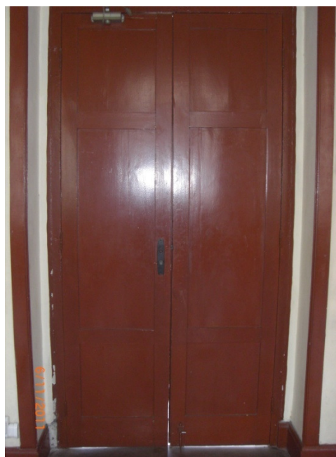
Figura 10 - Bandeira desalinhada de porta da Sala 1 (2º pavimento)
