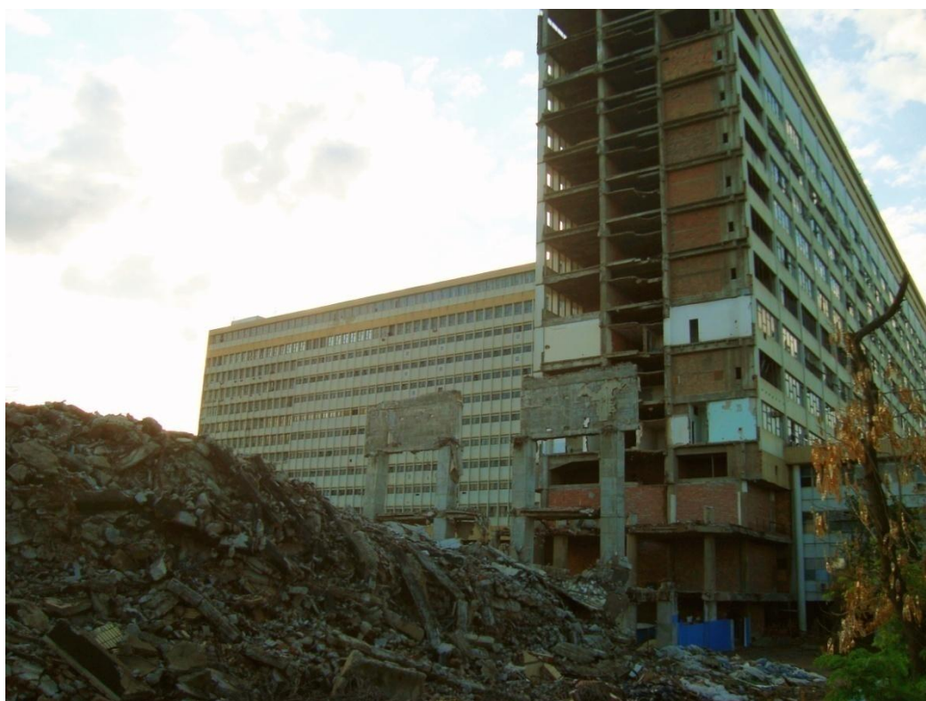
Figura 1.1. Hospital Universitário Clementino Fraga Filho (RJ) após implosão de um trecho, devido à problemas estruturais.
