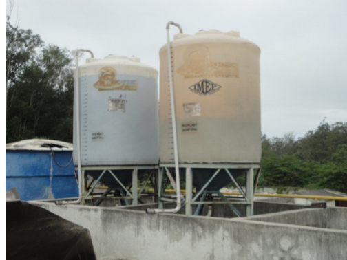
Figura 9 - Tanque de armazenamento de aditivo
